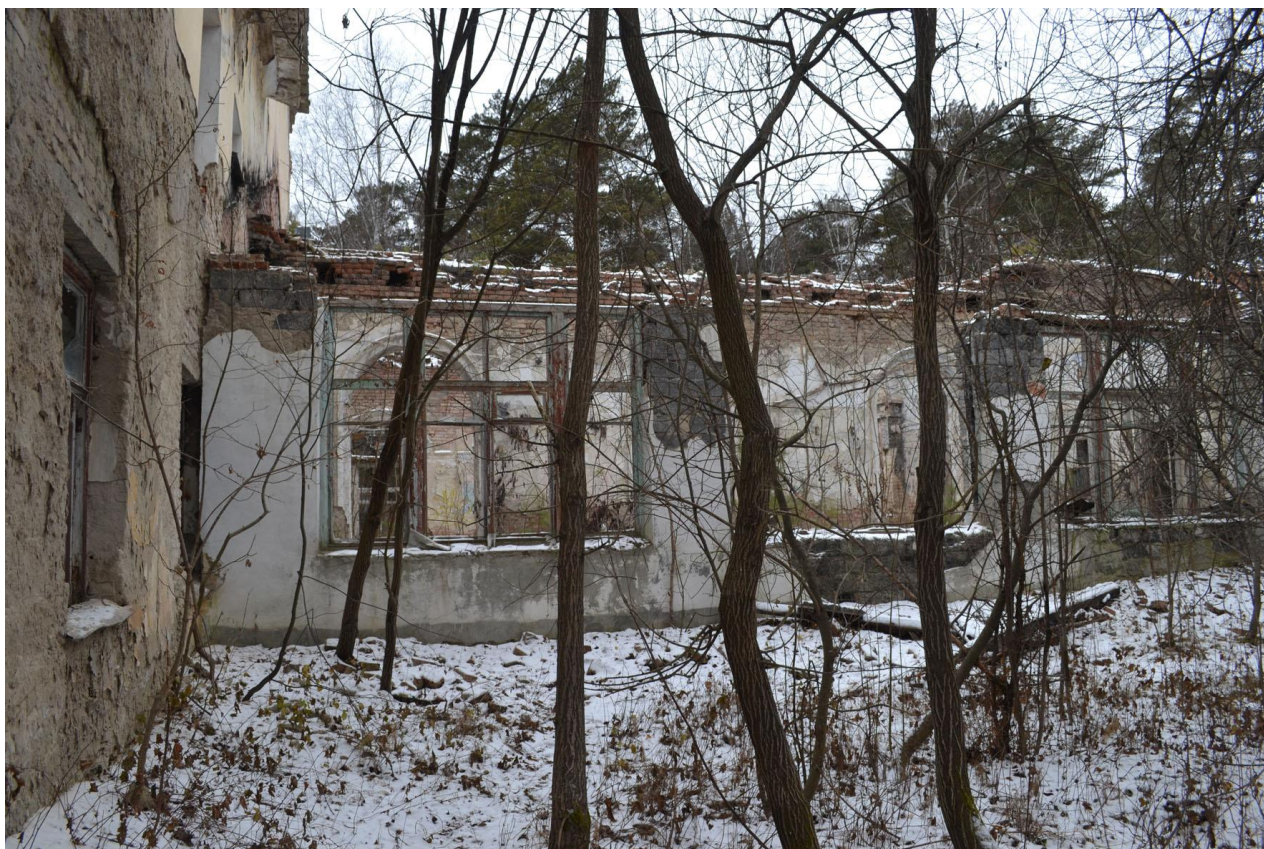
32. Вид и состояние фрагмента северо-западного фасада основного объёма и северо-восточного фасада примыкающего объёма. Ноябрь 2024 г.
