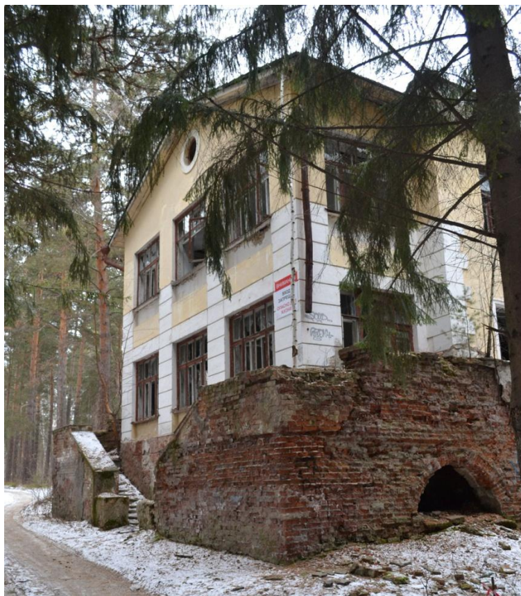
8. Вид и состояние юго-западного и фрагмента юго-восточного фасадов основного объёма. Ноябрь 2024 г.
