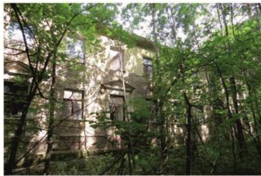
Илл. 93 – Главный фасад, северо-восточное крыло. Фото Скиданенко Е. Н., 04.07.2024 г. Архив ГАУ НСО НПЦ
