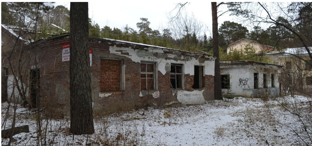
19. Вид и состояние фрагмента северо-западного фасада и пристроенных объёмов к юго-западному фасаду примыкающего объёма. Ноябрь 2024 г.
