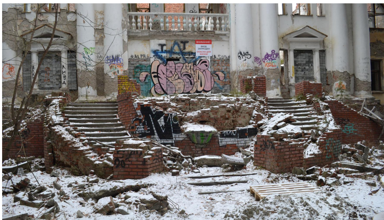
5. Вид и состояние парадной лестницы центральной части юго-восточного фасада основного объёма. Ноябрь 2024 г.
