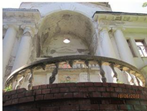
Илл. 75 – Первый корпус санатория «Речкуновский». Ограждение балюстрады. Фото 2018 г. Источник: архив ГАУ НСО НПЦ
