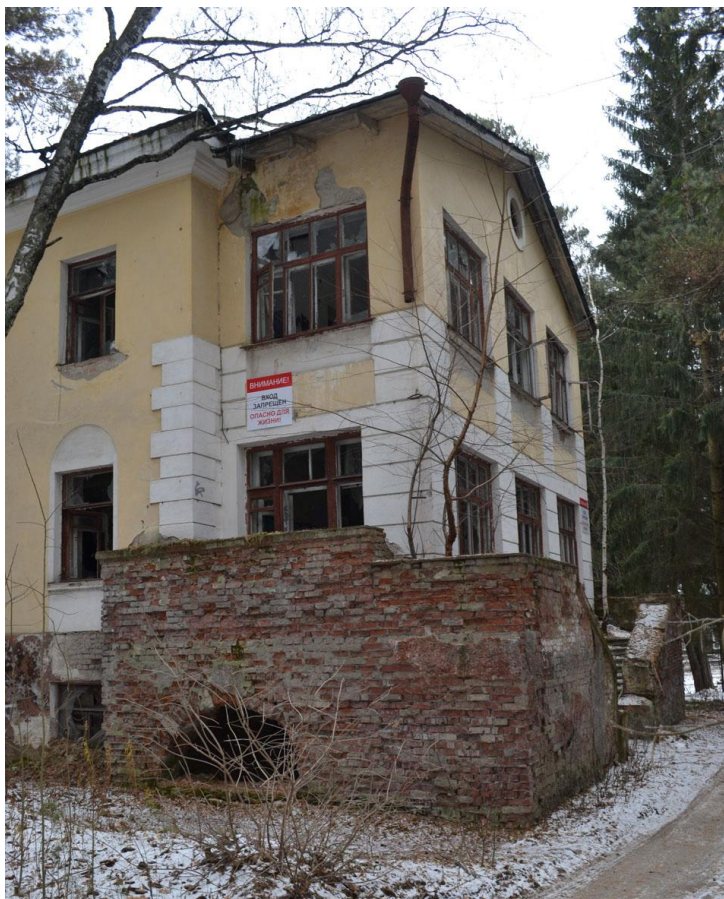
11. Вид и состояние фрагмента северо-западного и юго-западного фасадов основного объёма. Ноябрь 2024 г.
