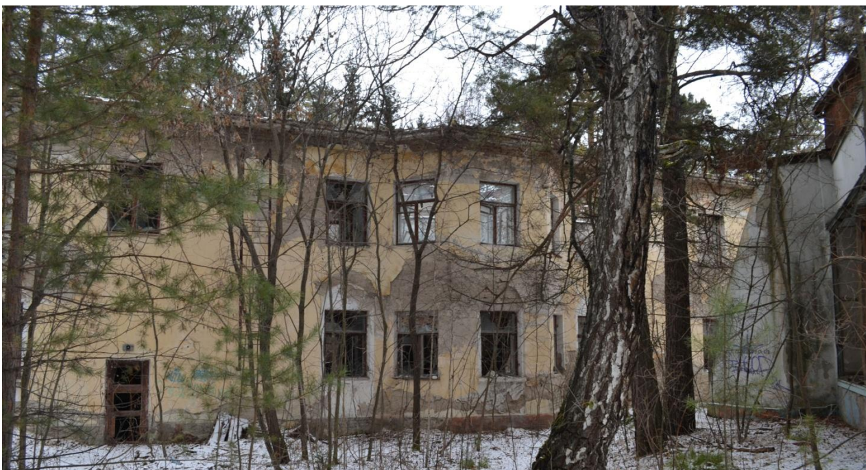
39. Вид и состояние фрагмента северо-западного фасада основного объёма. Ноябрь 2024 г.
