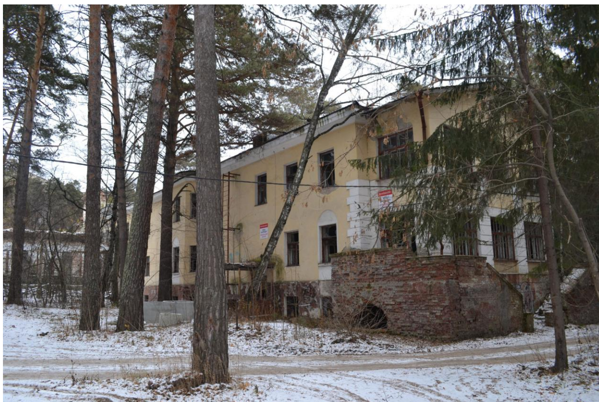
12. Вид и состояние правой части северо-западного и юго-западного фасадов основного объёма. Ноябрь 2024 г.
