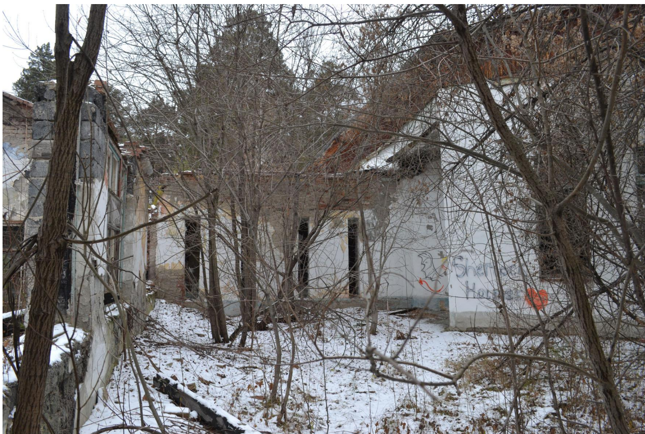
33. Вид и состояние фрагмента северо-восточного фасада примыкающего объёма и юго-восточный фасад перехода и тамбура. Ноябрь 2024 г.
