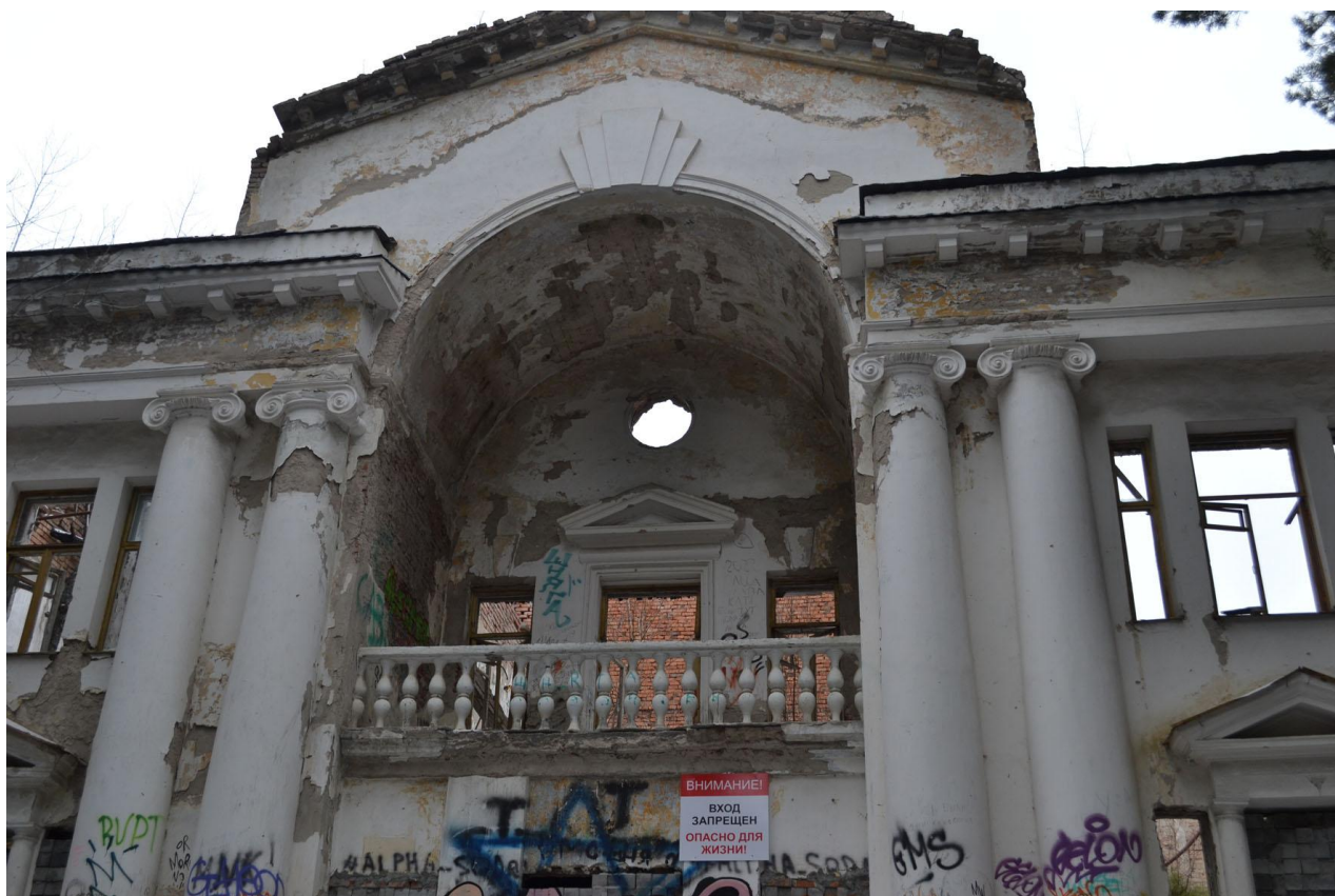
2. Вид и состояние фрагмента ризалита центральной части юго-восточного фасада основного объёма. Ноябрь 2024 г.
