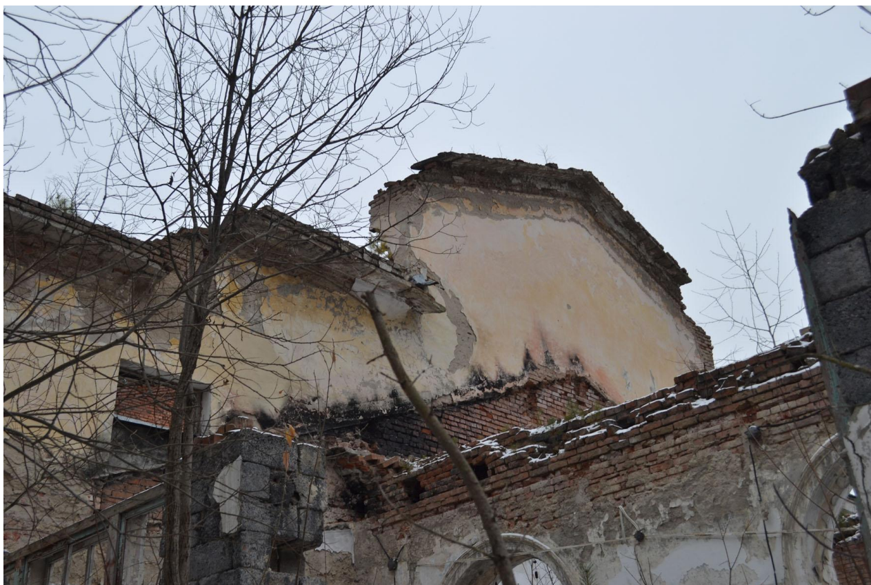
35. Вид и состояние центральной части северо-западного фасада основного объёма. Ноябрь 2024 г.
