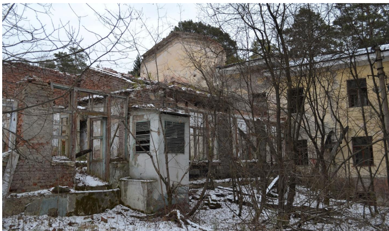
16. Вид и состояние юго-западного фасада примыкающего объёма к центральной части северо-западного фасада. Ноябрь 2024 г.
