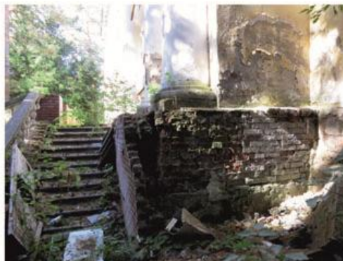
Илл. 55 – Первый корпус санатория «Речкуновский». Фрагмент лестницы. Фото 2016 г. Источник: архив ГАУ НСО НПЦ
