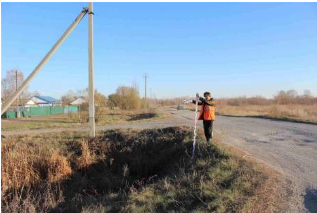
Рисунок 217 – «Распределительный газопровод р.п. Чистоозерное». Вид из точки 69 в направлении точки 194. Снято с СЗ.
