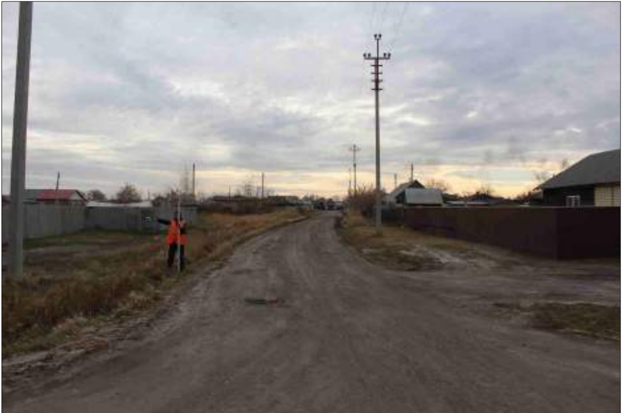
Рисунок 343 – «Распределительный газопровод р.п. Чистоозерное». Вид из точки 16 в направлении точки 17. Снято с СЗ.
