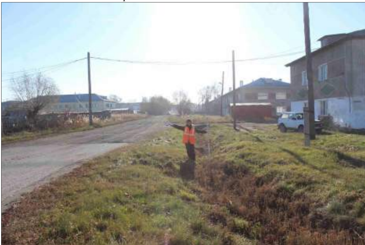
Рисунок 52 – «Распределительный газопровод р.п. Чистоозерное». Вид из точки 160 в направлении точки 161. Снято с СЗ.
