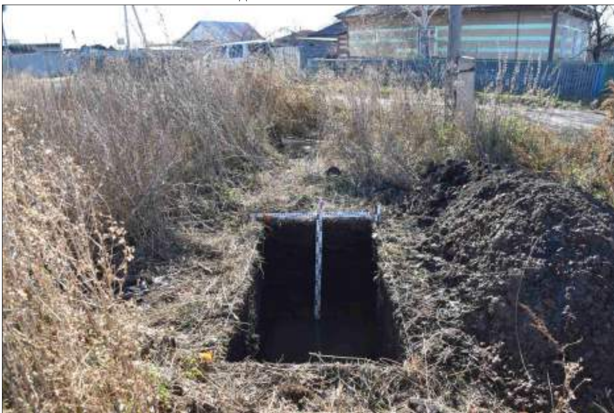
Рисунок 570 – «Распределительный газопровод р.п. Чистоозерное». Шурф №41. Общий вид выполненного шурфа. Снято с С.
