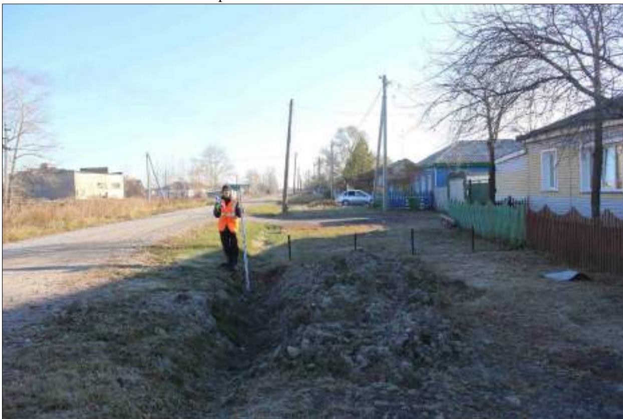
Рисунок 40 – «Распределительный газопровод р.п. Чистоозерное». Вид из точки 174 в направлении точки 173. Снято с ЮЗ.
