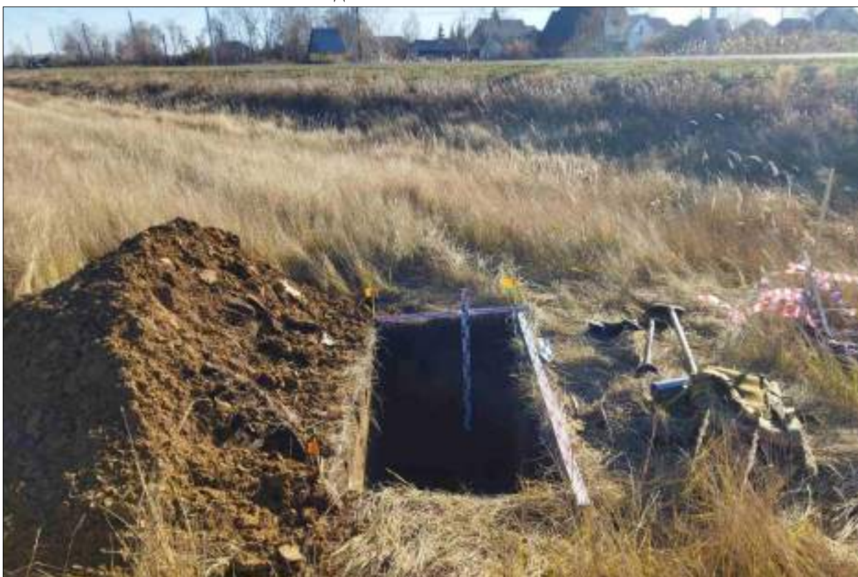
Рисунок 510 – «Распределительный газопровод р.п. Чистоозерное». Шурф №29. Общий вид выполненного шурфа. Снято с С.
