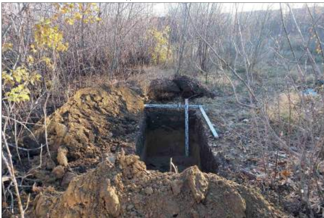
Рисунок 560 – «Распределительный газопровод р.п. Чистоозерное». Шурф №39. Общий вид выполненного шурфа. Снято с С.
