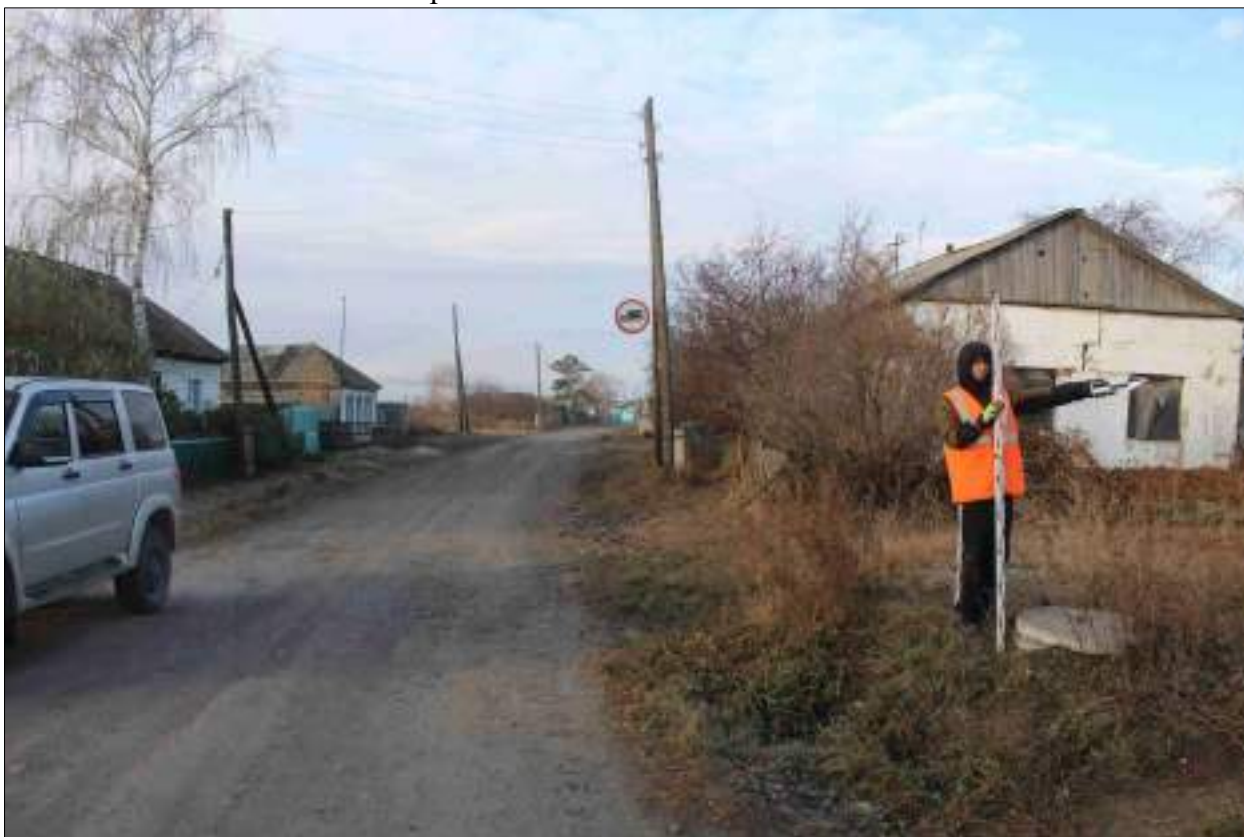
Рисунок 268 – «Распределительный газопровод р.п. Чистоозерное». Вид из точки 32 в направлении точки 33. Снято с СВ.
