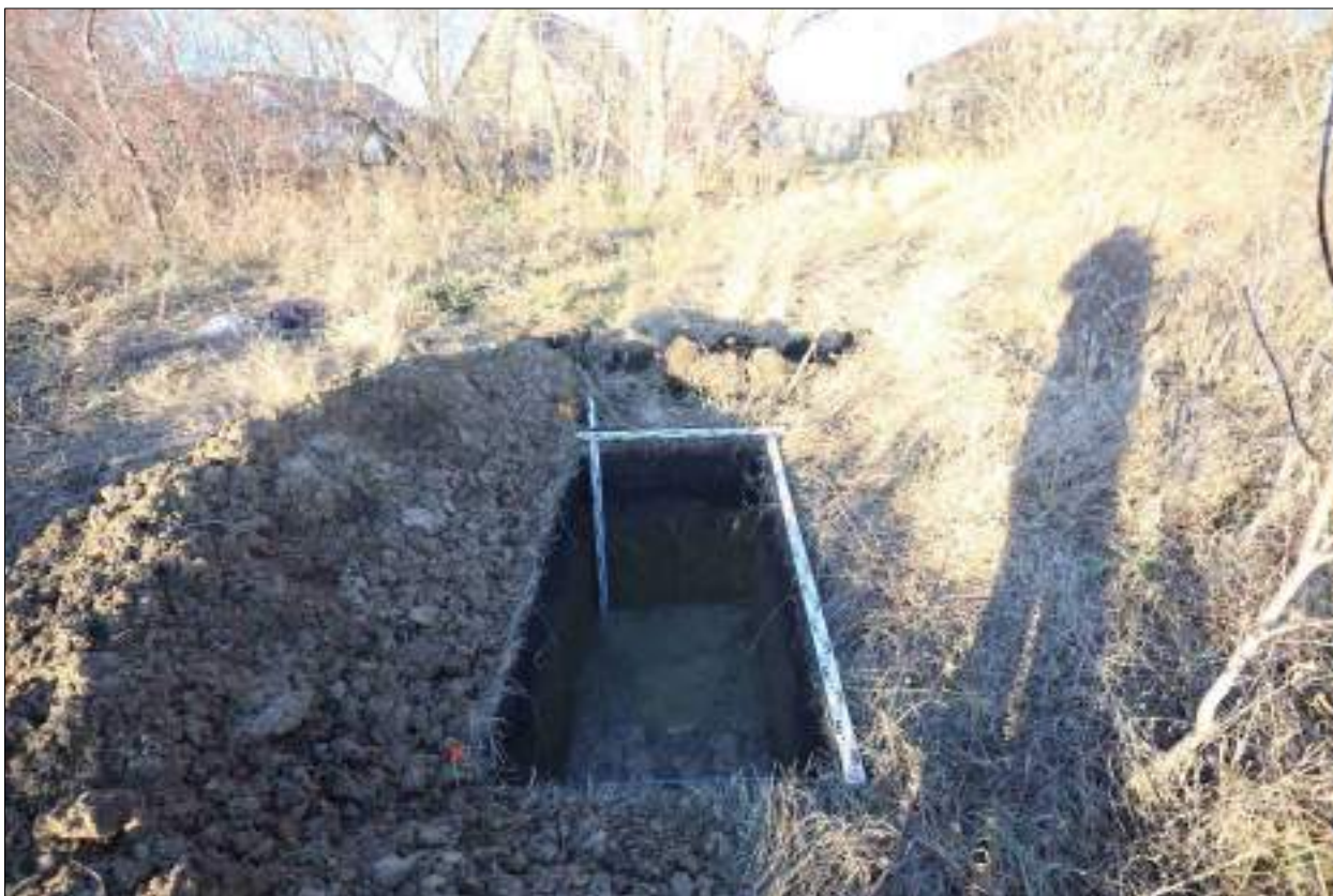
Рисунок 555 – «Распределительный газопровод р.п. Чистоозерное». Шурф №38. Общий вид выполненного шурфа. Снято с Ю.
