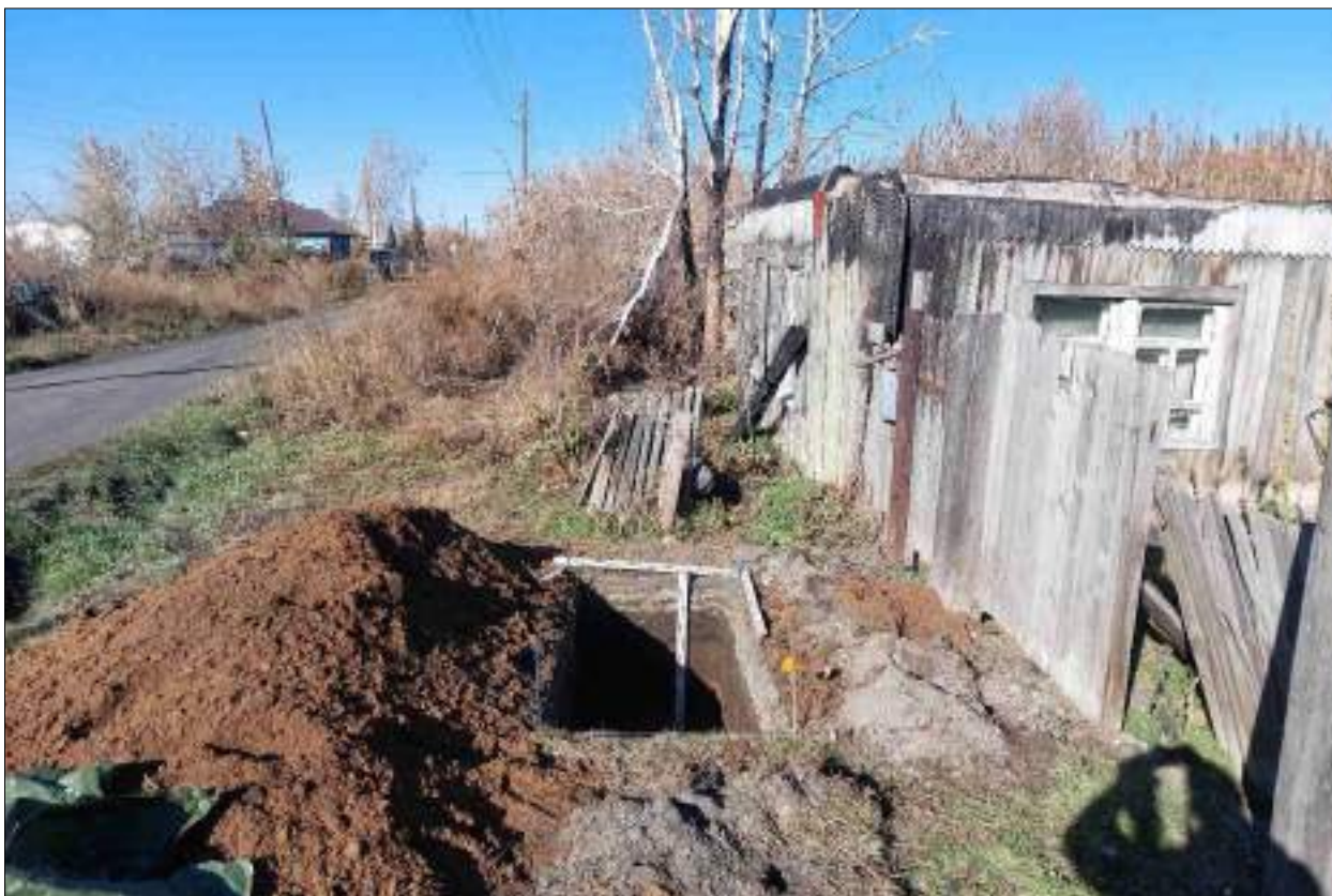
Рисунок 631 – «Распределительный газопровод р.п. Чистоозерное». Шурф №53. Общий вид выполненного шурфа. Снято с ЮВ.
