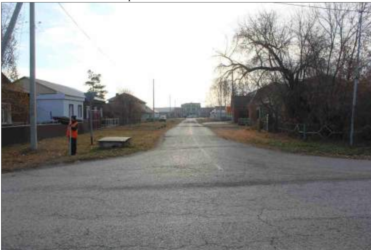
Рисунок 296 – «Распределительный газопровод р.п. Чистоозерное». Вид из точки 50 в направлении точки 49. Снято с СЗ.
