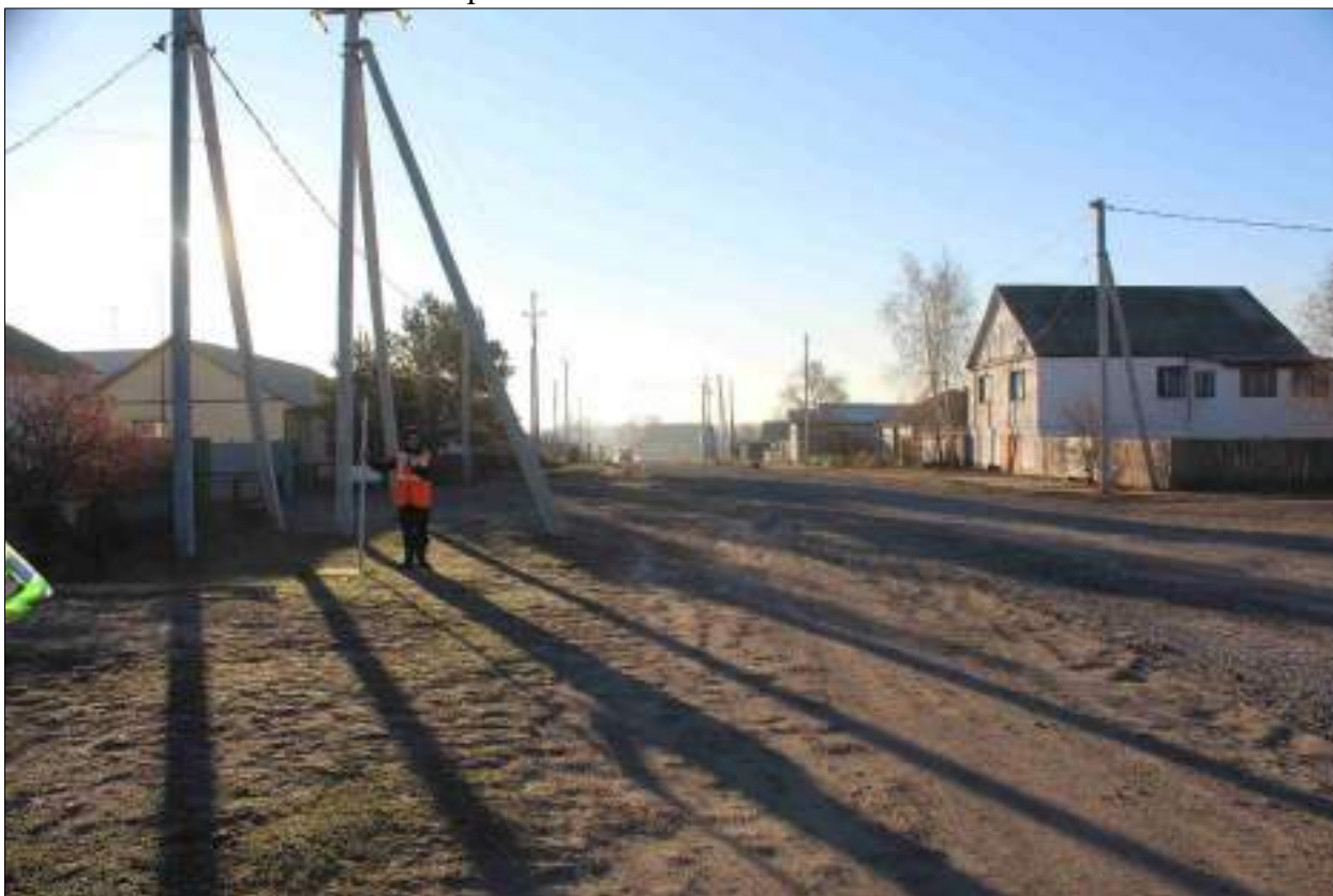
Рисунок 24 – «Распределительный газопровод р.п. Чистоозерное». Вид из точки 185 в направлении точки 184. Снято с СЗ.
