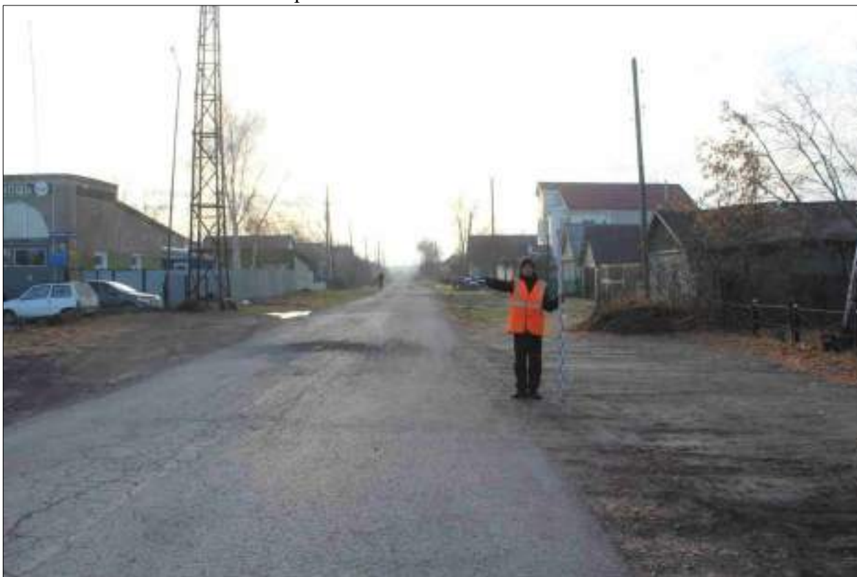
Рисунок 282 – «Распределительный газопровод р.п. Чистоозерное». Вид из точки 47 в направлении точки 41. Снято с СЗ.
