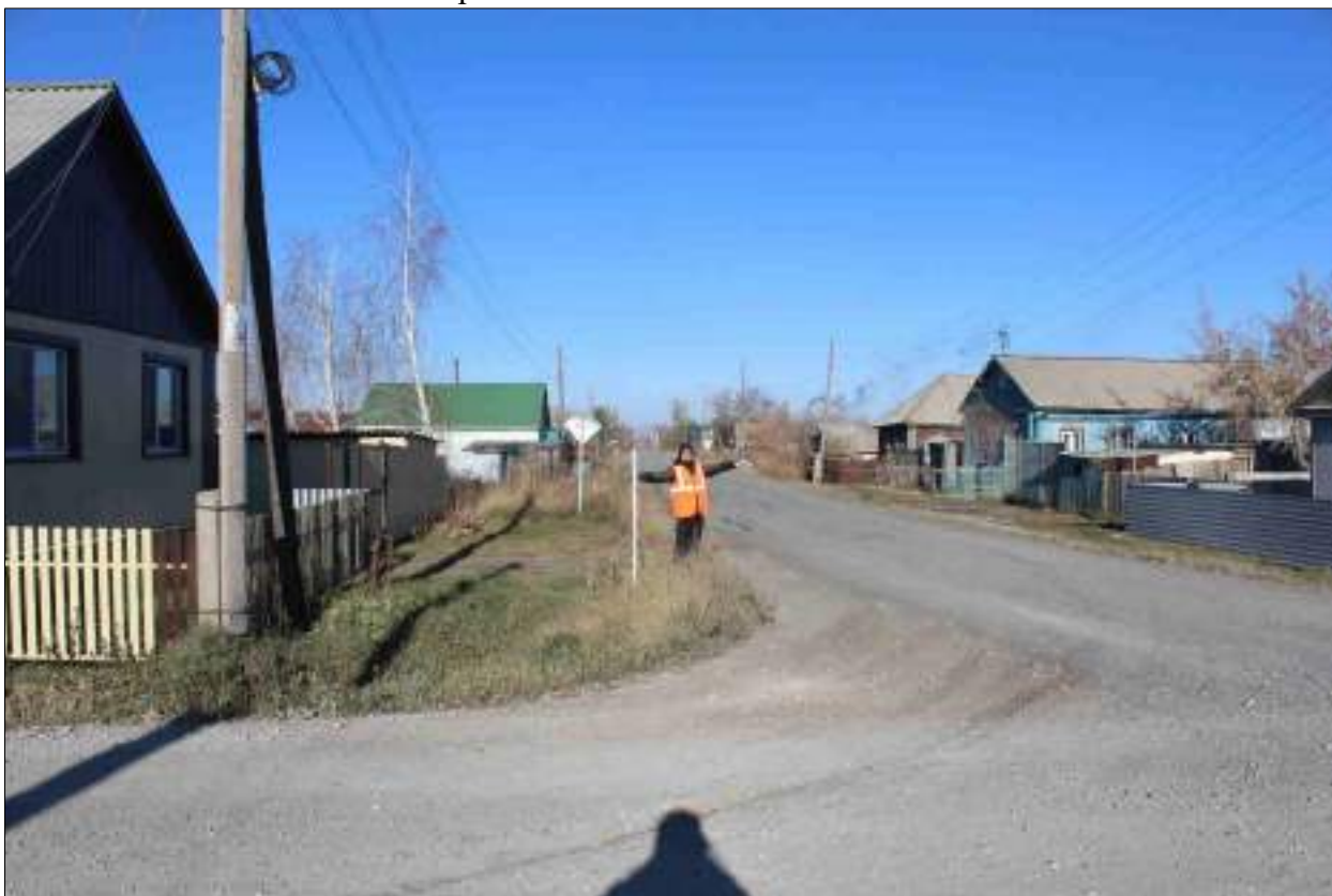
Рисунок 66 – «Распределительный газопровод р.п. Чистоозерное». Вид из точки 154 в направлении точки 183. Снято с ЮВ.
