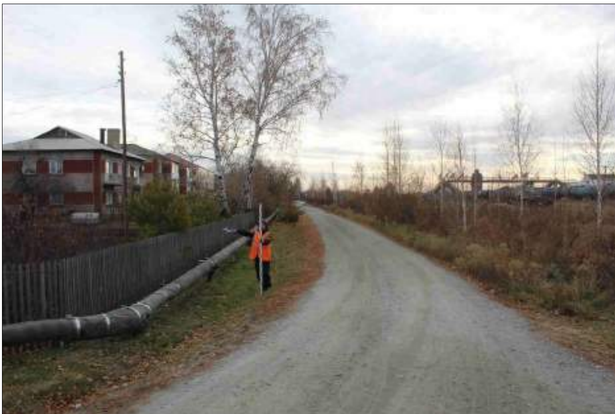
Рисунок 333 – «Распределительный газопровод р.п. Чистоозерное». Вид из точки 20 в направлении точки 21. Снято с СЗ.
