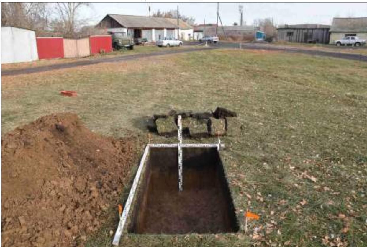
Рисунок 550 – «Распределительный газопровод р.п. Чистоозерное». Шурф №37. Общий вид выполненного шурфа. Снято с Ю.
