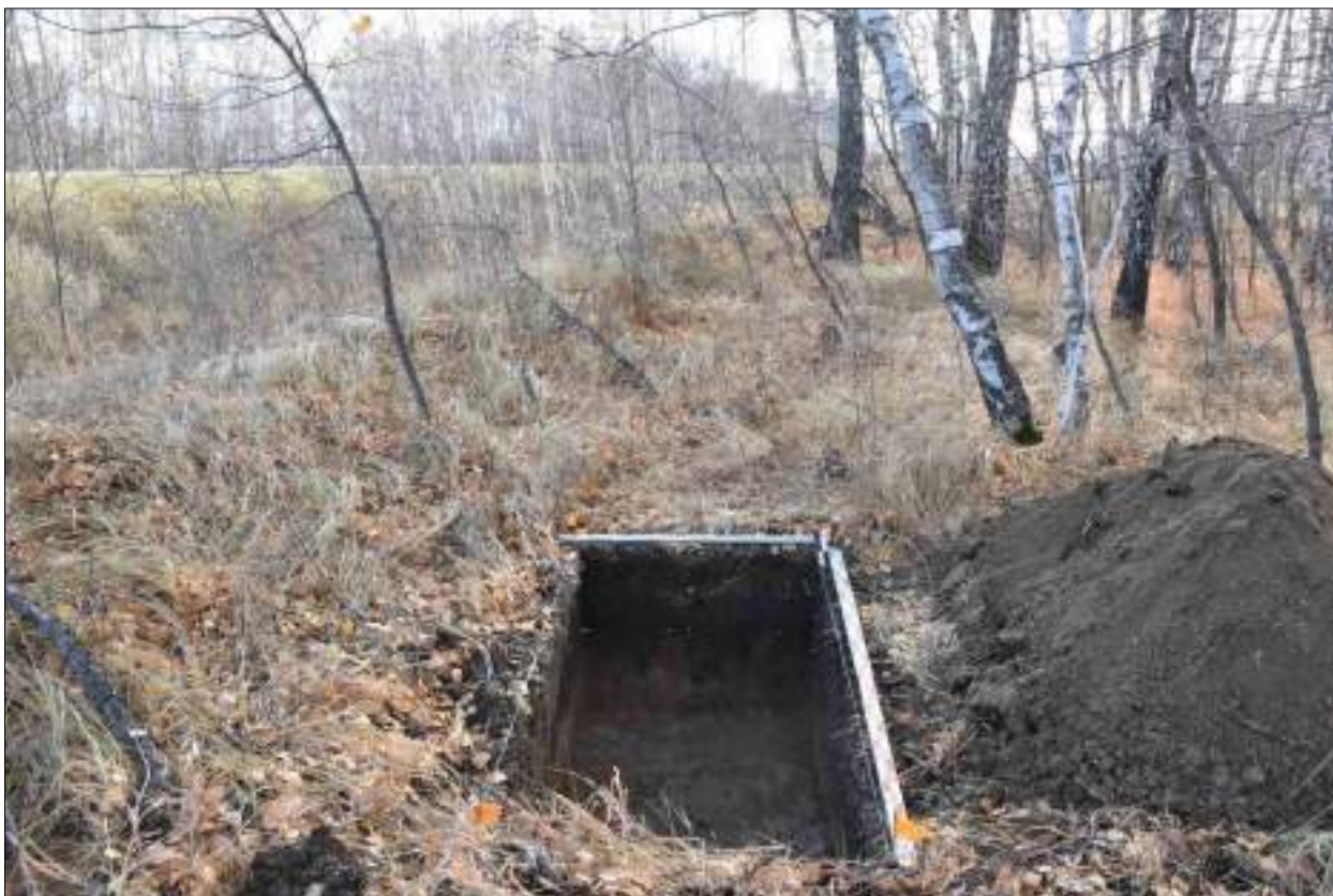
Рисунок 525 – «Распределительный газопровод р.п. Чистоозерное». Шурф №32. Общий вид выполненного шурфа. Снято с С.
