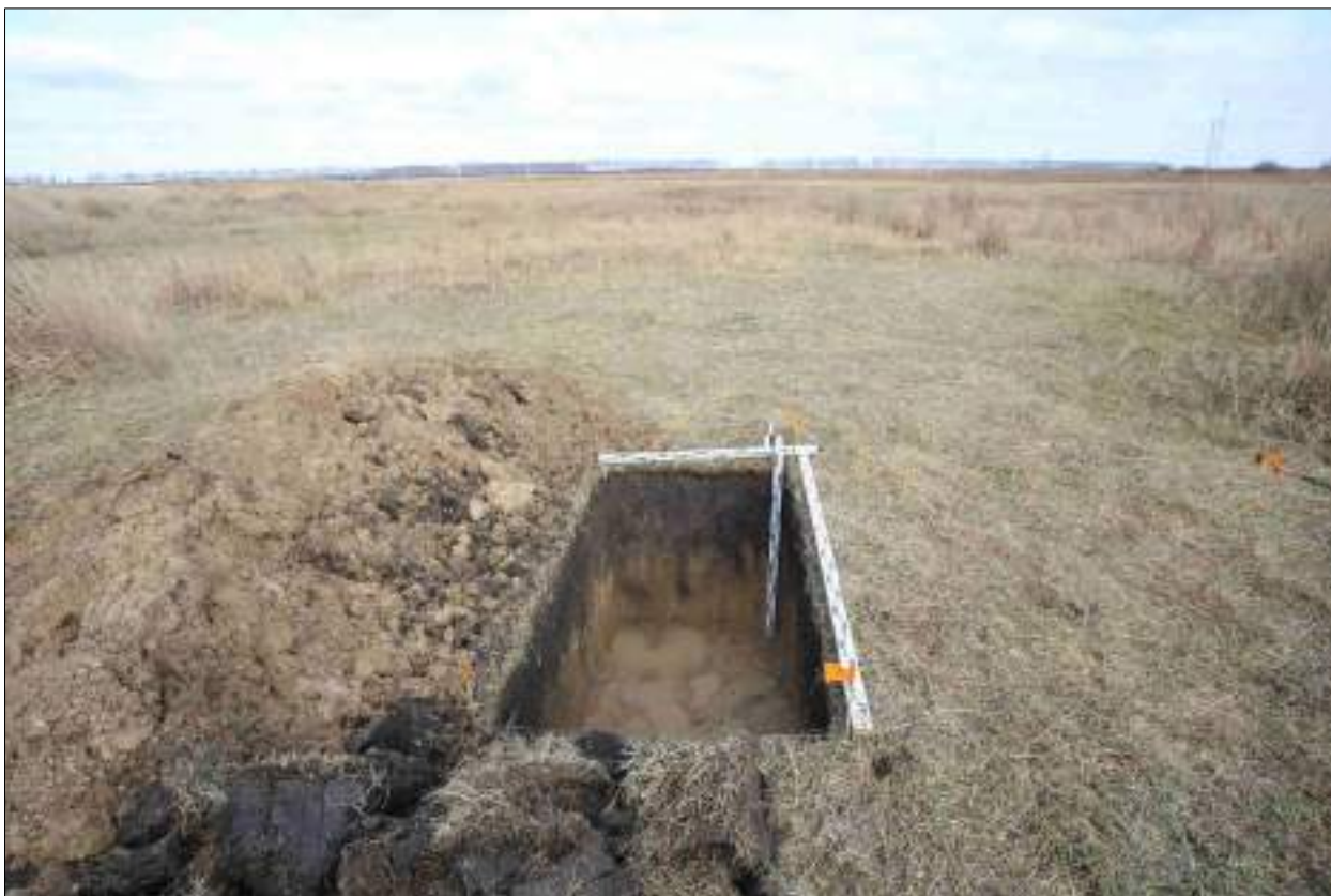
Рисунок 457 – «Распределительный газопровод р.п. Чистоозерное». Шурф №19. Общий вид выполненного шурфа. Снято с Ю.
