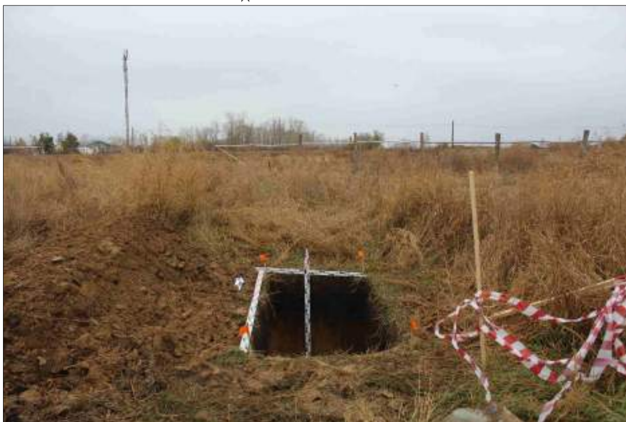
Рисунок 372 – «Распределительный газопровод р.п. Чистоозерное». Шурф №2. Общий вид выполненного шурфа. Снято с Ю.
