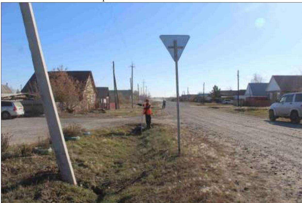
Рисунок 118 – «Распределительный газопровод р.п. Чистоозерное». Вид из точки 120 в направлении точки 111. Снято с СЗ.
