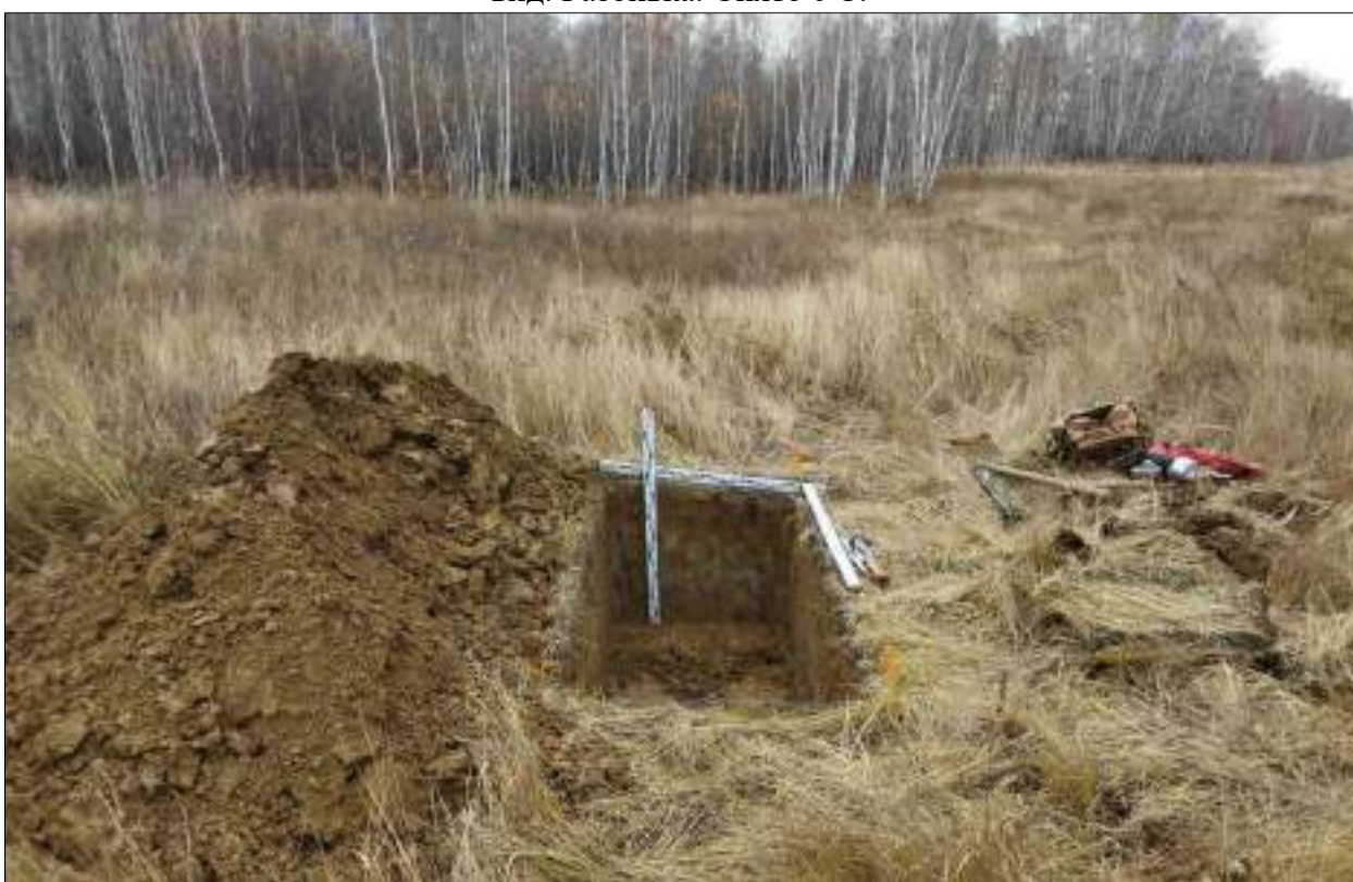
Рисунок 530 – «Распределительный газопровод р.п. Чистоозерное». Шурф №33. Общий вид выполненного шурфа. Снято с С.
