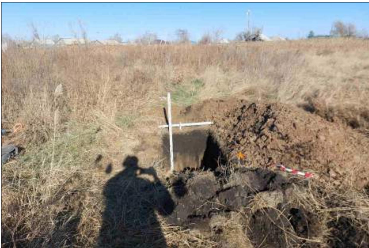
Рисунок 621 – «Распределительный газопровод р.п. Чистоозерное». Шурф №51. Общий вид выполненного шурфа. Снято с Ю.
