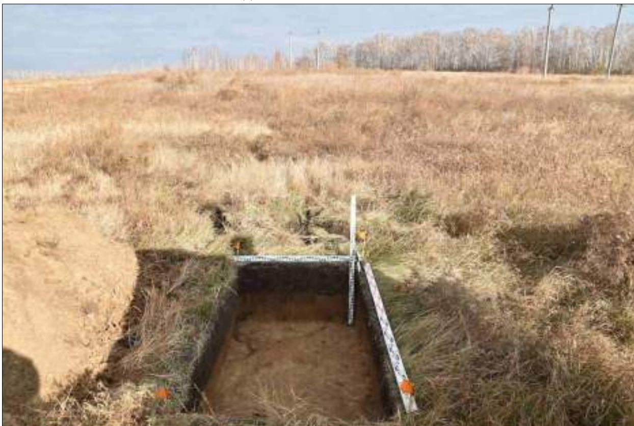
Рисунок 596 – «Распределительный газопровод р.п. Чистоозерное». Шурф №46. Общий вид выполненного шурфа. Снято с Ю.
