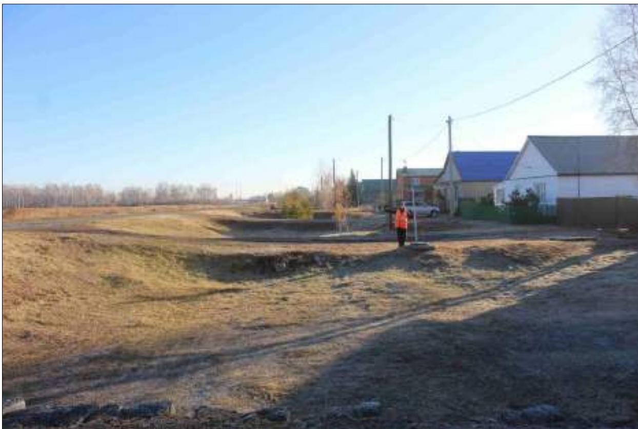
Рисунок 35 – «Распределительный газопровод р.п. Чистоозерное». Вид из точки 181 в направлении точки 180. Снято с 3.
