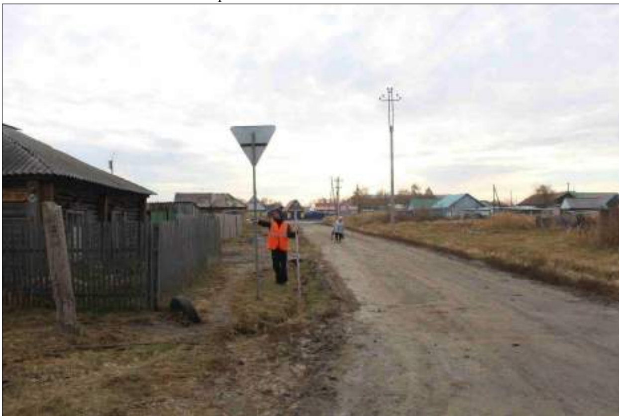
Рисунок 322 – «Распределительный газопровод р.п. Чистоозерное». Вид из точки 17 в направлении точки 25. Снято с СЗ.
