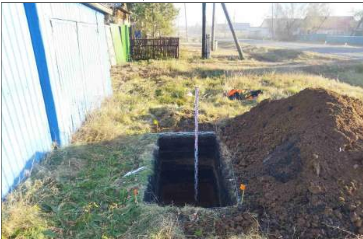
Рисунок 606 – «Распределительный газопровод р.п. Чистоозерное». Шурф №48. Общий вид выполненного шурфа. Снято с СЗ.
