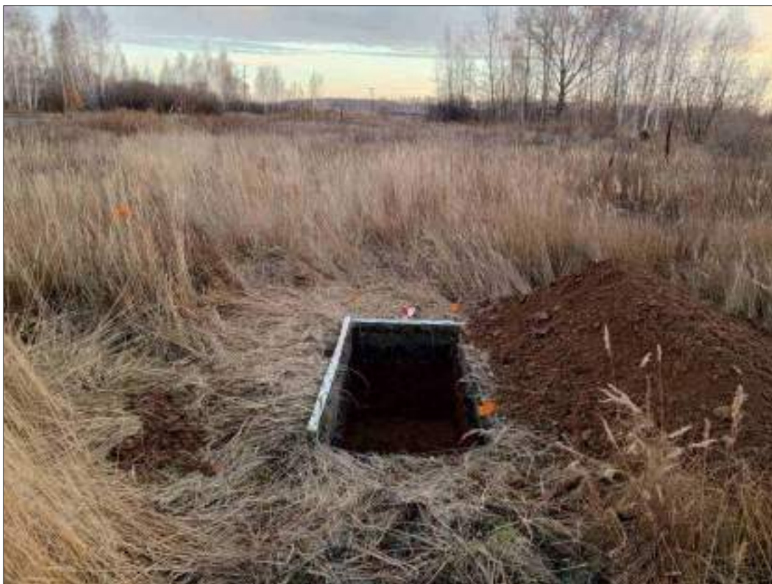
Рисунок 535 – «Распределительный газопровод р.п. Чистоозерное». Шурф №34. Общий вид выполненного шурфа. Снято с С.
