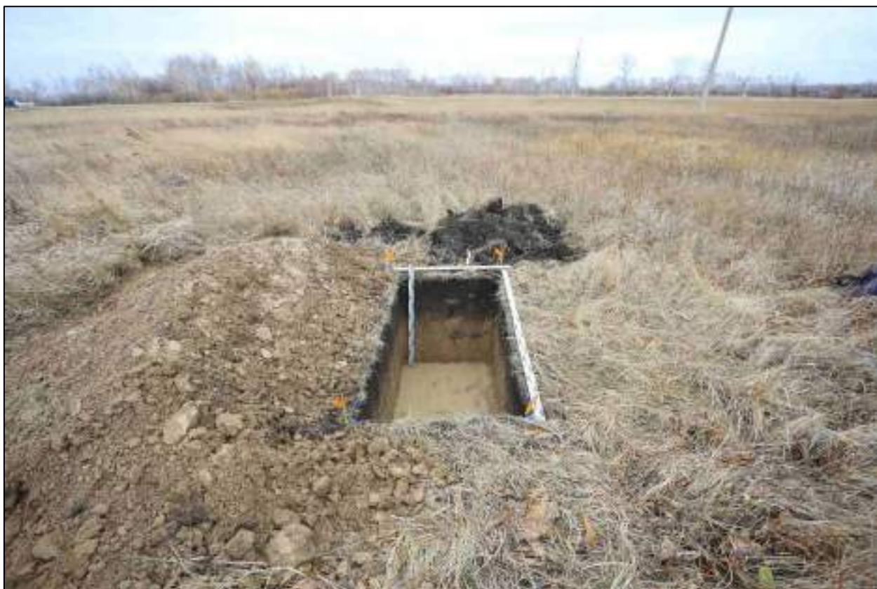
Рисунок 387 – «Распределительный газопровод р.п. Чистоозерное». Шурф №5. Общий вид выполненного шурфа. Снято с Ю.
