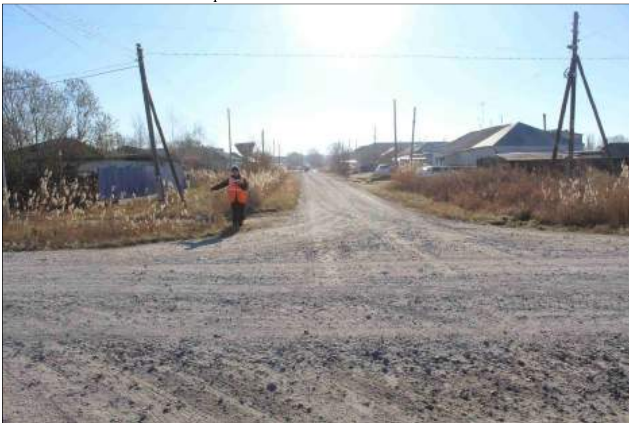
Рисунок 60 – «Распределительный газопровод р.п. Чистоозерное». Вид из точки 168 в направлении точки 160. Снято с СЗ.
