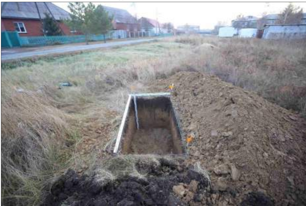
Рисунок 412 – «Распределительный газопровод р.п. Чистоозерное». Шурф №10. Общий вид выполненного шурфа. Снято с С.
