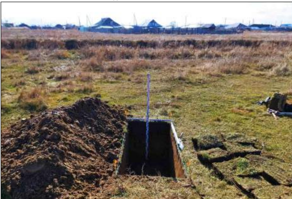
Рисунок 472 – «Распределительный газопровод р.п. Чистоозерное». Шурф №22. Общий вид выполненного шурфа. Снято с С.
