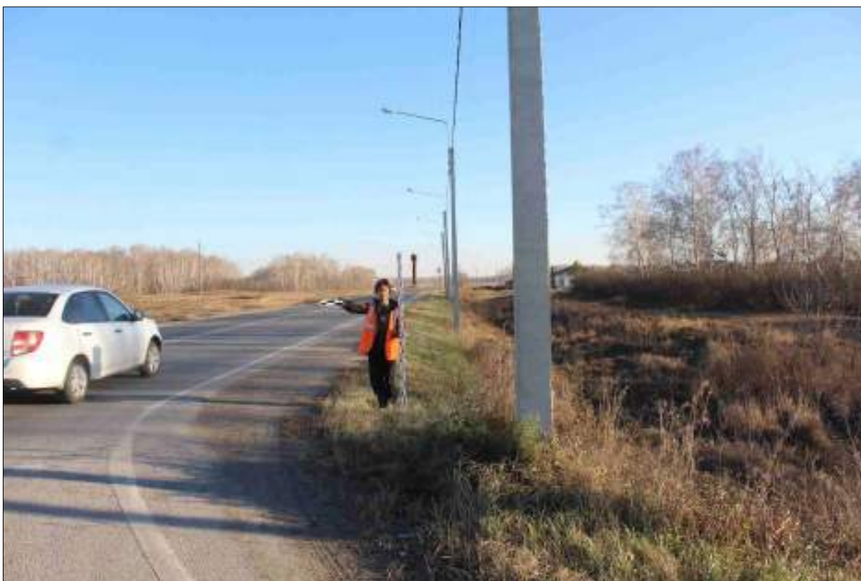
Рисунок 225 – «Распределительный газопровод р.п. Чистоозерное». Вид из точки 78 в направлении точки 79. Снято с СЗ.
