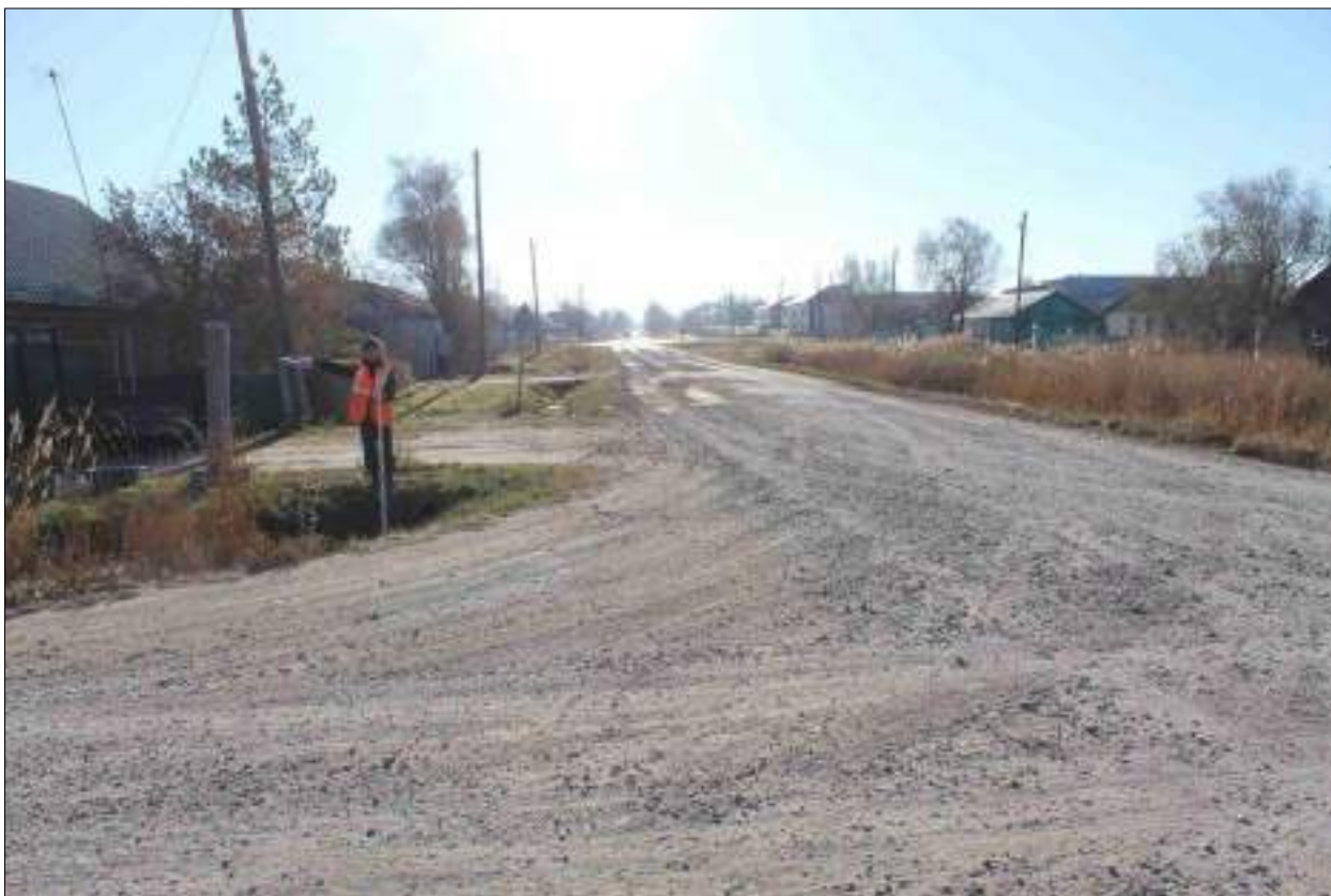
Рисунок 65 – «Распределительный газопровод р.п. Чистоозерное». Вид из точки 155 в направлении точки 156. Снято с СЗ.
