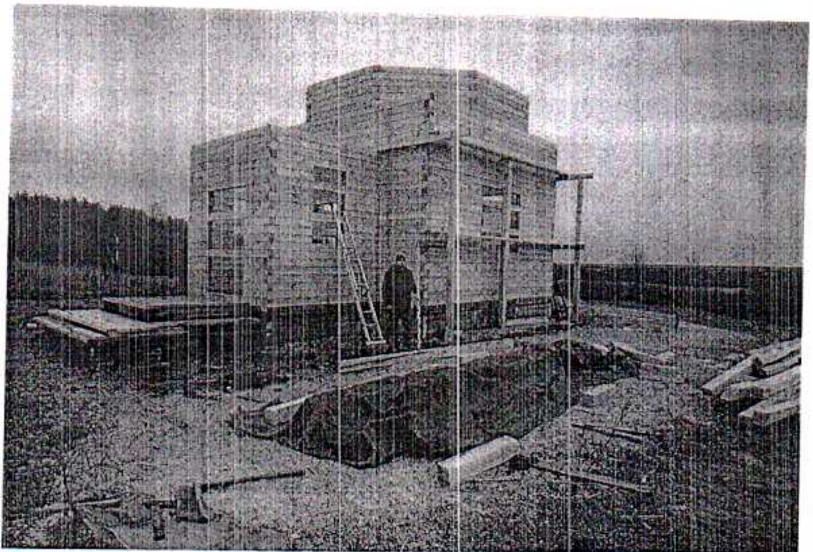
Фото 6. Поселение Умна-1. Общий вид с запада-северо-запада на строительство часовни на территории объекта археологического наследия и разрушения культурного слоя
