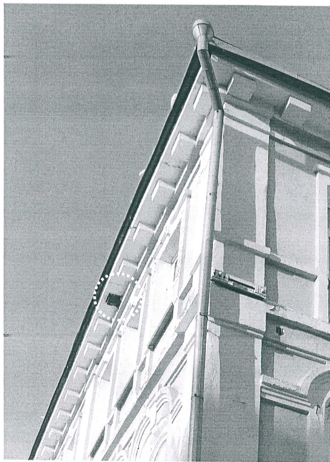
11. Дефекты карниза южного фасада.
