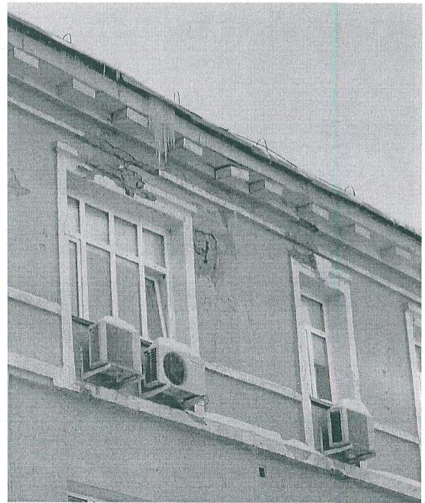
13. Дефекты северного фасада.
