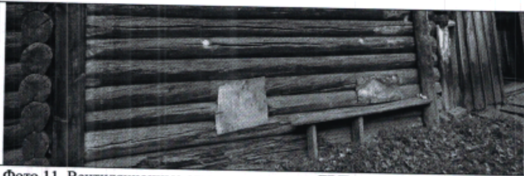
Фото 11. Вентиляционные отдушины защиты ДВП.
