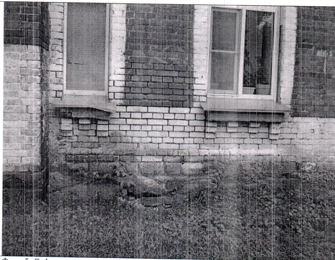
Фото 5. Дефекты кладки стены и цоколя северо-западного фасада. Проседание отмостки
