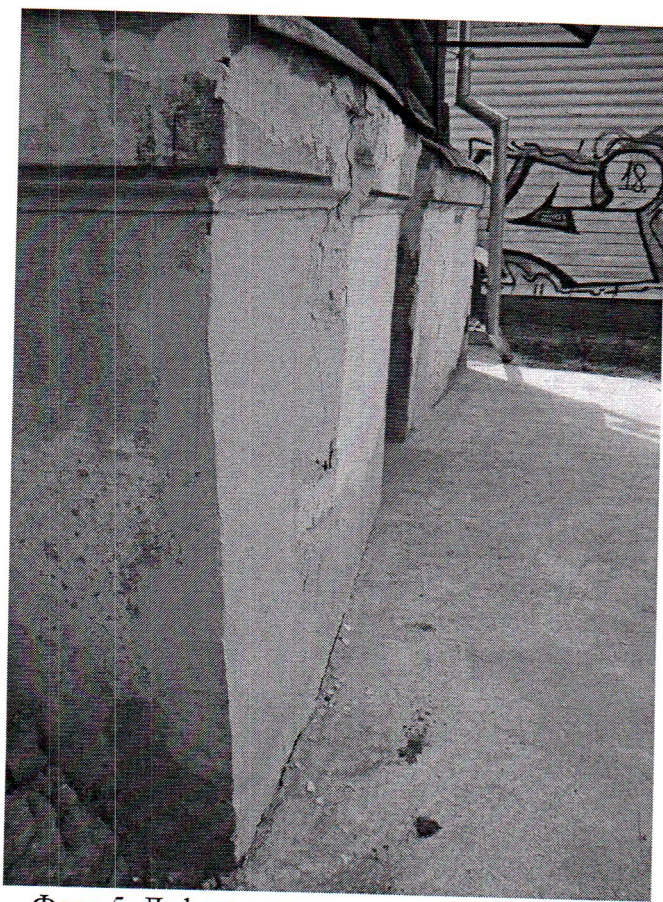
Фото 5. Деформация простенка в западном ризалите северного фасада.
