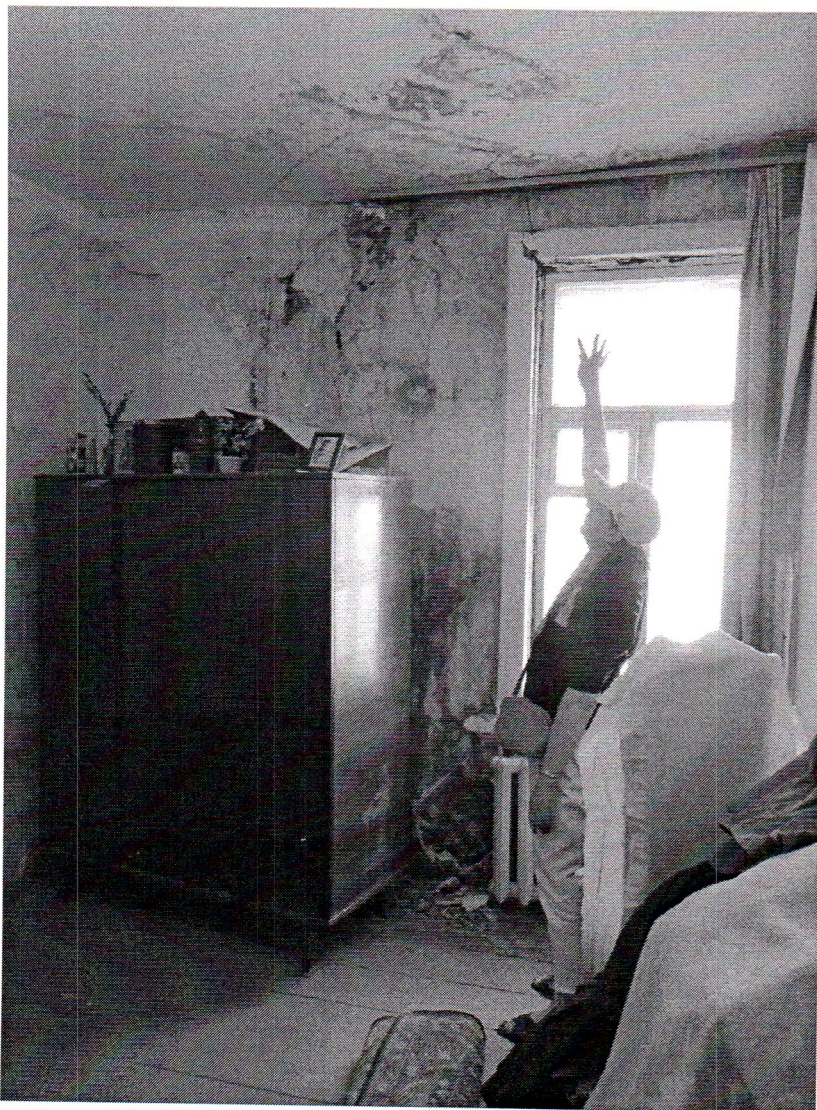
Фото 22. Следы протечек кровли и промерзания стен в квартире № 10 (2-й этаж).
