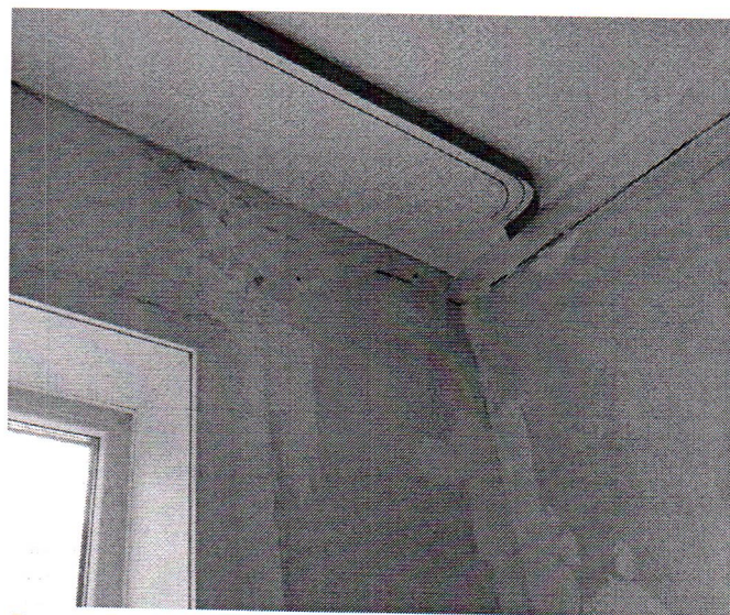
Фото 31. Следы ремонта стен в местах протечек кровли в зале кв.11.
