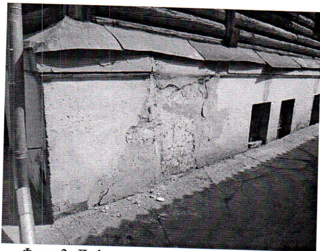
Фото 3. Деформация стены на западном фасаде месте заложенного оконного проема.
