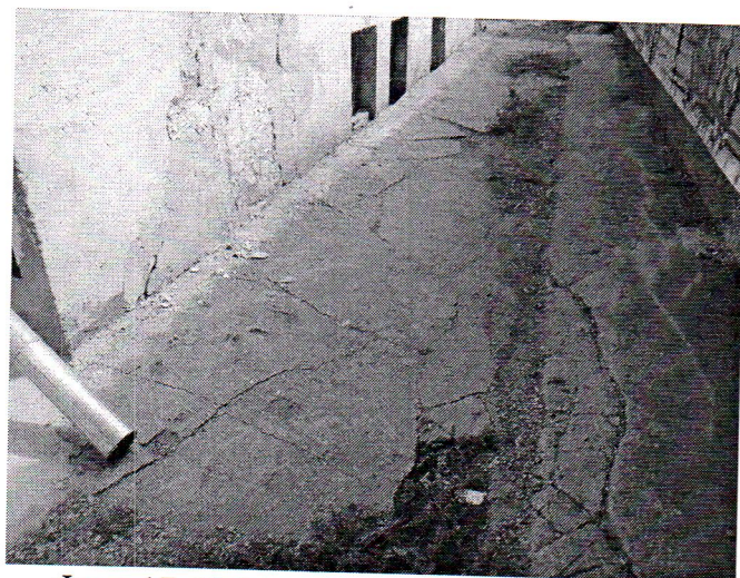
Фото 17. Дефекты отмостки около стены западного фасада.
