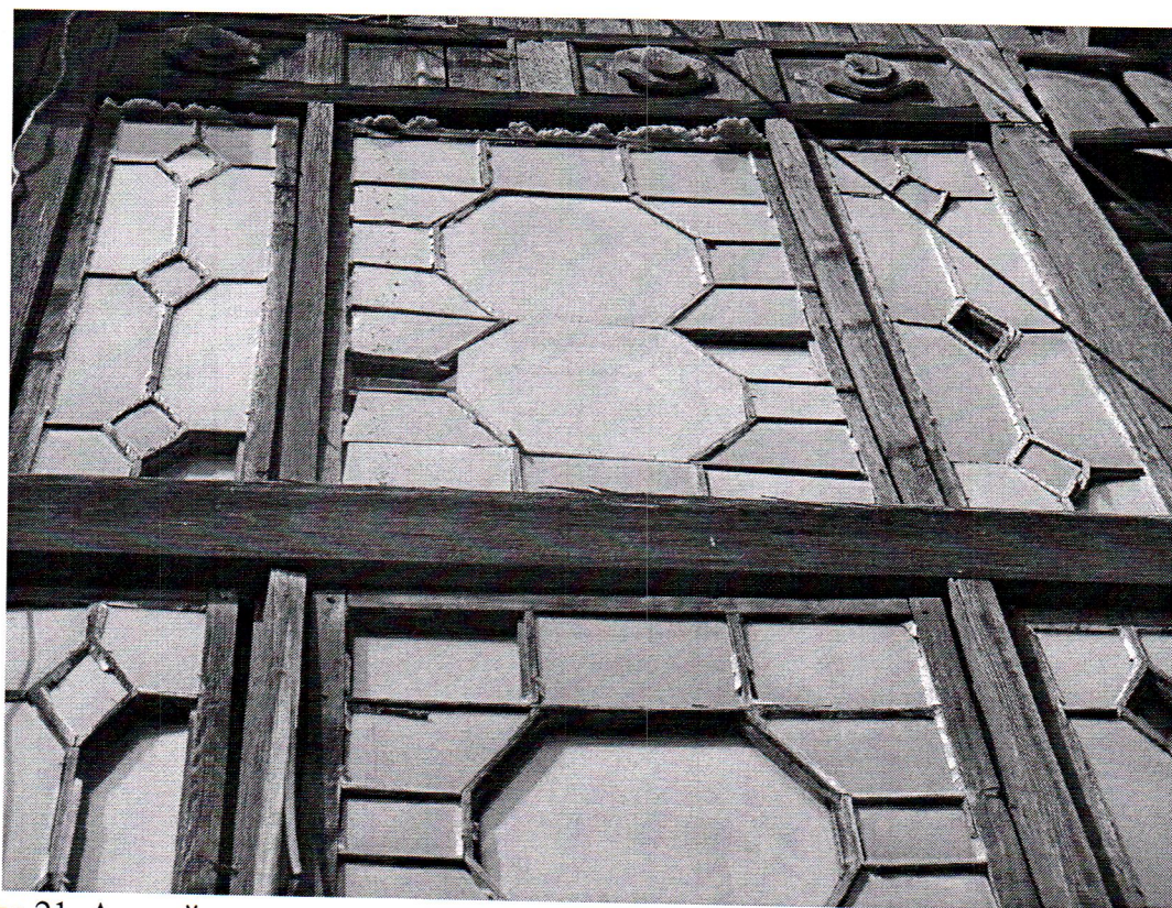
Фото 21. Аварийное состояние верхней наружной рамы витража. Выпадение стекол.
