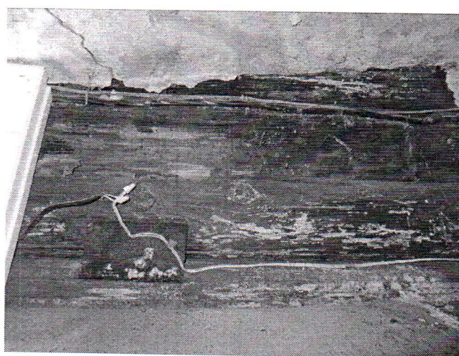
Фото 11. Поражение нижних венцов сруба на восточной стороне сруба в месте примыкания поздней пристройки.
