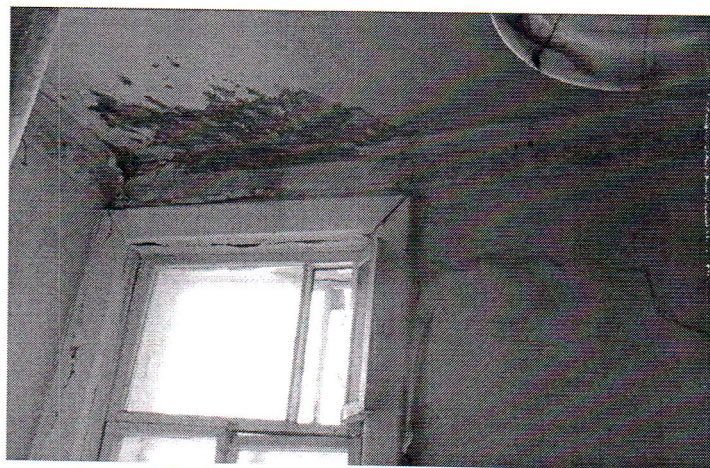
Фото 29. Следы протечек на кухне кв.10.
