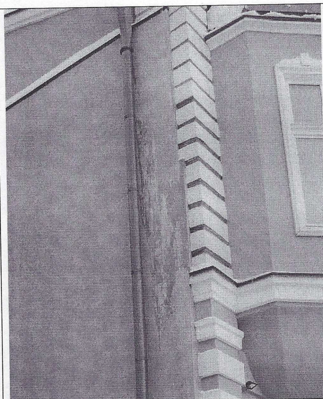
Фото 8. Дефекты отделки стены северного фасада.
