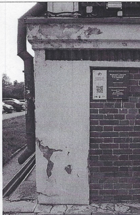
Фото 9. Дефекты отделочного слоя пилястр и карниза цокольного этажа.
