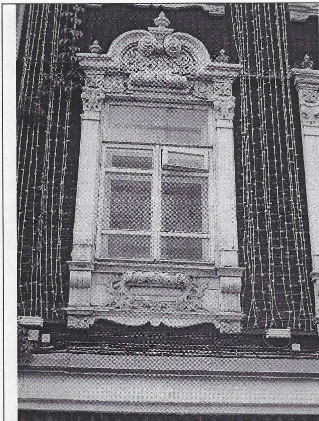
Фото 11. Состояние декоративных наличников окон деревянной части здания. Оборудование для подсветки фасада.
