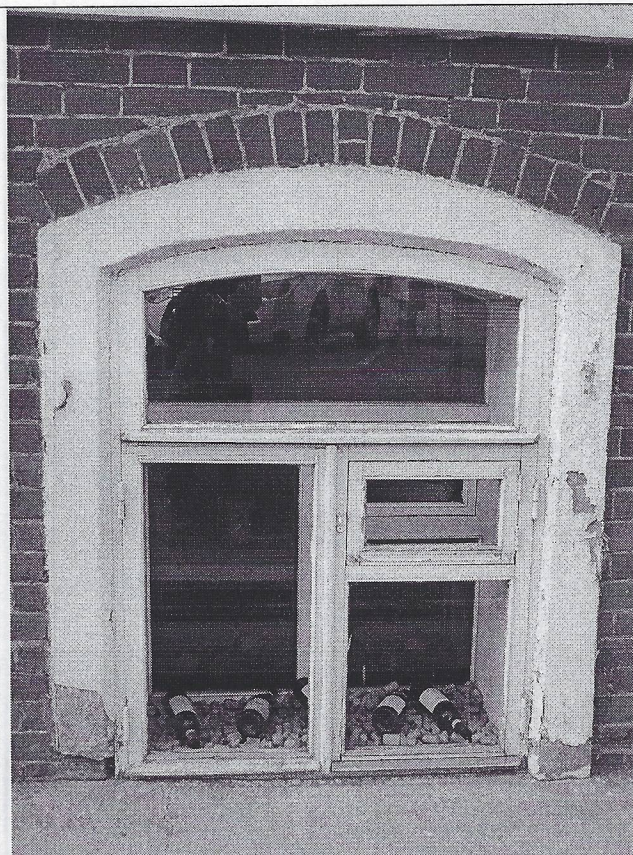
Фото 15. Дефекты окрасочного слоя наличников окон цокольного этажа.
