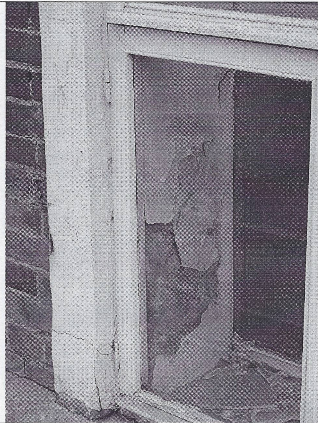
Фото 19. Дефекты отделки междурамного пространства окон цокольного этажа.
