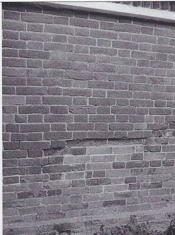
Фото 7. Дефекты кирпичной кладки цокольного этажа.
