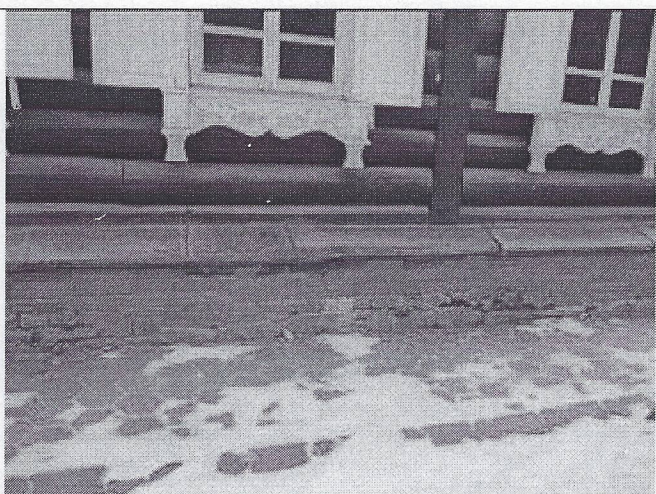
Фото 16. Дефекты в кладке цоколя на северном фасаде
