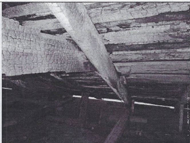
Фото 13. Следы пожара на конструктивных элементах крыши
