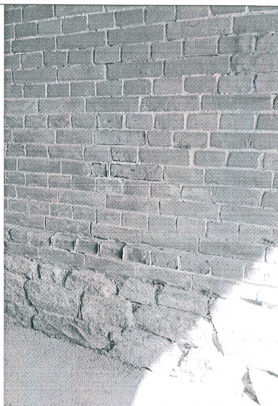
9. Дефекты кирпичной кладки стен арки-проезда.
