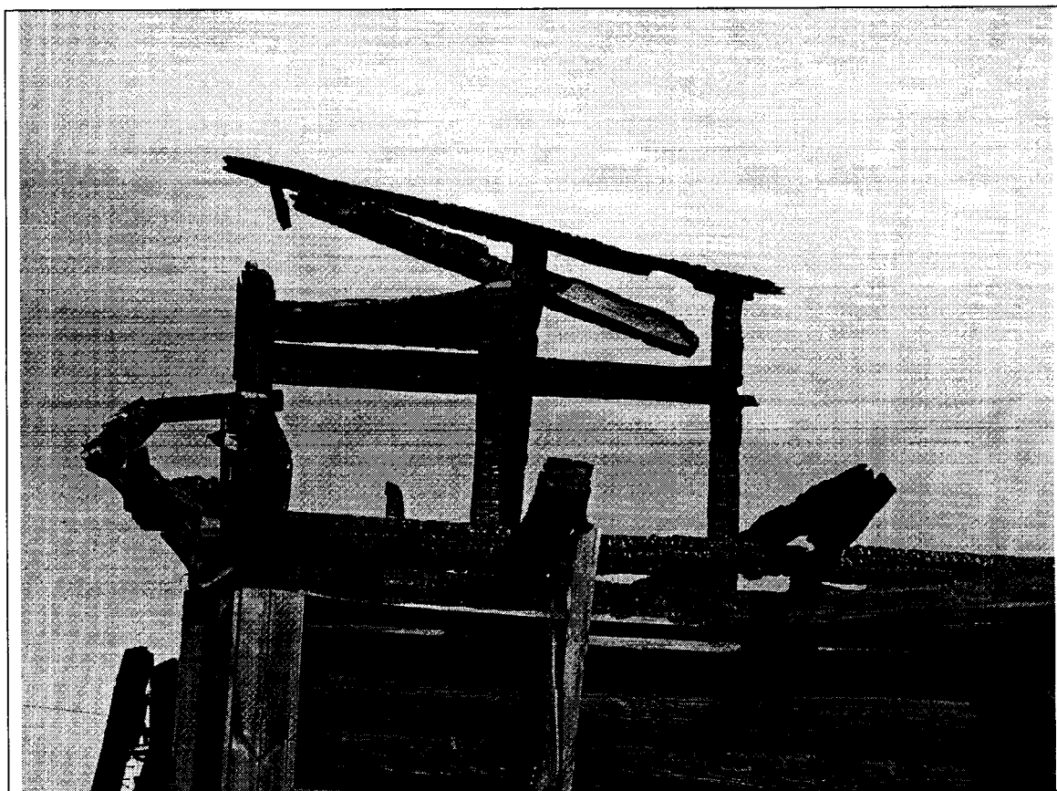
6. Фрагмент обгоревших конструкций крыши и двух верхних венцов сруба.
