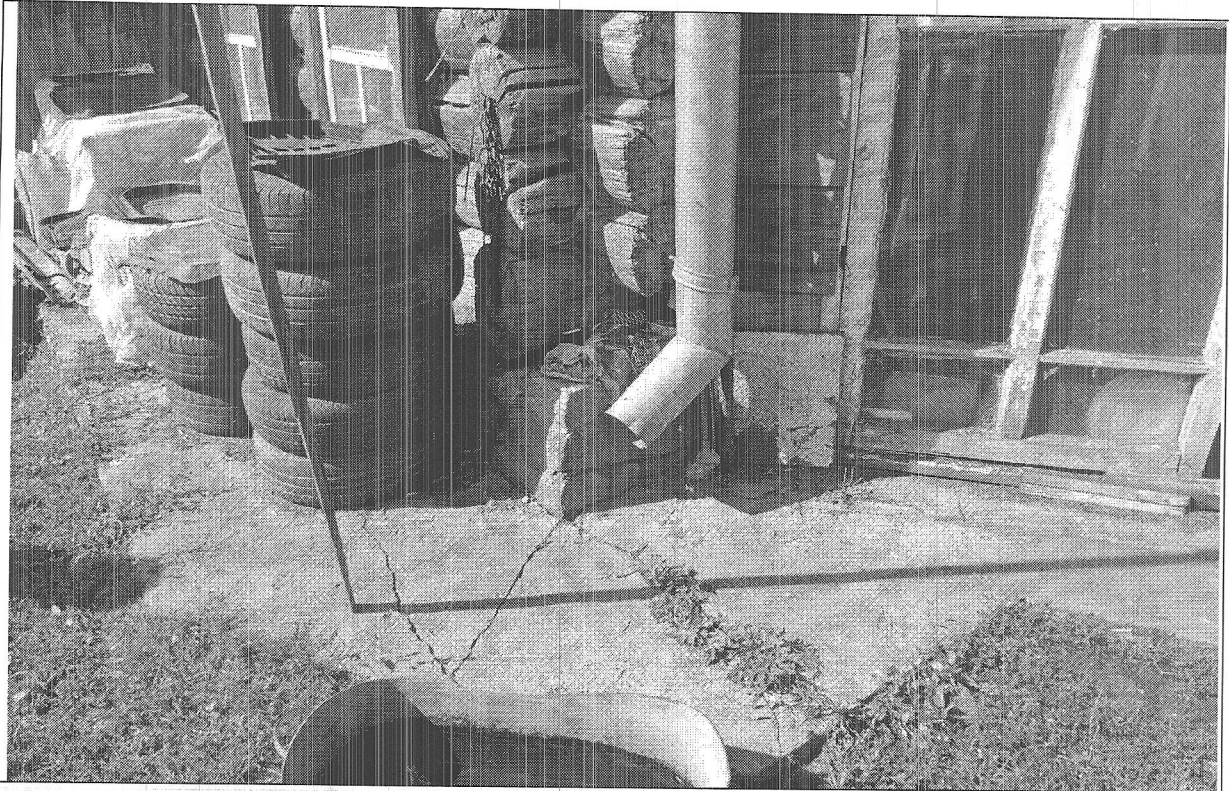
Фото 15. Трещины в отстойке.
