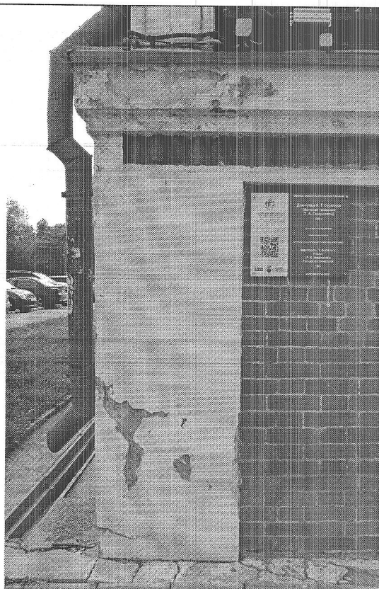
Фото 9. Дефекты отделочного слоя пилястр и карниза цокольного (1-ого) этажа.
