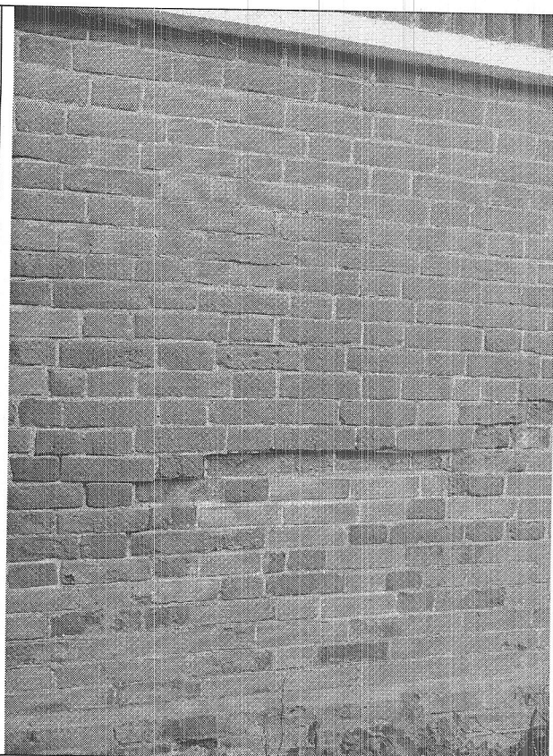
Фото 7. Дефекты кирпичной кладки цокольного (1-ого) этажа.
