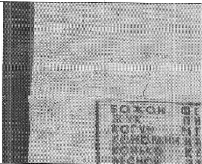
Фото 11. Дефекты в отделке стелы
