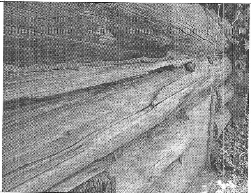
Фото 16. Подверженные гнили брёвна стены.
