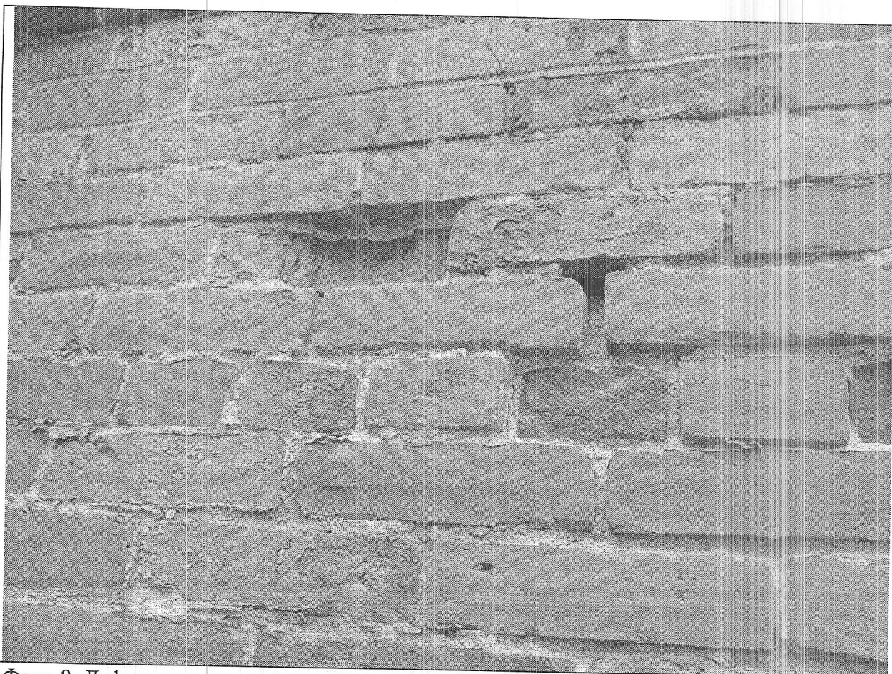
Фото 8. Дефекты кирпичной кладки стены юго-западного фасада.
