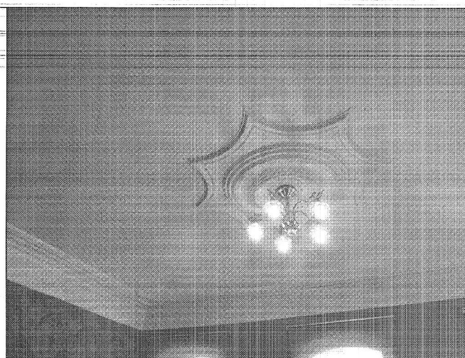
Фото 18. Фрагмент потолка (2-й этаж).
