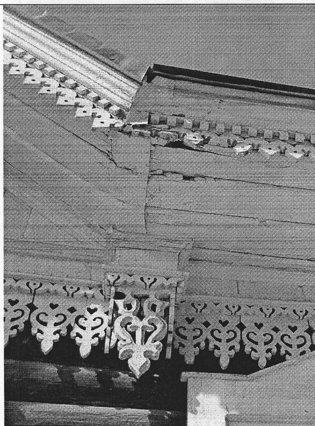
11. Дефекты декоративных элементов карниза и подкарнизных досок.
