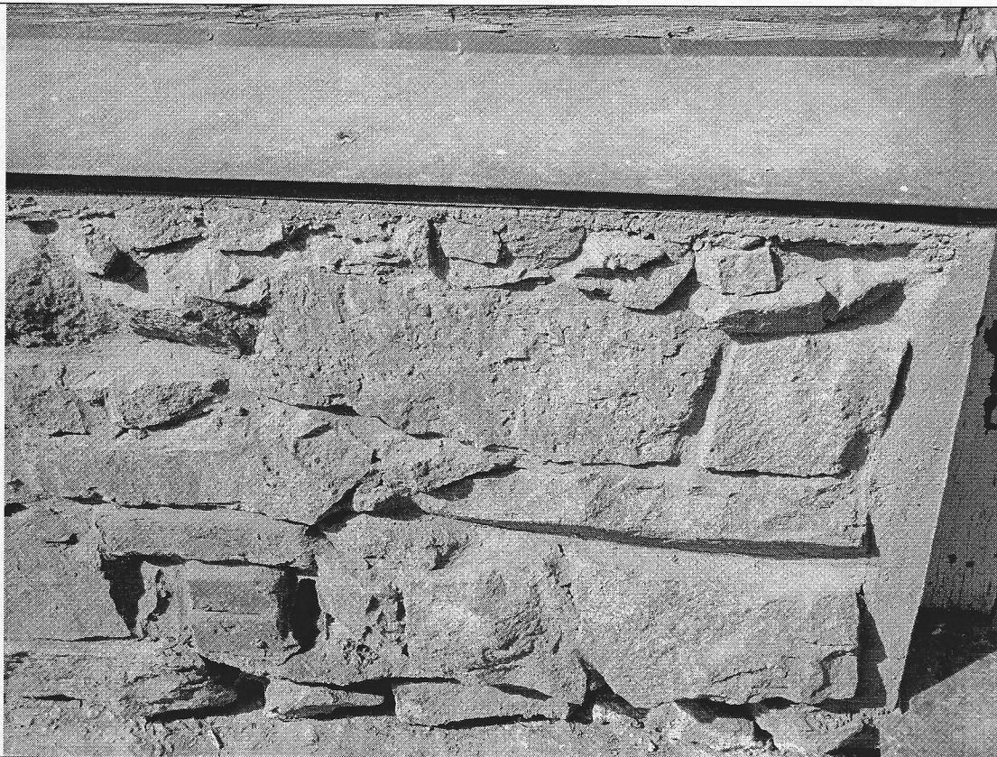
8. Дефекты цоколя южного фасада.
