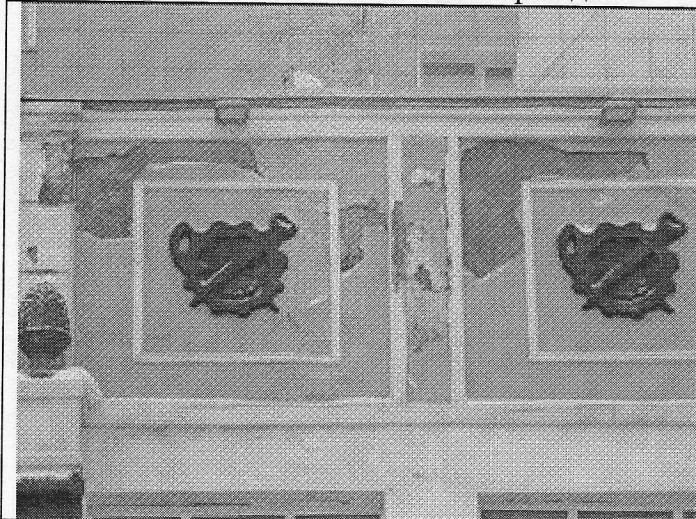
28. Дефекты отделки декоративных элементов парапетной стенки главного фасада
