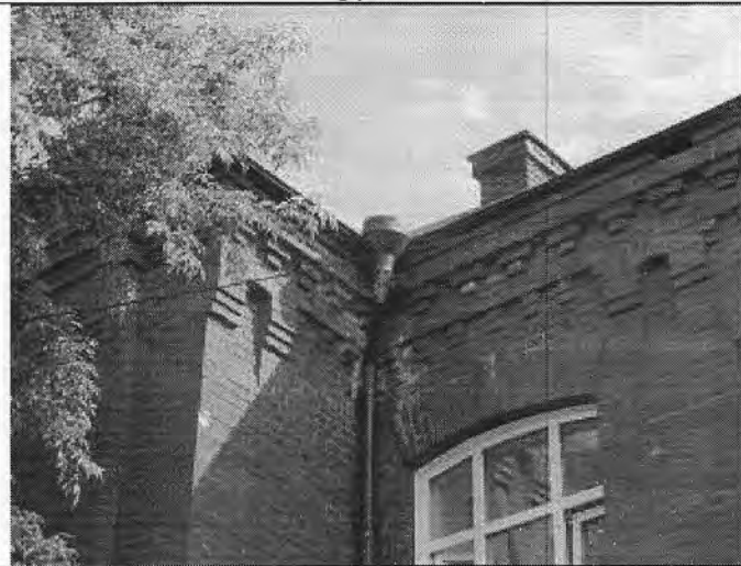
15. Дефекты кладки стен в районе водосточной трубы
