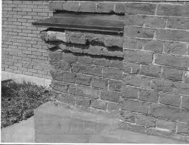
19. Дефекты кладки стены на западном углу
