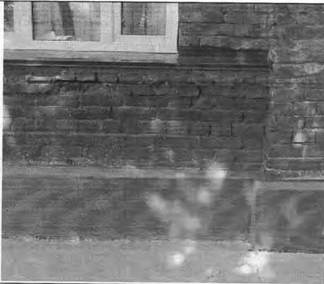
21. Дефекты кладки стены
