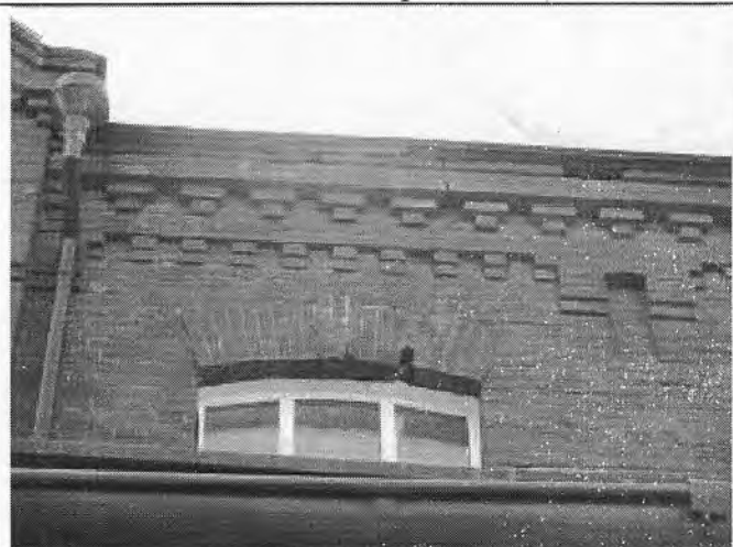
17. Деформационная трещина на северо-западном фасаде
