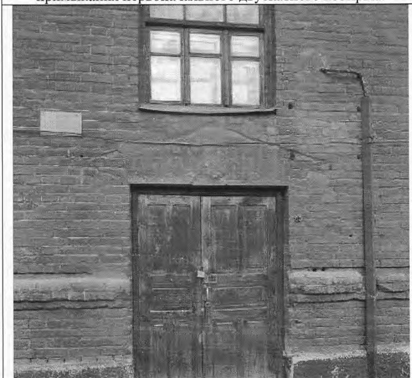
34. Фрагмент фото 33. В кладке видны штрабы от примыкания первоначального двускатного козырька
