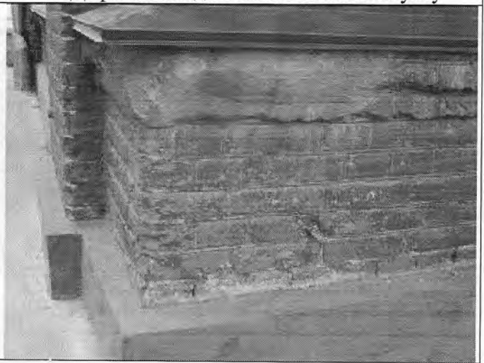
20. Дефекты кладки стены на южном углу
