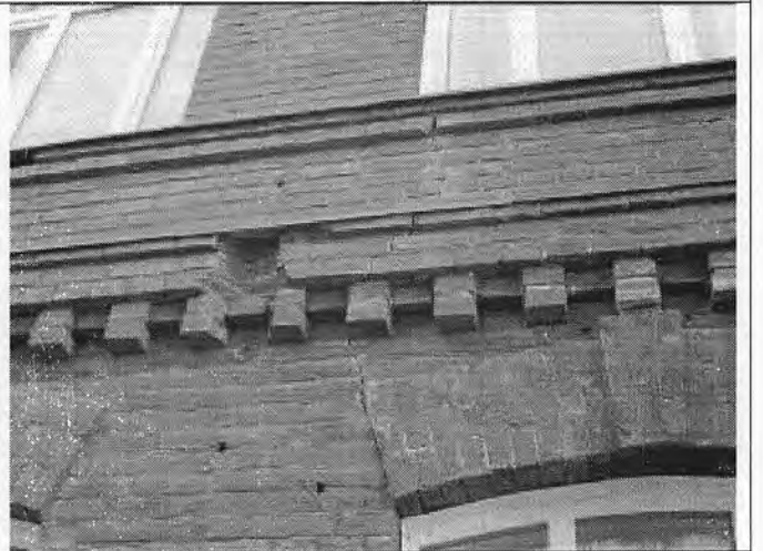
18. Деформационная трещина на северо-восточном фасаде
