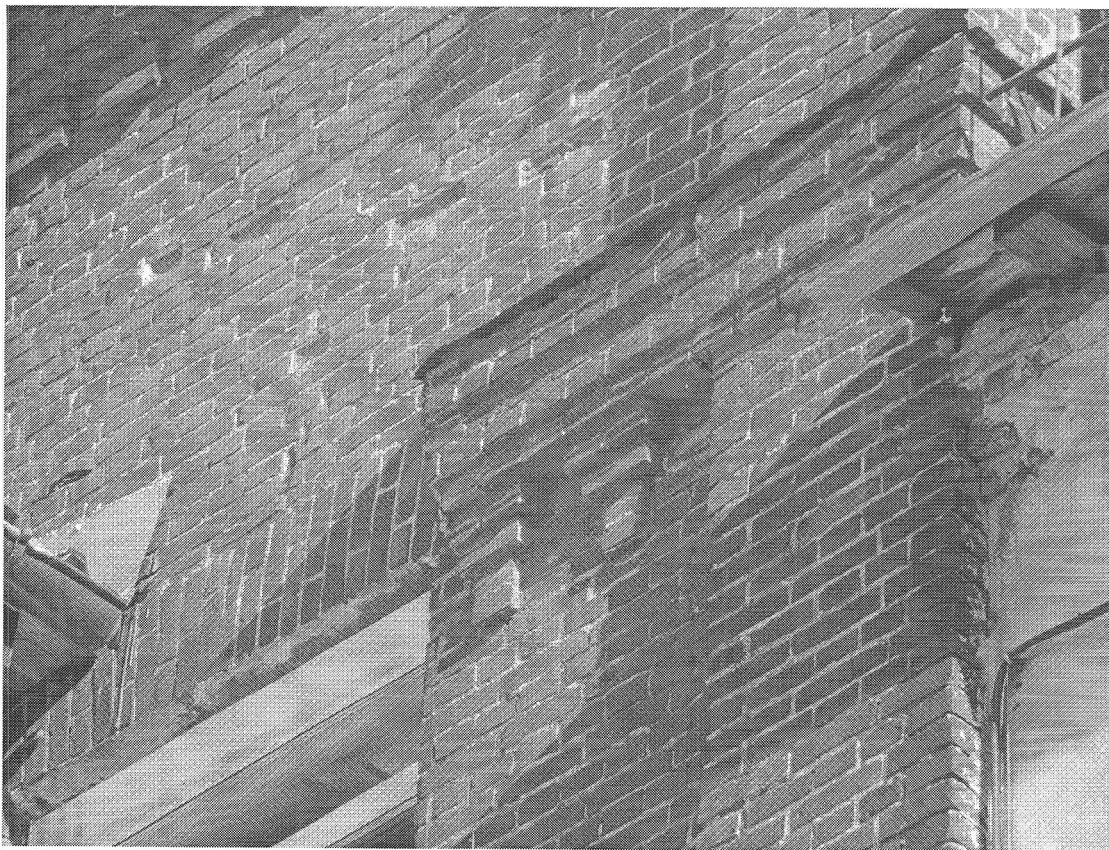
6. Дефекты кирпичной кладки стены юго-западного фасада.
