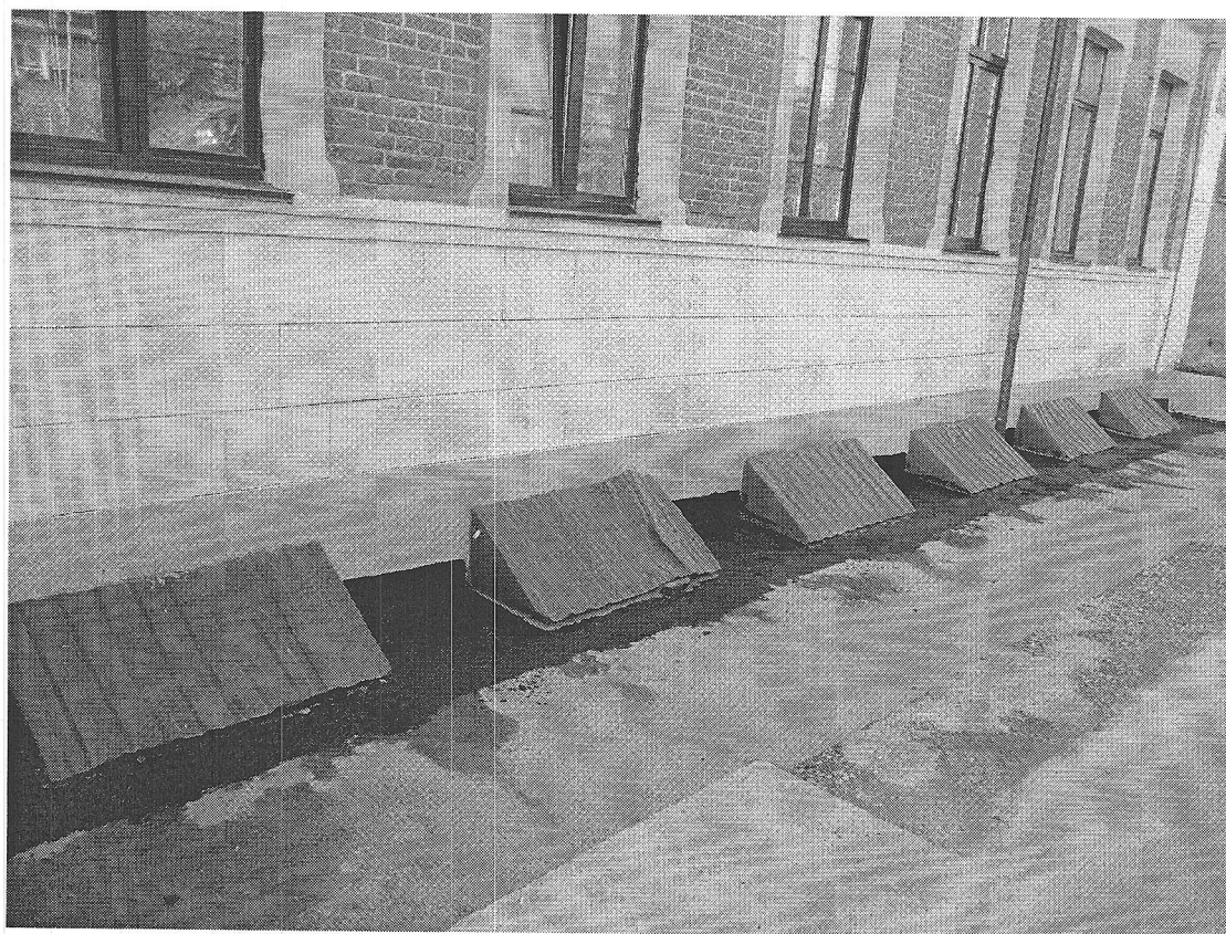
5. Состояние цоколя северо-восточного фасада. Оформление прямков. Отмостка.
