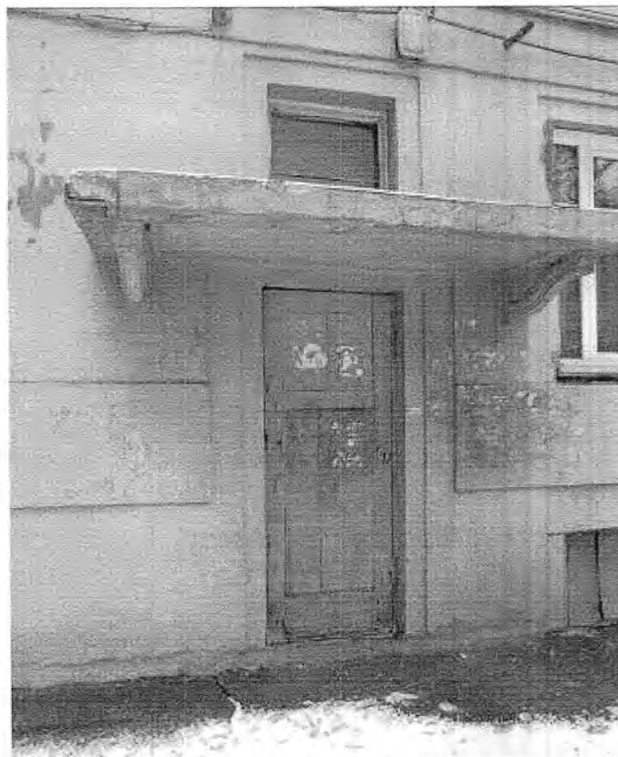
24. Дефекты отделки козырька южного (дворового) фасада.
