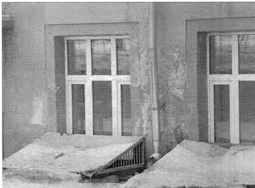
17. Дефекты отделки цоколя дворового фасада южного крыла.
