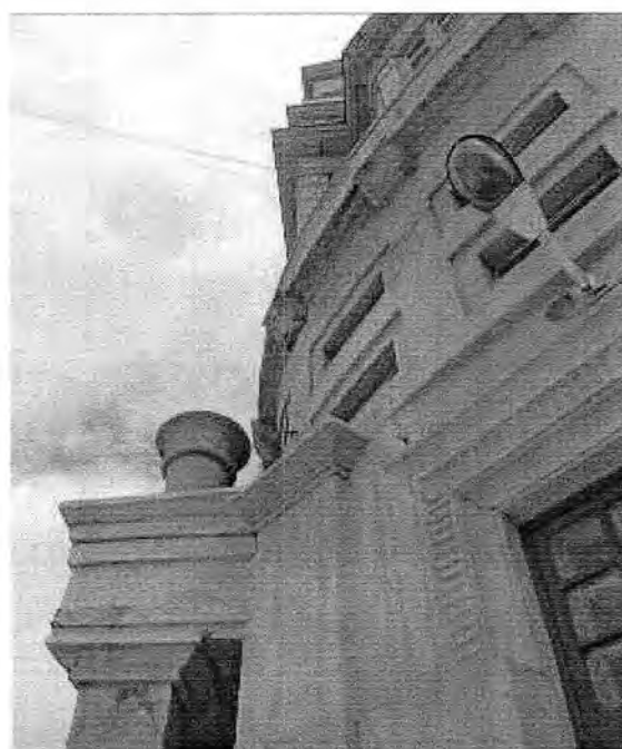
38. Трещина в зоне портала.
