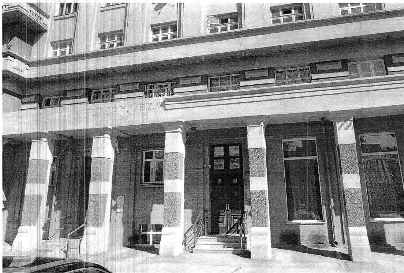
32. Входы западного (главного) фасада. Трещина на междуэтажном карнизе.
