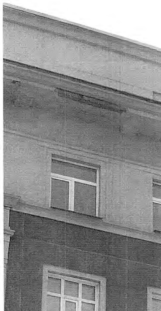
40. Дефект аттикового карниза северного бокового фасада.
