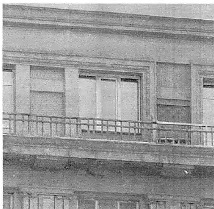
31. Фрагмент фото 29: дефект декоративной штукатурки.
