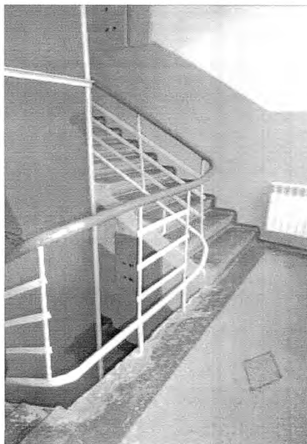
66. Повреждение ограждения (подъезд №5).
