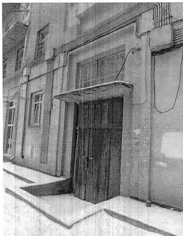
23. Дефекты отделки козырька восточного (дворового) фасада.
