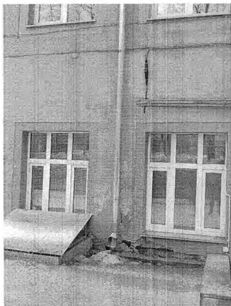
16. Дефекты отделки цоколя дворового фасада южного крыла.
