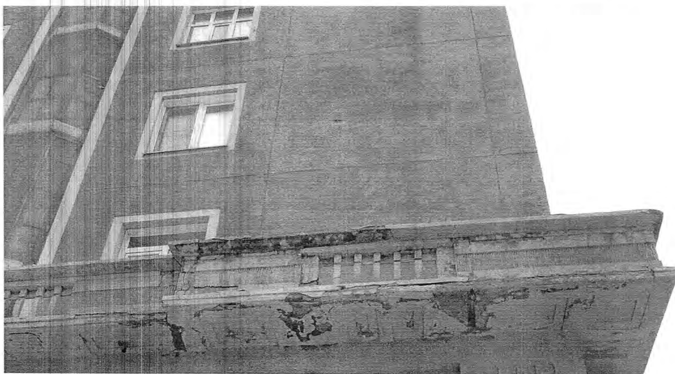
41. Фрагмент южного (бокового) фасада южного крыла. Дефекты балкона.
