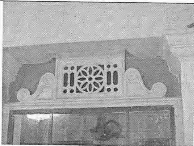
53. Вентиляционная решетка в фойе первого этажа
