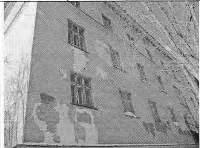
35. Отпадение окрасочного слоя стены на северо-восточном фасаде
