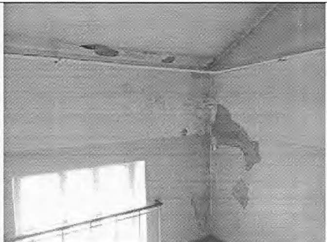
93. Дефекты стен в объеме служебных лестниц
