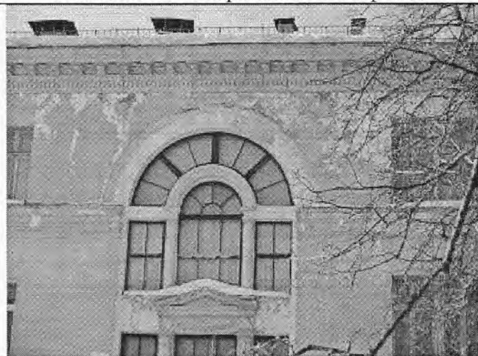
34. Дефекты отделки стены и декоративных элементов на северо-восточном фасаде
