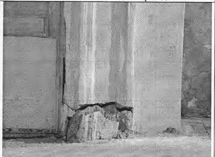
41. Отслоение фрагмента портала бокового входа на юго-западном фасаде
