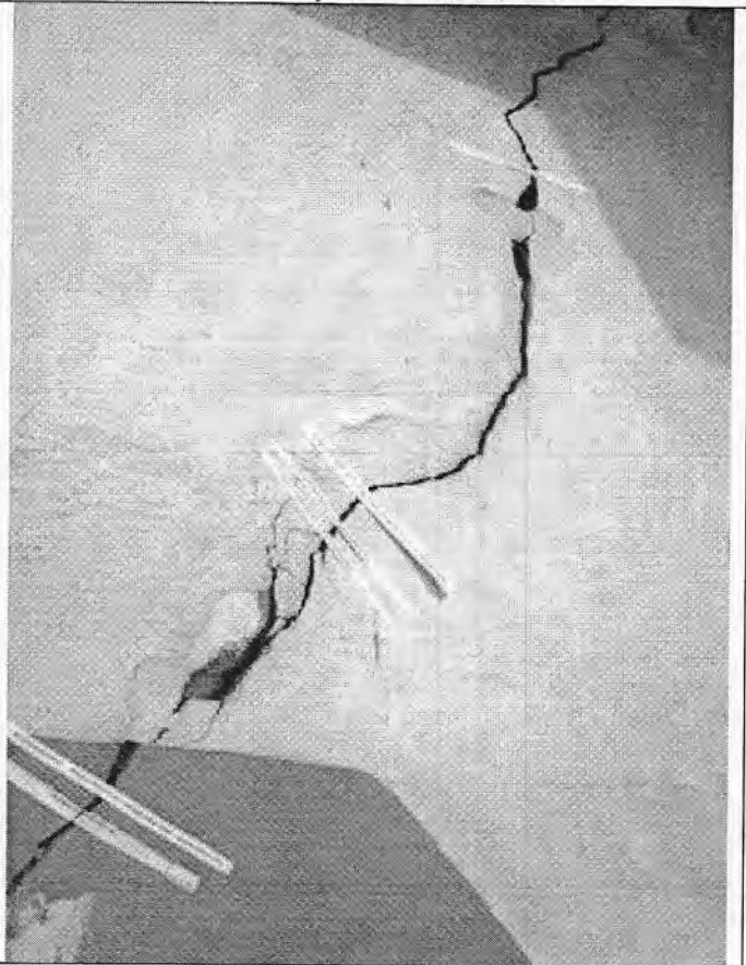
76. Трещина в кладке стены в объеме лестницы для обслуживания сцены
