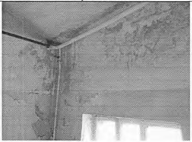
92. Следы протечек на стенах и потолке в объеме служебных лестниц
