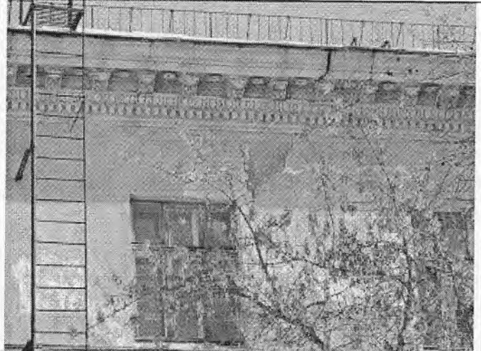
39. Дефекты отделки стены юго-западного фасада
