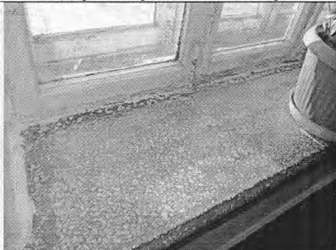
91. Дефекты деревянных оконных рам
