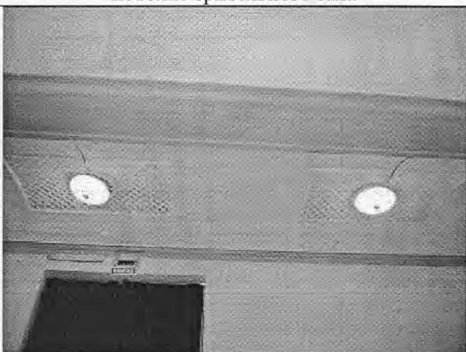
66. Декоративные вентиляционные решетки на потолке зрительного зала
