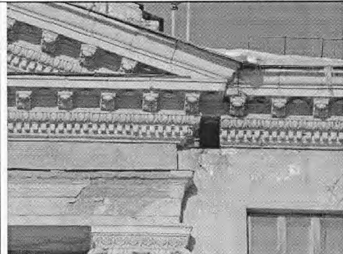
37. Дефекты отделки стены и декоративных элементов на юго-восточном фасаде
