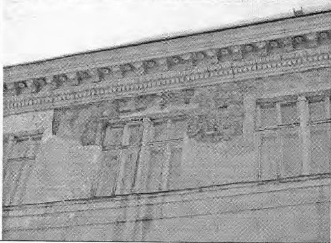
38. Дефекты отделки стены и оголение кирпичной кладки северо-восточного фасада
