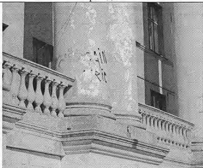
25. Дефекты отделки колонн на парковом фасаде
