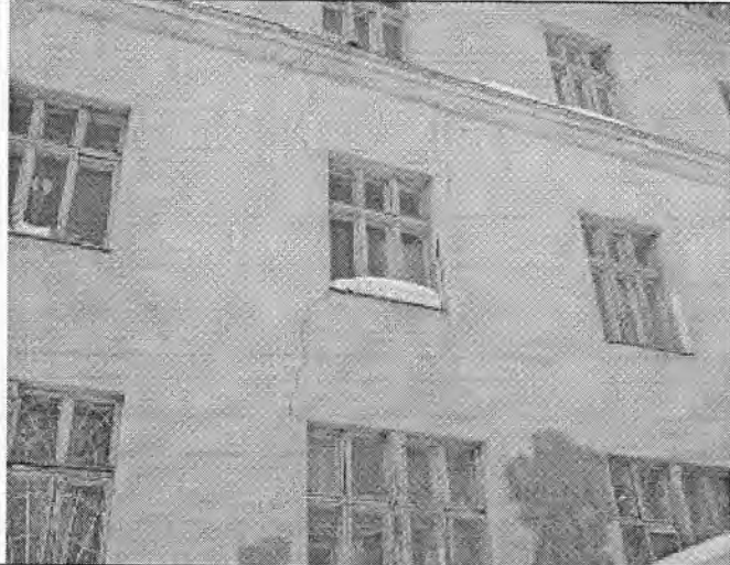
40. Трещины в кладке стены северо-восточного фасада
