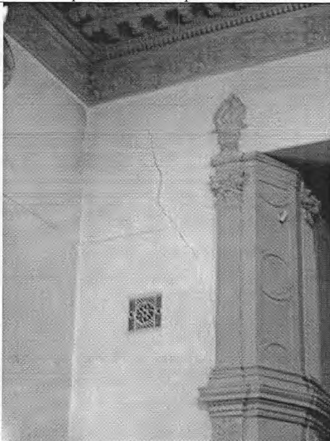
74. Трещина в стене зрительного зала
