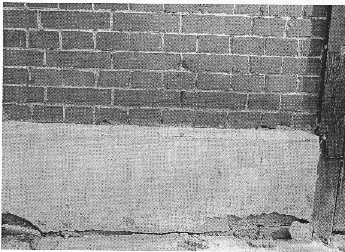
8. Дефекты цоколя юго-западного фасада.
