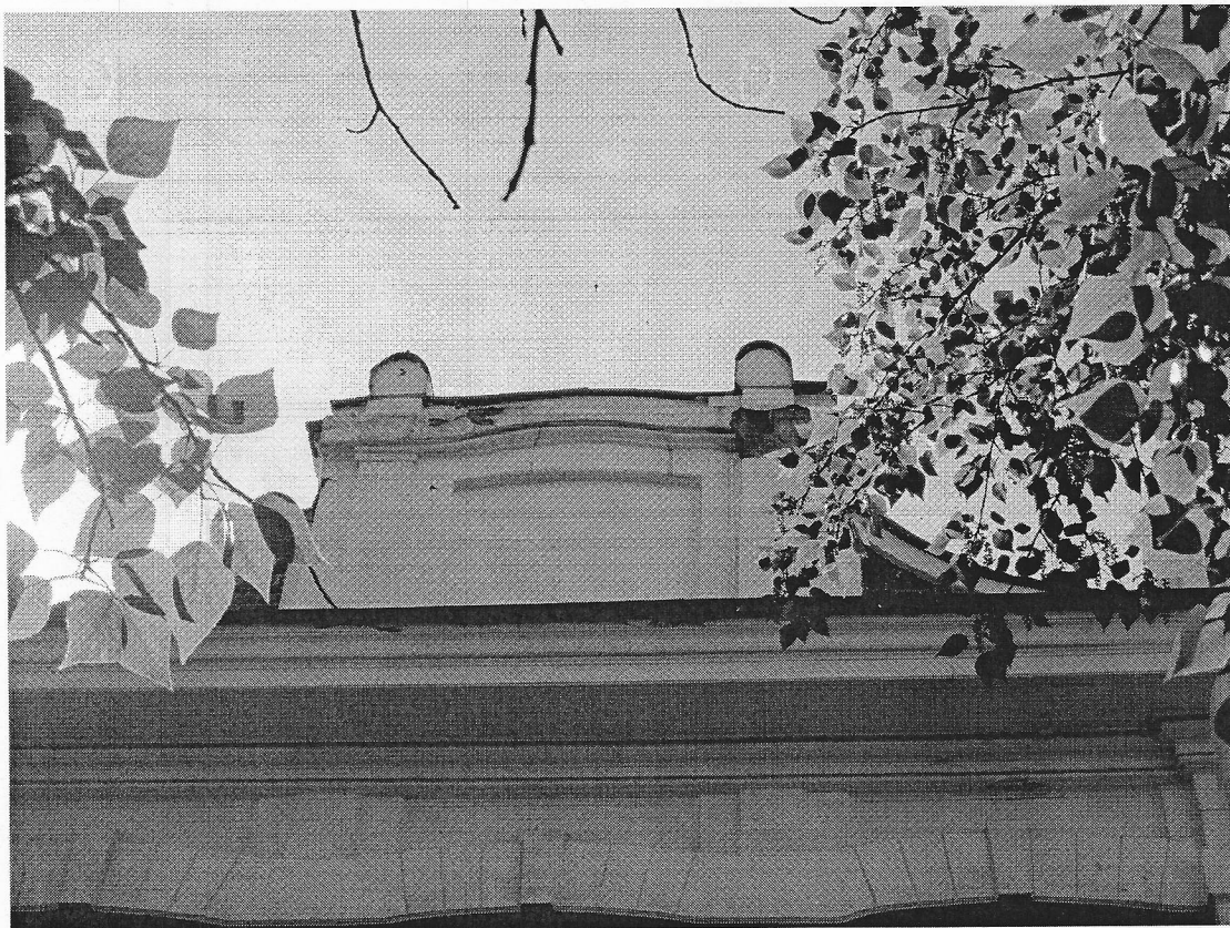
12. Состояние трёхчастного парапета северо-западного фасада.
