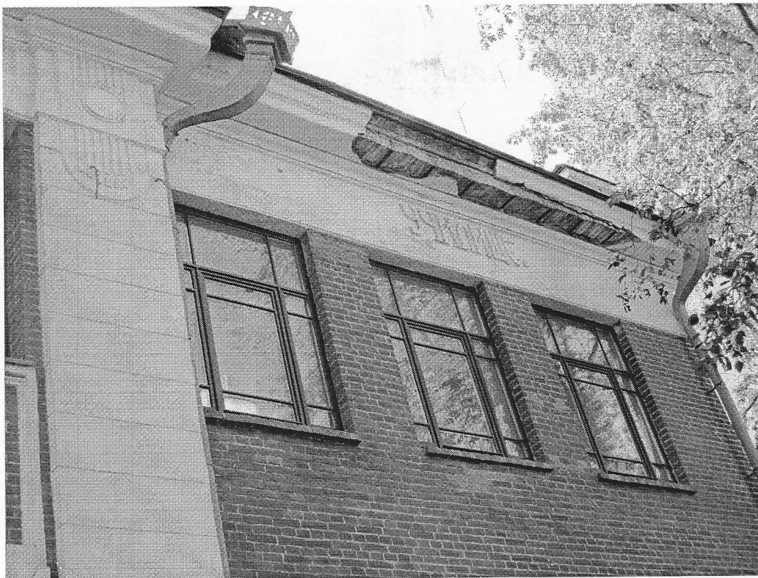
11. Дефекты карниза северо-западного фасада.
