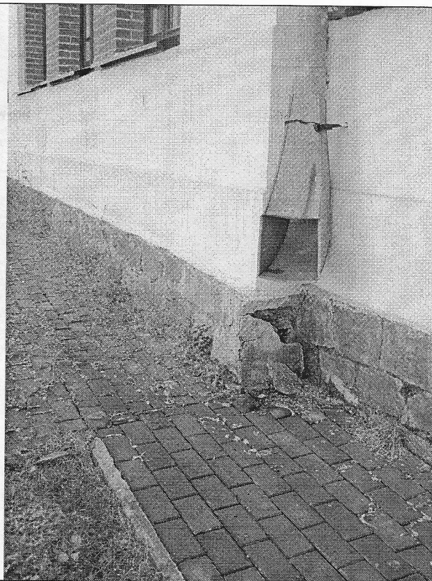
7. Состояние отмостки. Фрагмент выступающей части фундамента со стороны северо-западного фасада.
