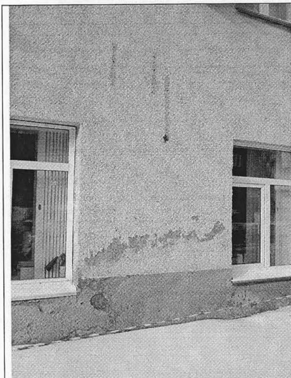
18. Дефекты отделки цоколя и стены.
