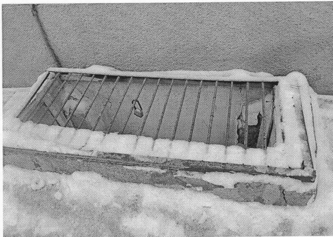
22. Вид приемка восточного фасада с решётчатым покрытием и дефектами отделки стенок.
