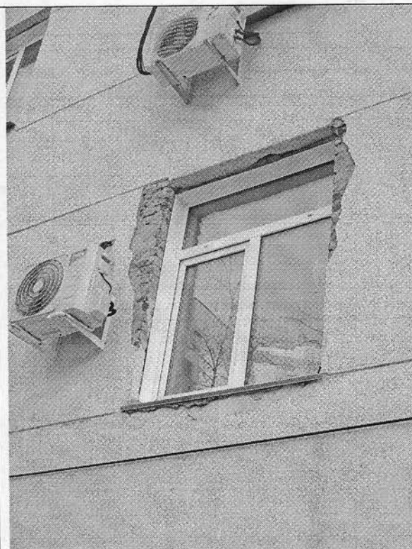
19. Нарушение отделки откосов окон.
