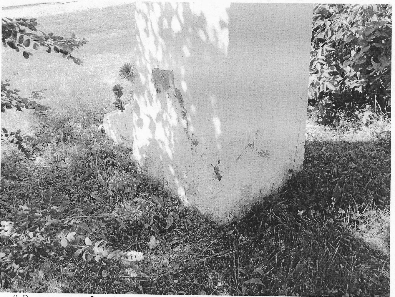
9. Вид основания обелиска с северо-востока. Дефекты отделки.
