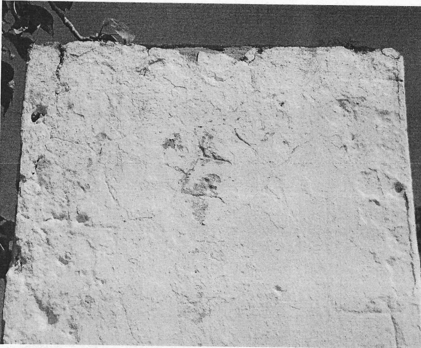
7. Дефекты отделки лицевой (южной) стороны обелиска.
