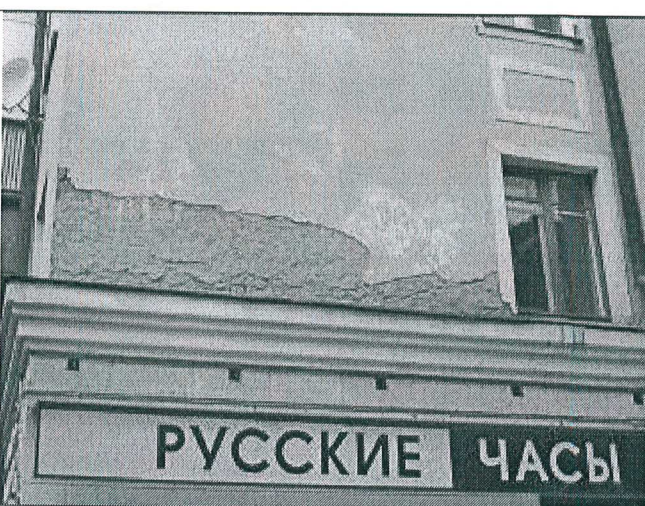
5.30. Дефект отделки южного фасада
