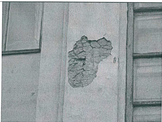
5.29. Дефект отделки ризалита лестничной клетки
