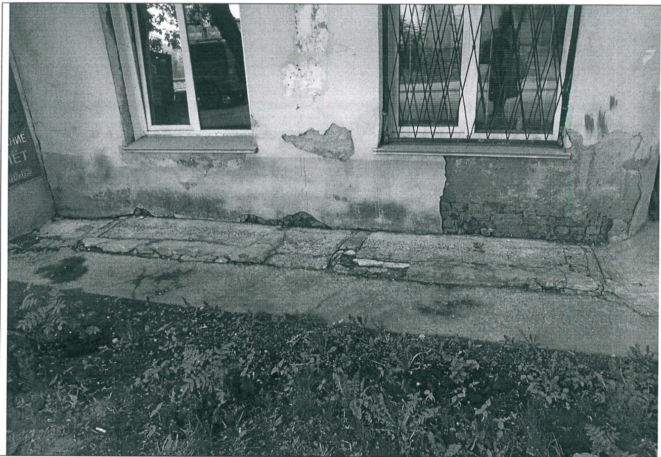
4.13. Фрагмент фасада со стороны ул. Омская. Состояние цоколя и световых приемков.
