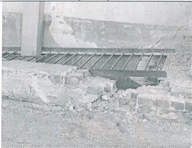
41. Дефекты бортика светового приямка, дворовый фасад
