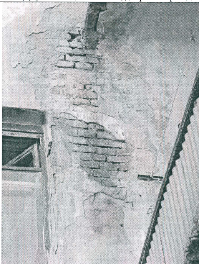
28. Дефекты отделки стены, дворовый фасад
