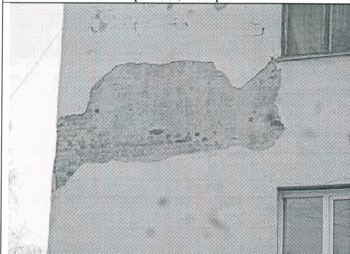
31. Отпадение отделочного слоя на юго-западном фасаде, северный объем
