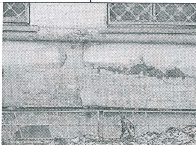
30. Дефекты отделки цоколя, юго-западный фасад
