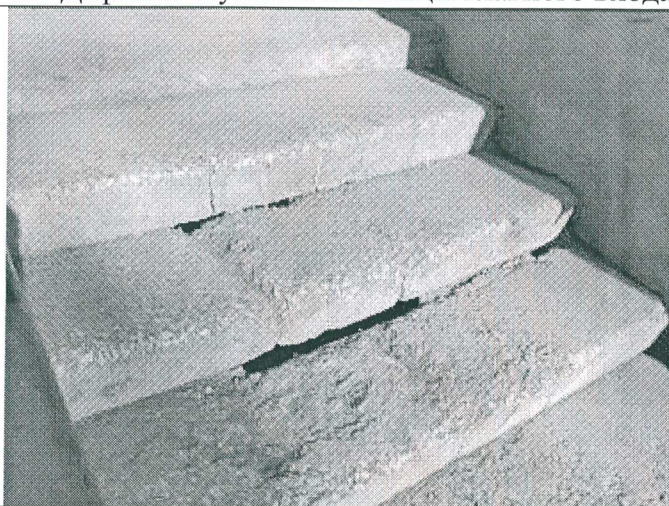
20. Дефекты ступеней лестницы главного входа
