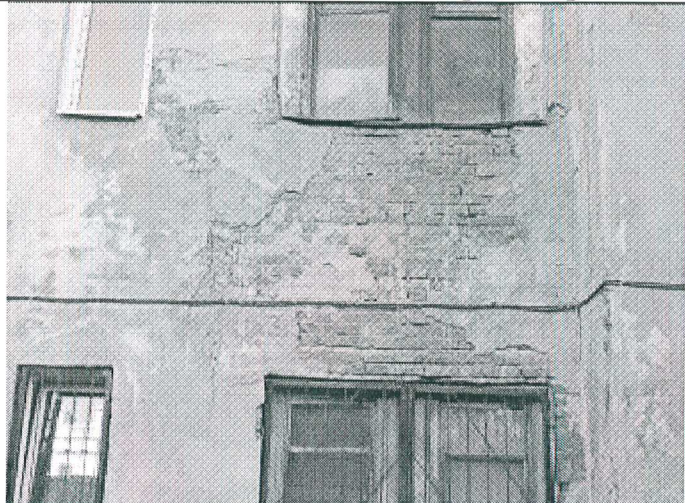
40. Дефекты отделки стен, дворовый фасад
