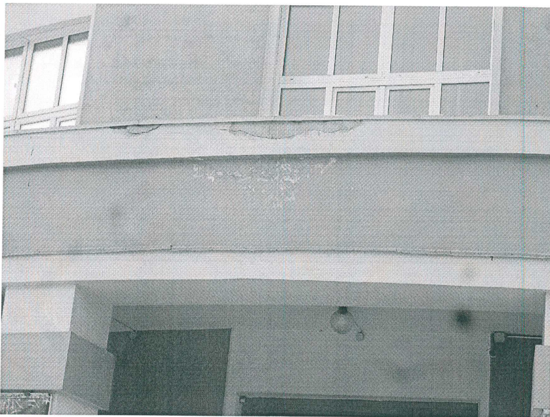
13. Дефекты штукатурного и окрасочного слоёв ограждения балкона 2-ого этажа.
