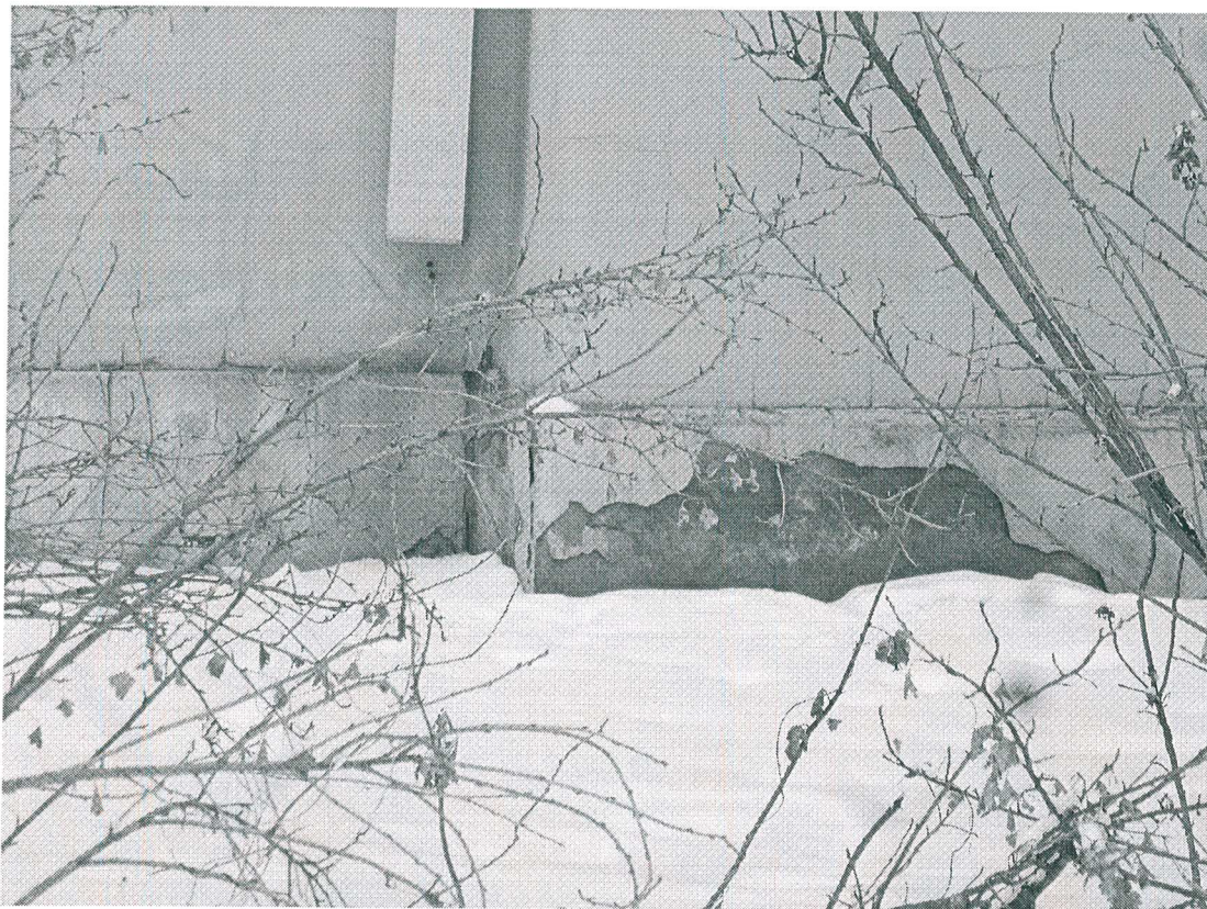
9. Состояние цоколя со стороны главного (южного) фасада.
