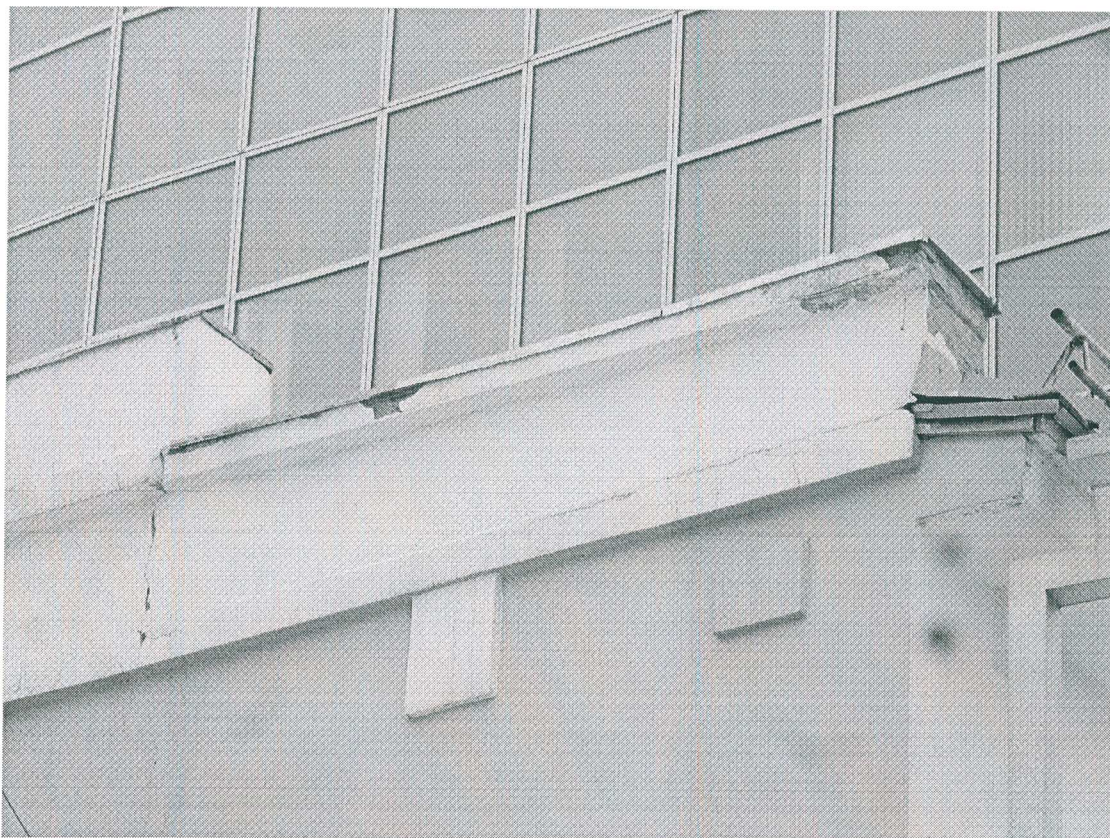
11. Дефекты отделочного слоя парапета северного крыла.
