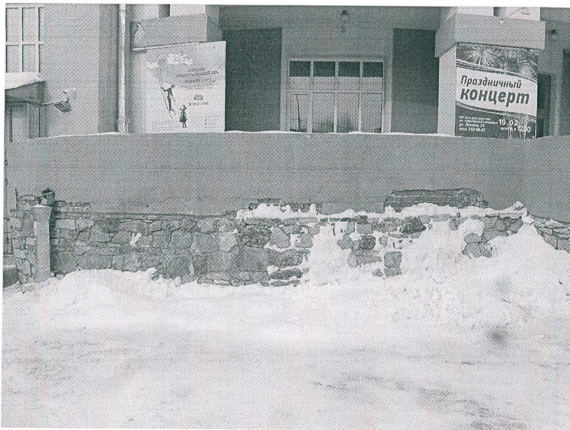
14. Состояние цоколя и ограждения крыльца главного входа.
