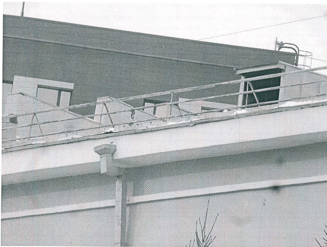
10. Состояние ограждения кровли южного фасада. Слуховое окно.
