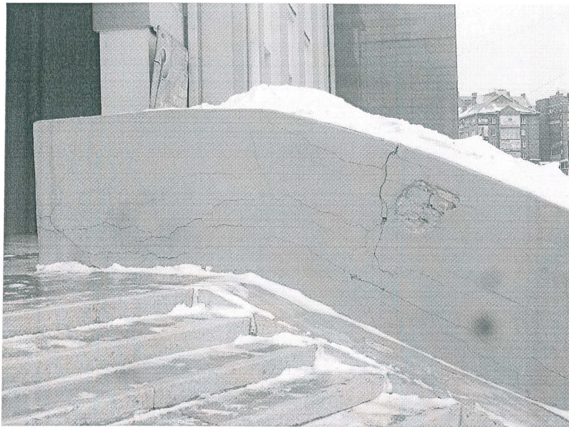
15. Дефекты ограждения крыльца главного входа.
