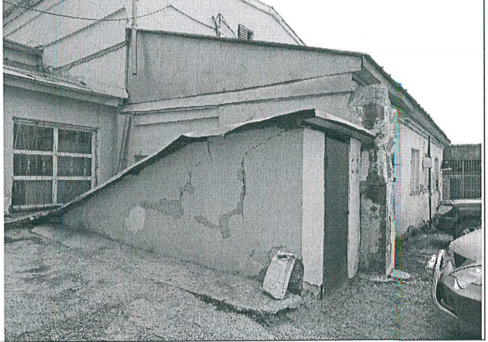
15. Прямо́к спуска в подвал
