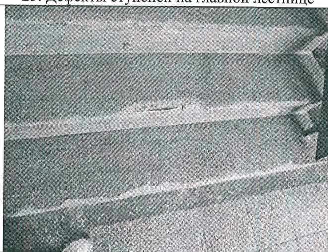
25. Дефекты ступеней на главной лестнице
