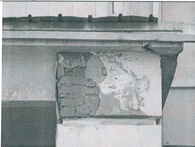
32. Дефекты отделки колонны главного входа
