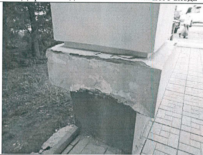
33. Дефекты отделки колонны главного входа
