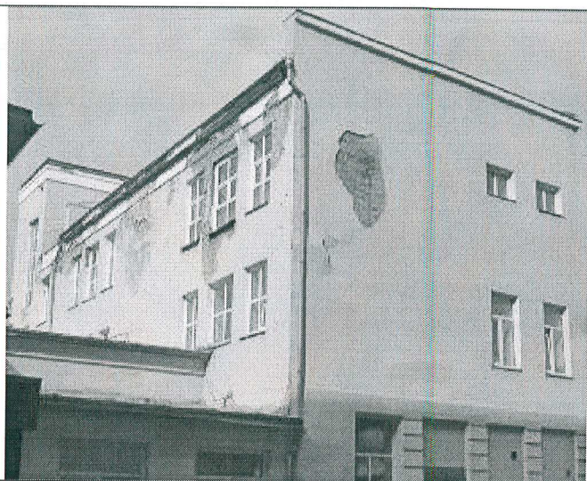
31. Дефекты отделки стен в восточном объеме
