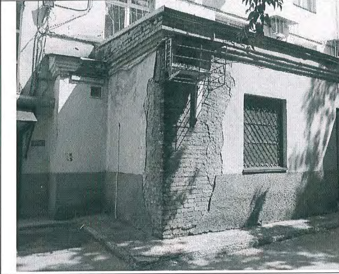
45. Дефекты отделки стен пристройки на дворовом фасаде
