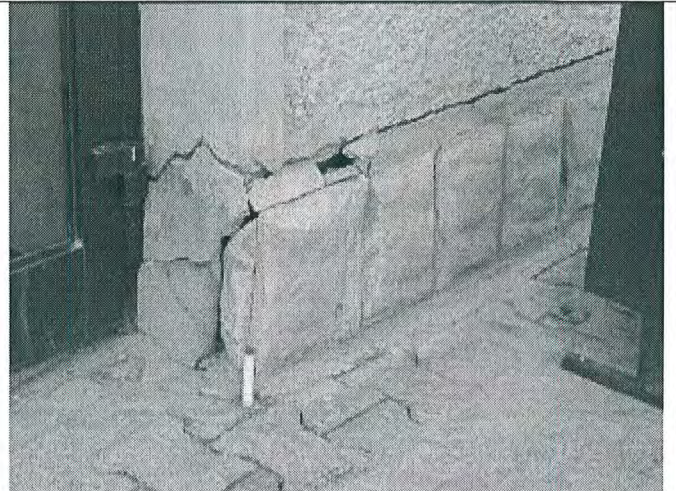
44. Дефекты отделки цоколя на главном фасаде
