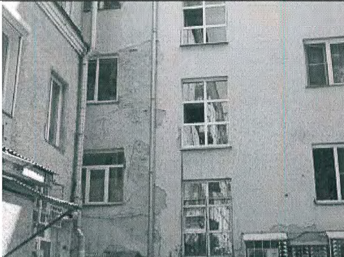
42. Дефекты отделки стен дворового фасада
