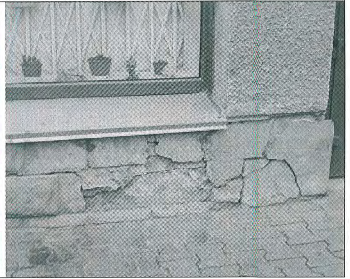
46. Дефекты отделки цоколя на главном фасаде
