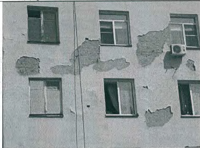
41. Дефекты отделки стен дворового фасада
