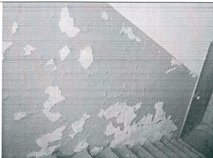
32. Дефекты отделки стен в помещении южной лестничной клетки
