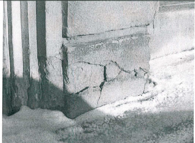
5.32. Дефекты цоколя на главном фасаде
