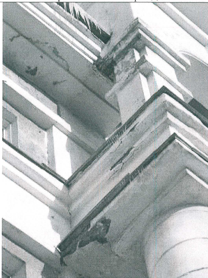
5.25. Дефекты на элементах второго яруса портика на главном фасаде
