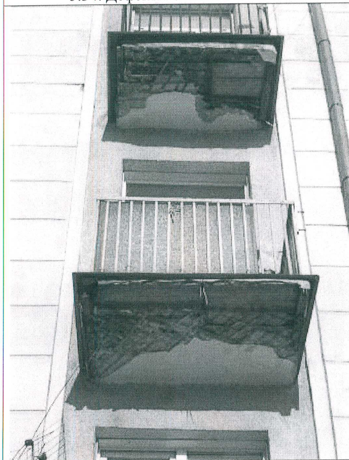
5.34. Дефекты балконных плит
