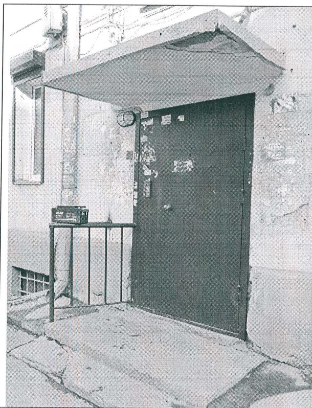
12. Вход в подъезд. Дефекты отделки козырька.
