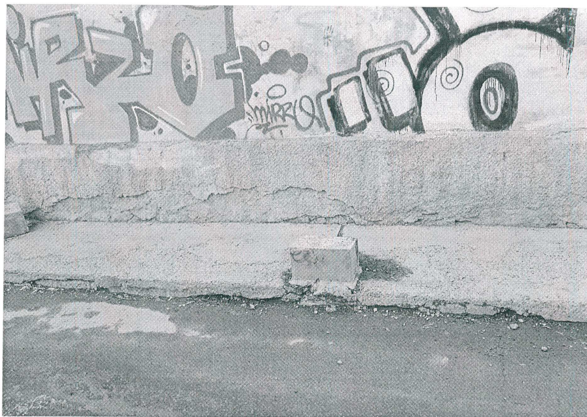
5. Состояние цоколя и отмостки южного фасада.
