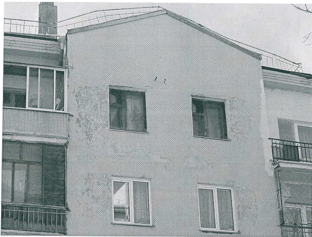
8. Дефекты отделки стены восточного фасада.
