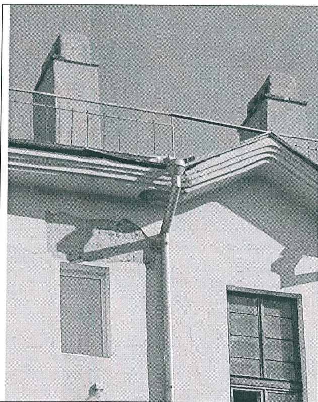
9. Нарушение отделочного слоя карниза и стены западного фасада. Дефект ограждения кровли.
