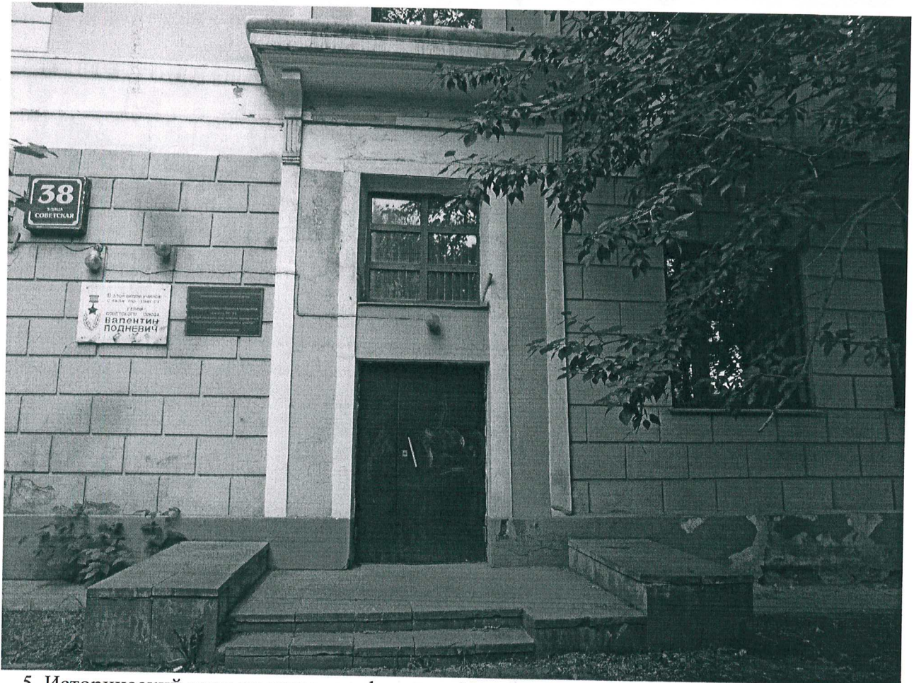
5. Исторический вход на западном фасаде. Утрата первоначальной двери.
