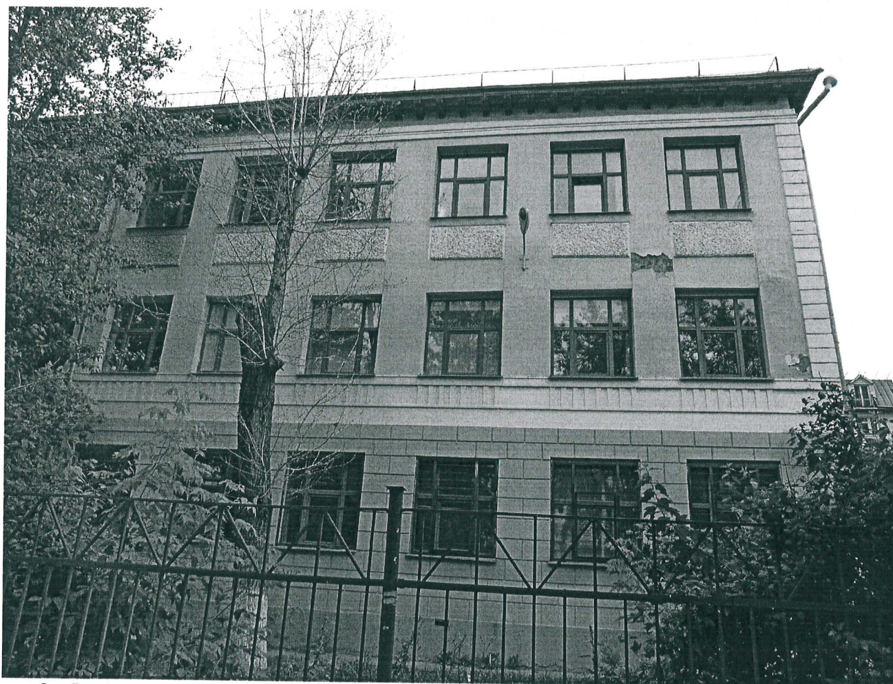
2. Фрагмент западного фасада (южная часть). Дефекты отделки стен.
