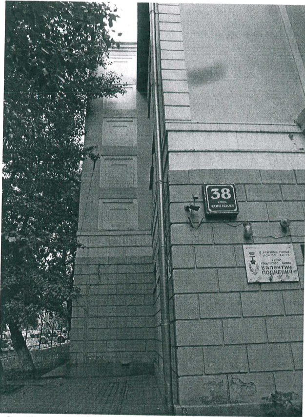
3. Фрагмент западного фасада (северный угол). Дефекты отделки стен.
