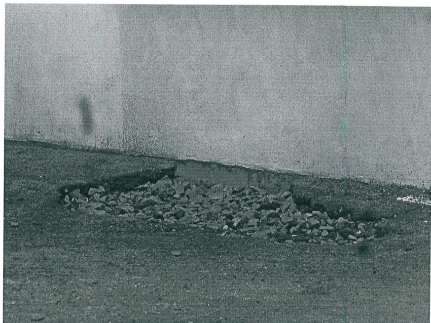
13. Дефект покрытия двора в зоне восточного фасада.
