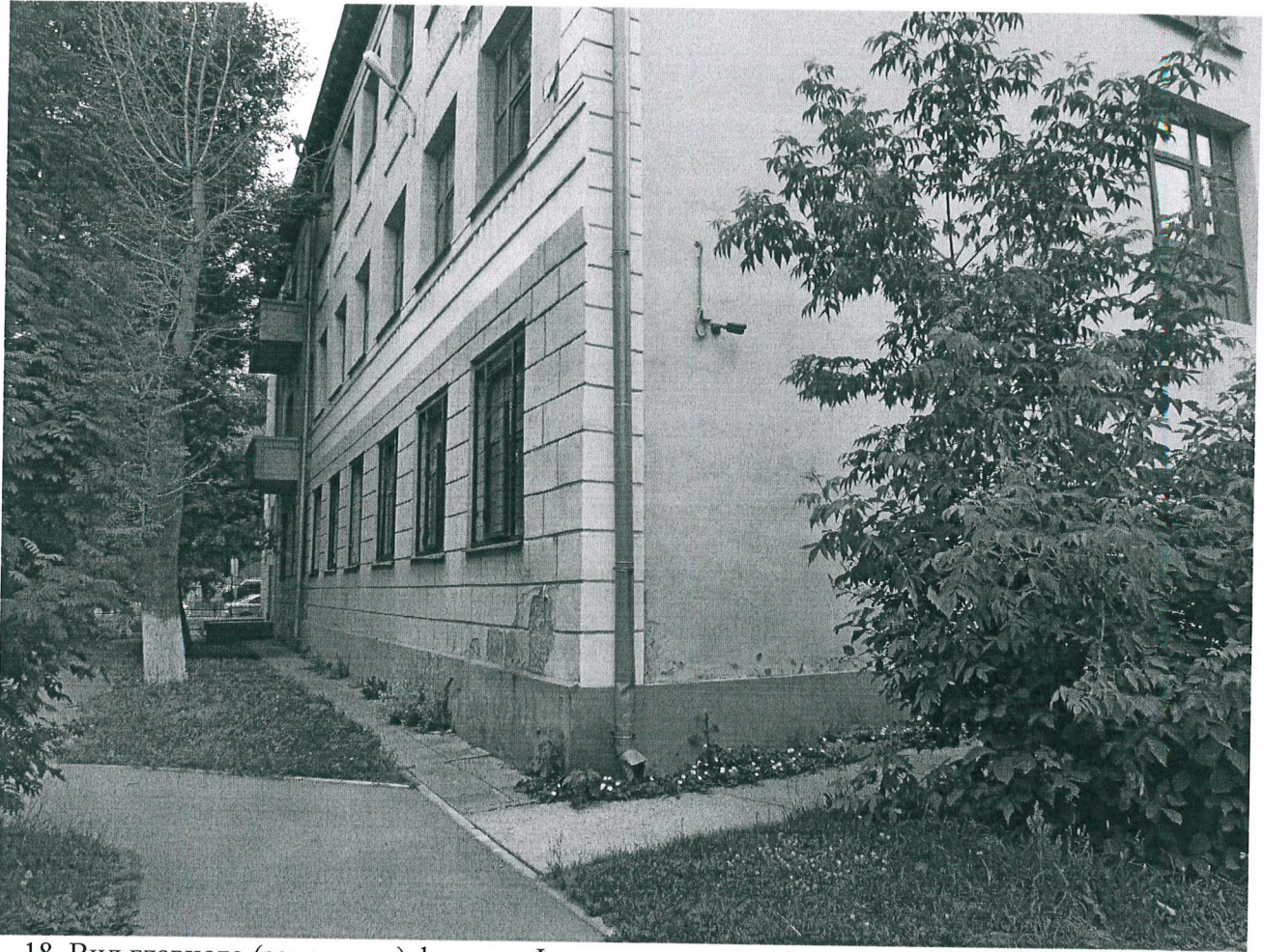
18. Вид главного (западного) фасада. Фрагмент южного (торцевого) фасада. Дефекты отмостки и отделки стен.
