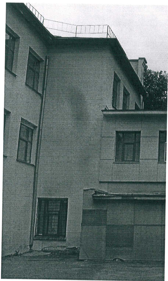
15. Фрагмент южного (дворового) фасада. Утрата проемов 2 и 3 го этажей и элементов водосточного стояка.
