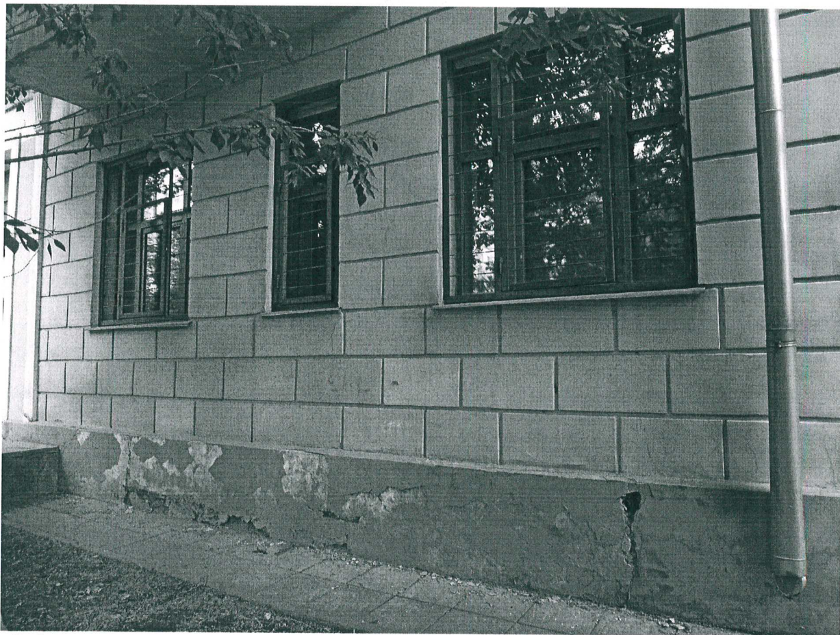
6. Фрагмент западного фасада (центральная часть): дефекты цоколя и водосточной трубы.
