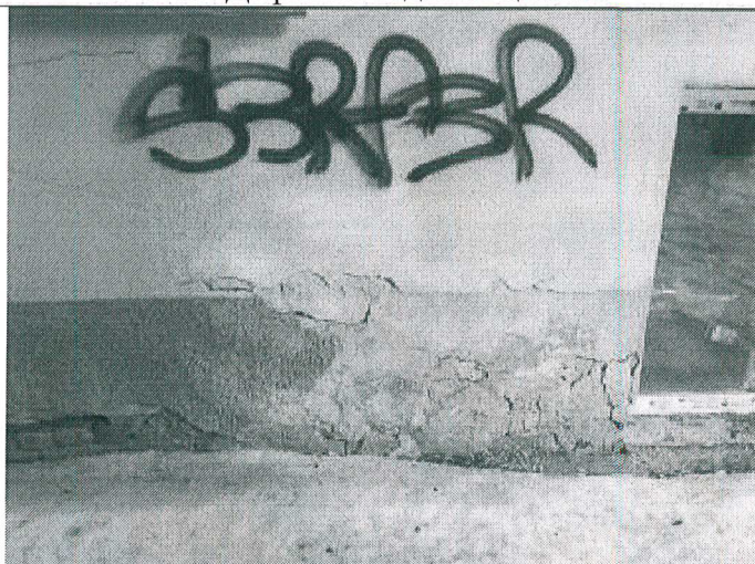
5.13. Дефекты отделки цоколя
