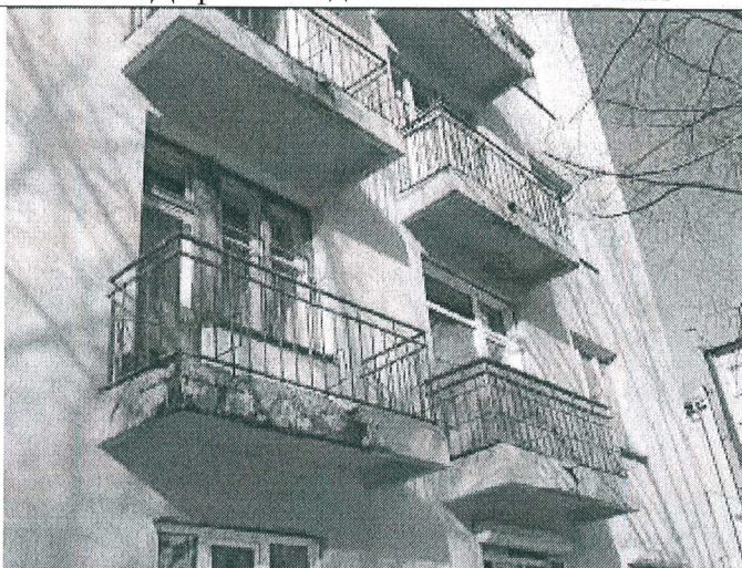
5.17. Дефекты отделки балконных плит
