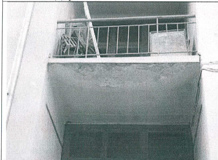
5.16. Дефекты отделки плит лоджий
