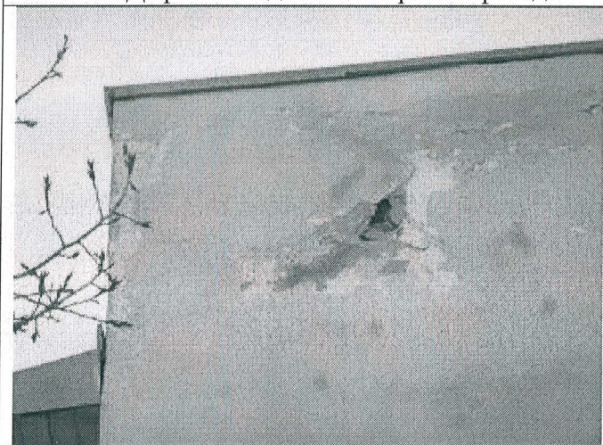
5.14. Дефекты отделки северного фасада
