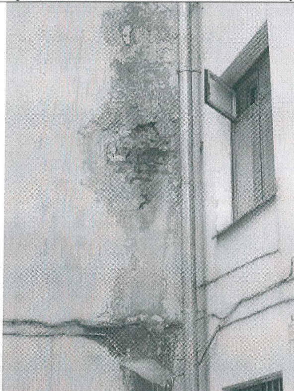
5.18. Дефекты отделки фасада, угол примыкания позднего объема к основному
