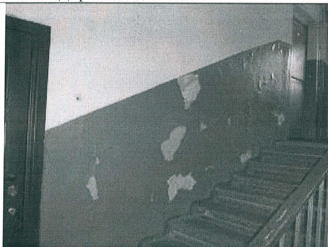
5.20. Дефекты отделки лестничной клетки
