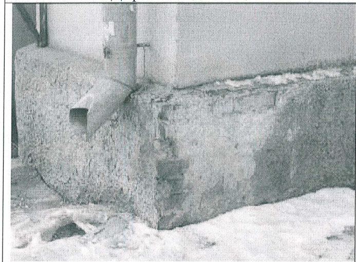
5.12. Дефекты отделки цоколя
