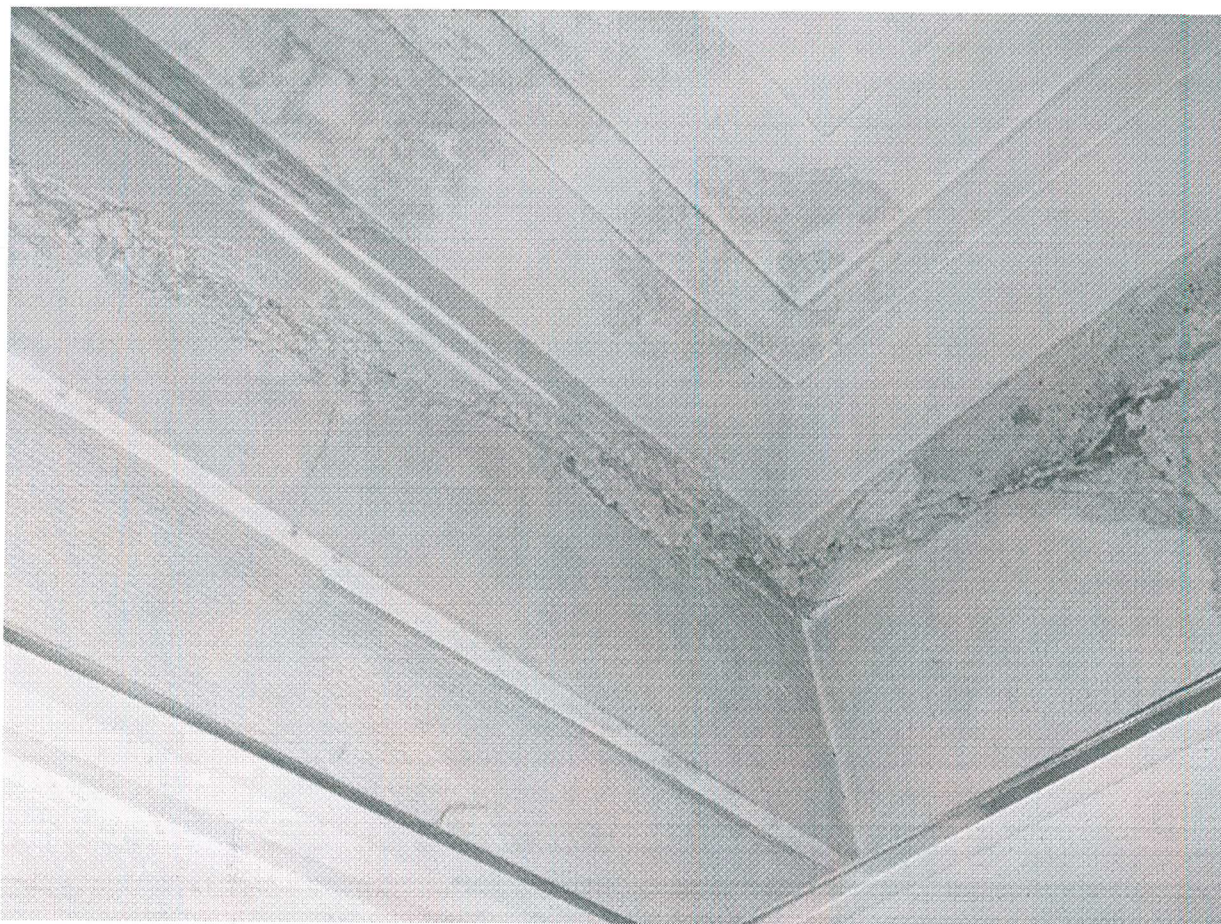
38. Фрагмент перекрытия 3 этажа. Предмет охраны: декор. Трещины в наружных стенах.
