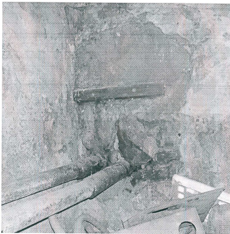
45. Следы замачивания наружной стены южной лестничной клетки.
