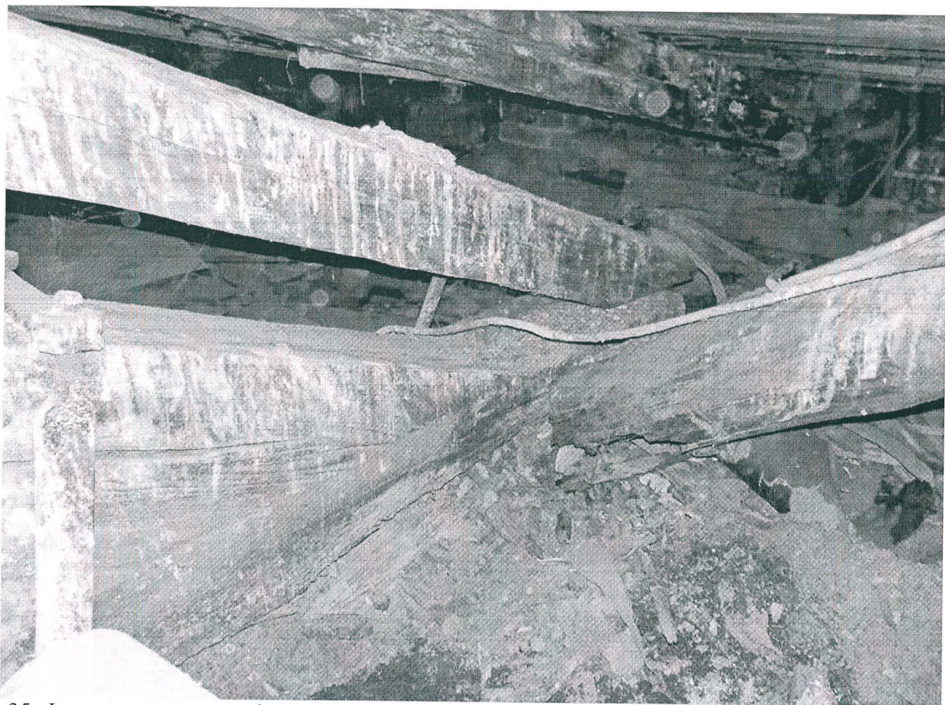
35. Фрагмент чердака: дефекты опоры стропильной фермы.
