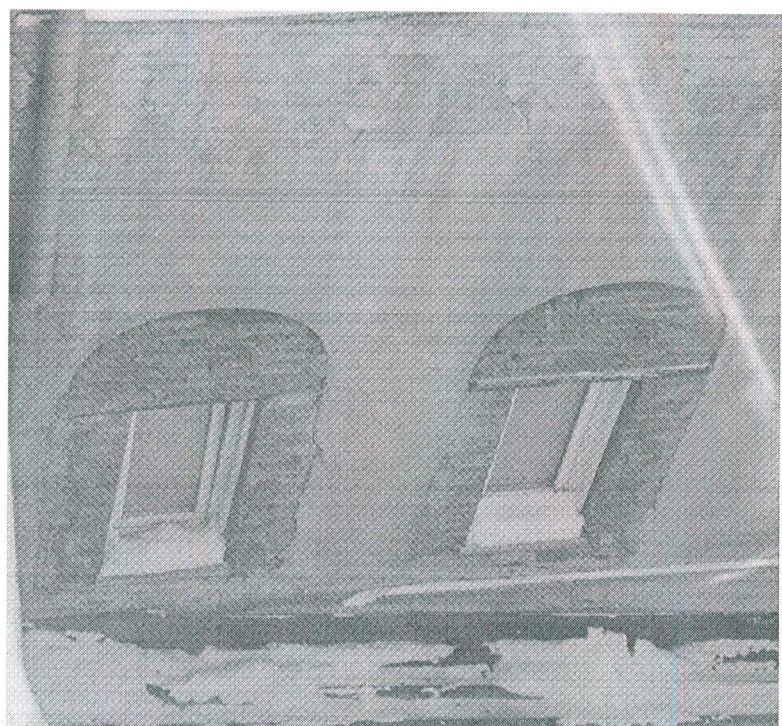
9. Утрата исторических окон северного фасада.
