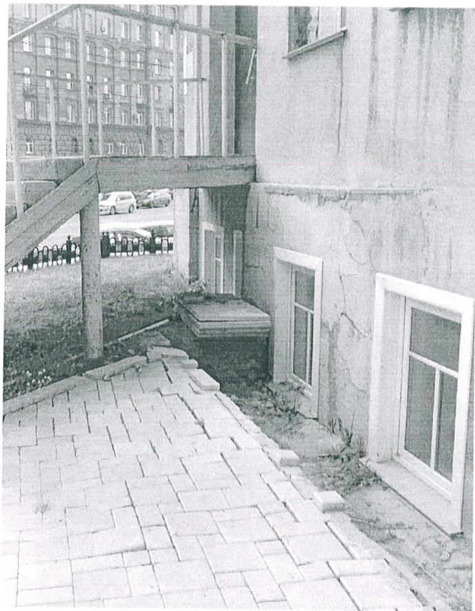
19. Дефекты приемки и цоколя южного фасада.
