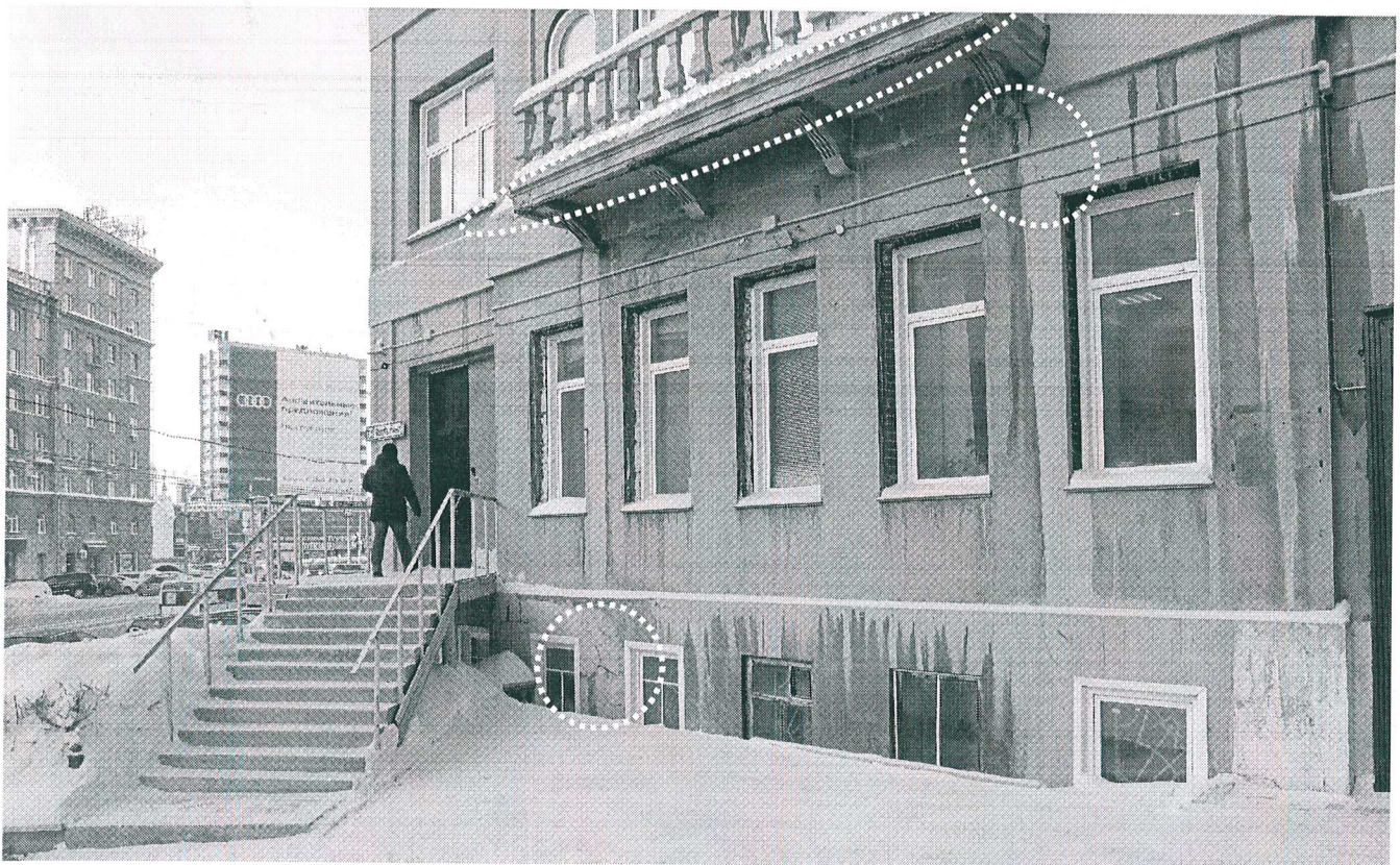
18. Фрагмент южного фасада. Дефекты кладки и отделки.
