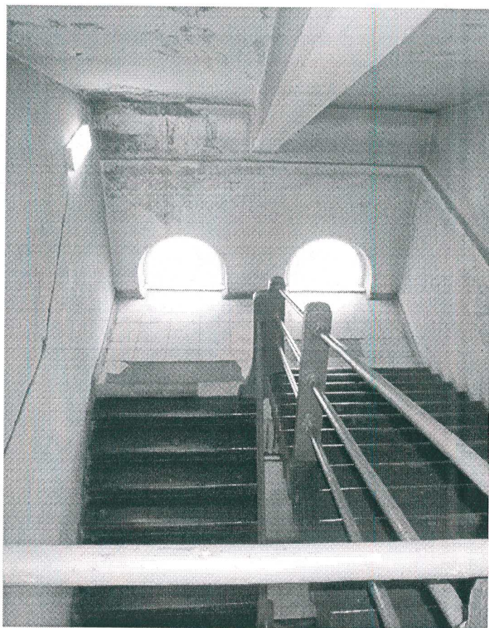
43. Протечки над междуэтажной площадкой северной лестничной клетки.
