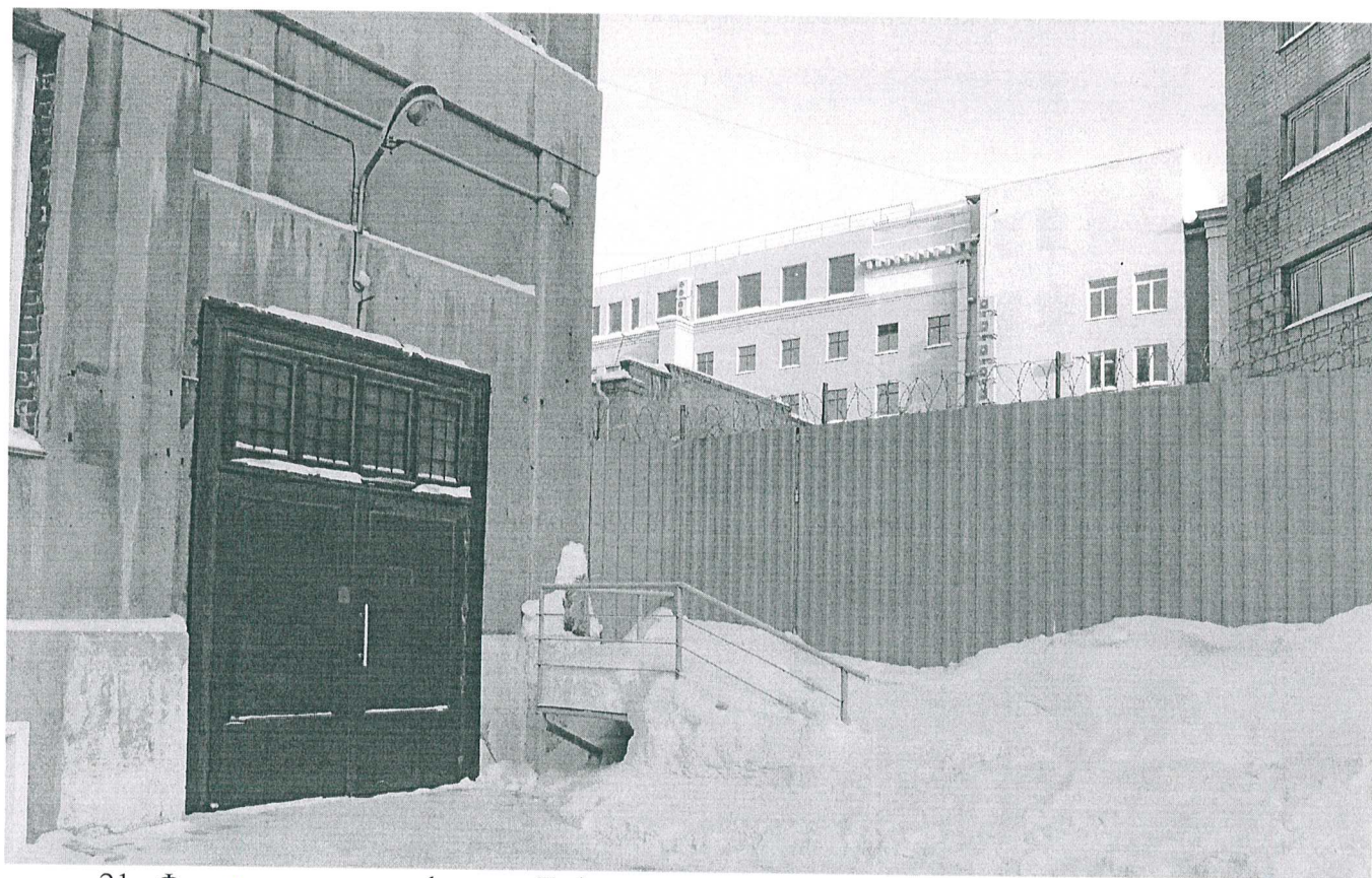
21. Фрагмент южного фасада. Дефекты отделки.
