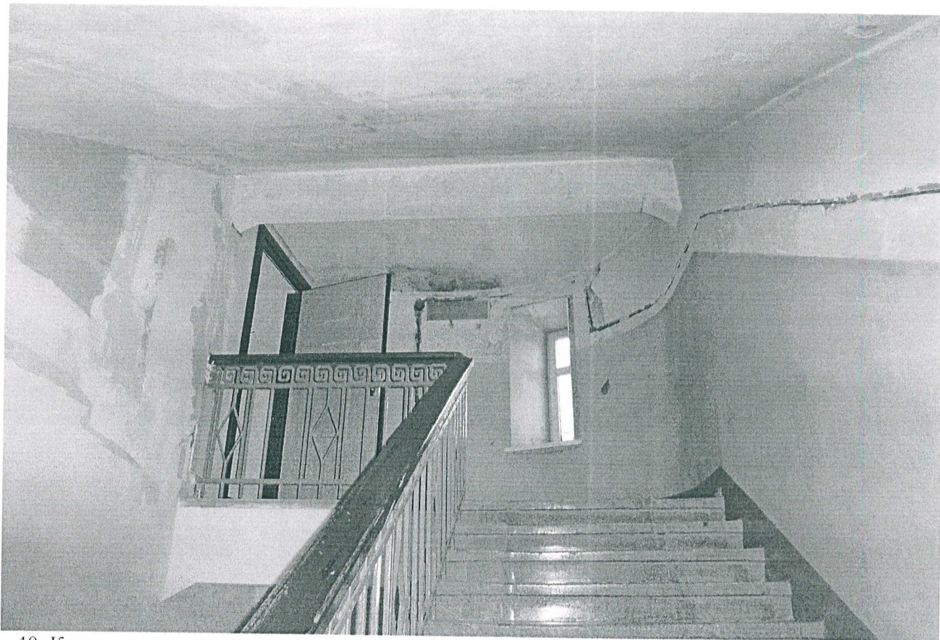
40. Конструкция покрытия южной лестничной клетки: протечки над верхней площадкой.
