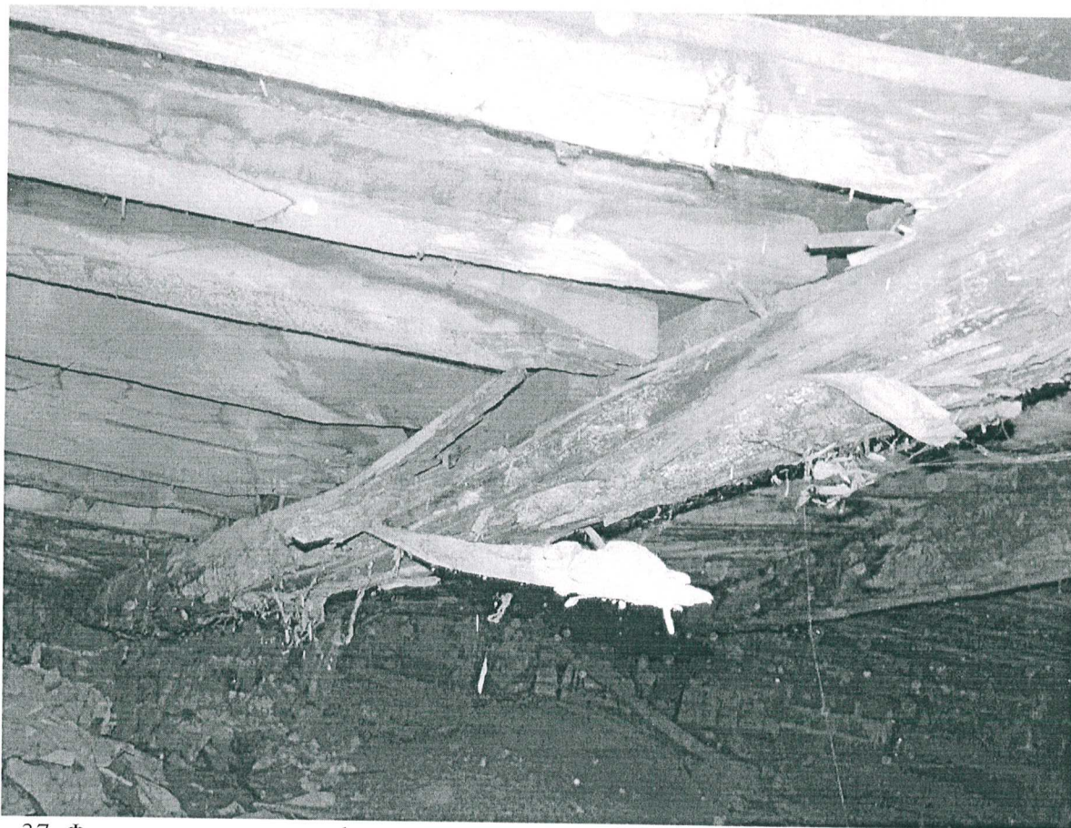
37. Фрагмент чердака: дефекты конструкции в зоне ендовы.
