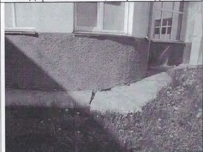
32. Дефекты отмостки, северный курдонер
