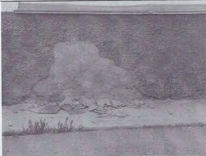
31. Отпадение отделочного слоя на цоколе юго-западного фасада
