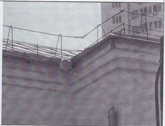
37. Дефекты системы водостока
