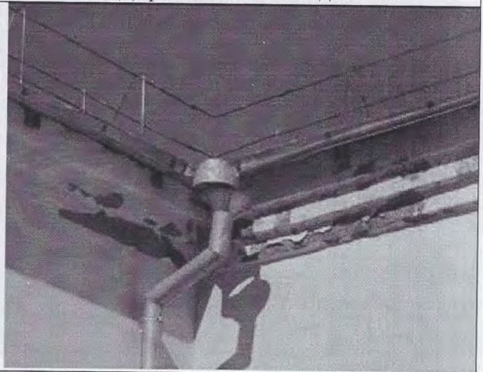
39. Дефекты системы водостока
