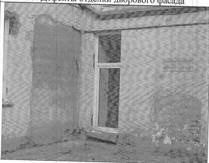
35. Дефекты отделки дворового фасада
