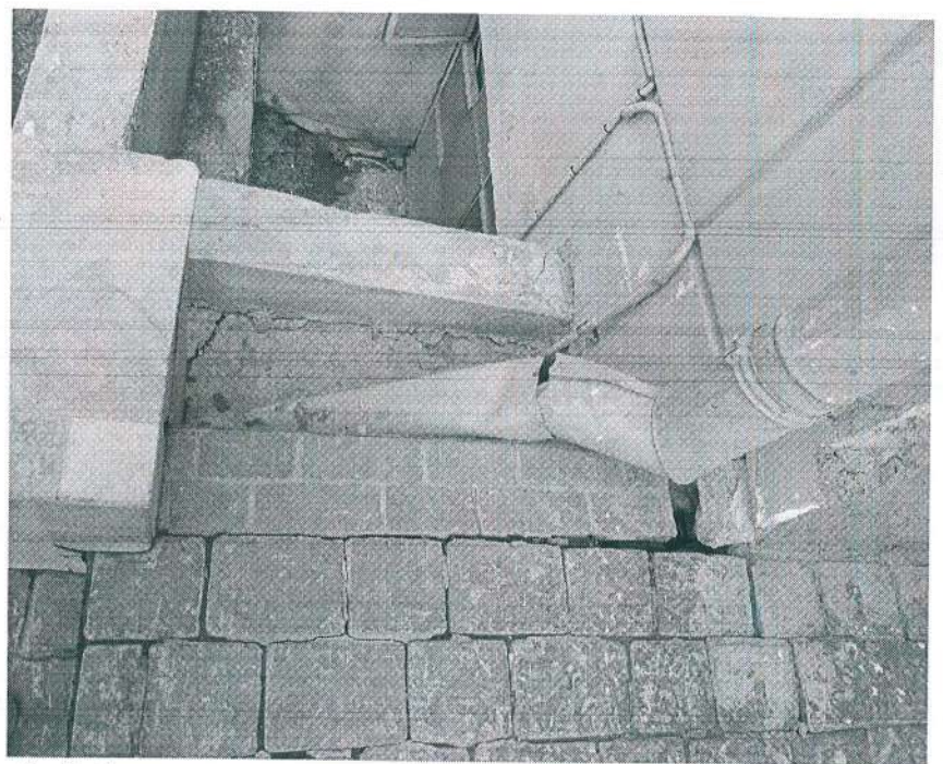
9. Деформация крыльца в примыкании к водостоку.
