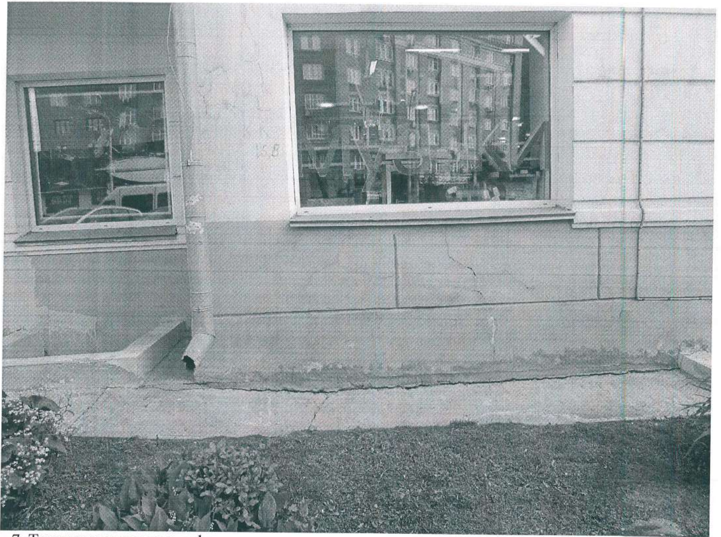
7. Трещины в цоколе и деформация отмостки в зоне осадки.
