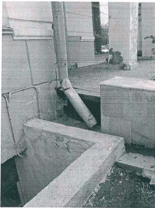
8. Осадка конструкции приямка.
