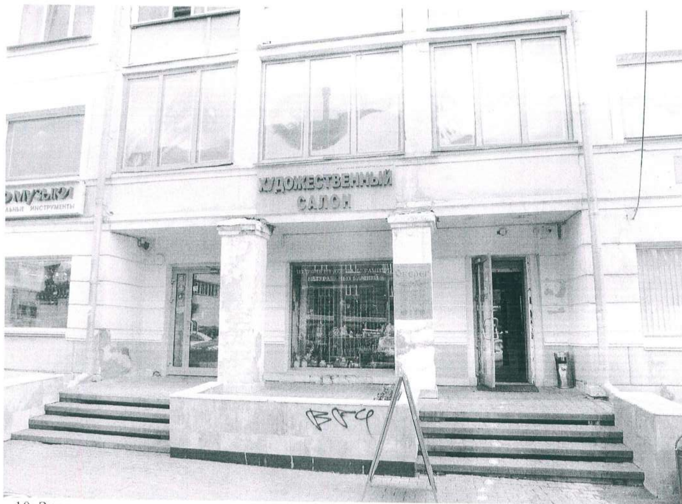
10. Зона осадки колонн на северо - западном фасаде.
