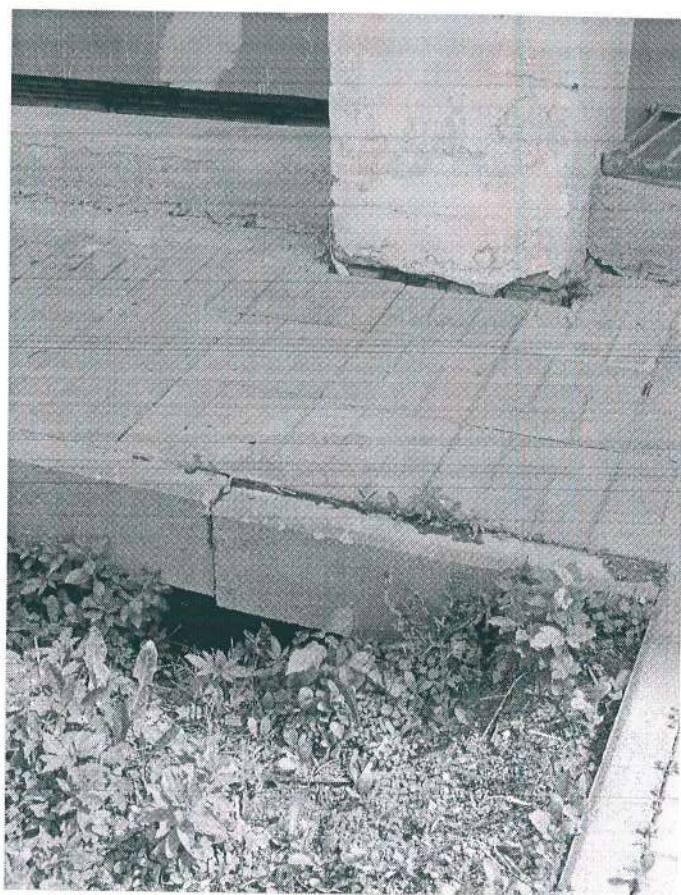
15. Деформация отмостки в зоне осадки.
