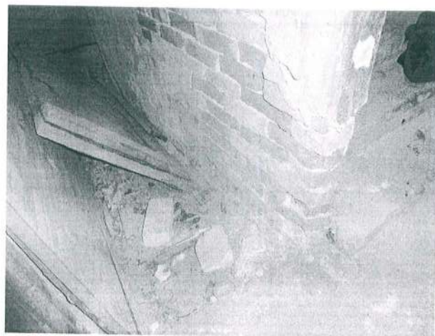
62. Дефекты перегородки в подвале.
