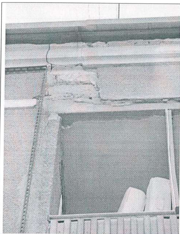
7. Дефекты штукатурки стены северного фасада крыла-пристройки.
