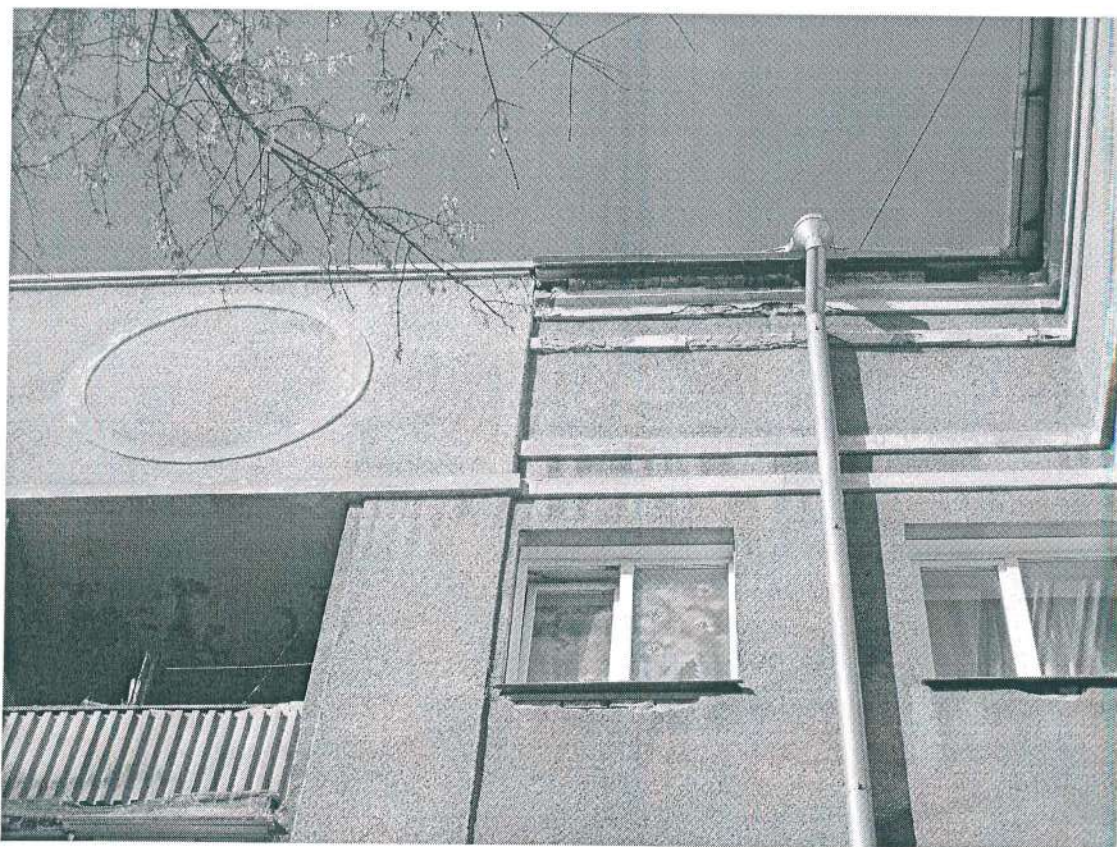
11. Дефекты отделки декоративных элементов.
