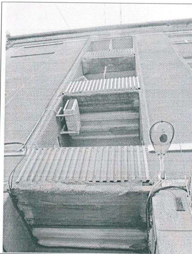
13. Разрушение плит лоджий.
