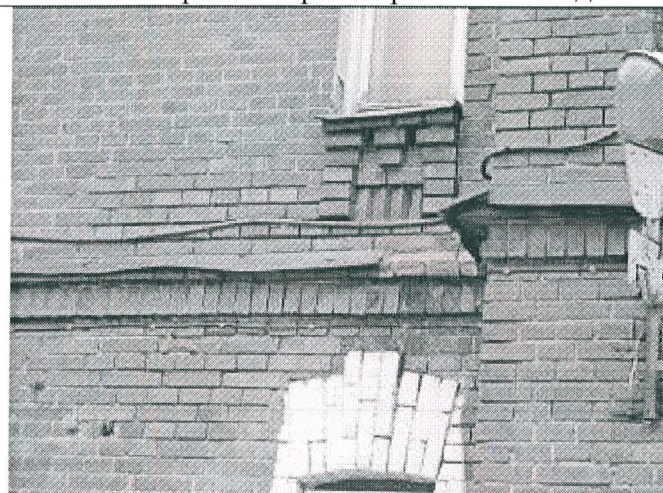
22. Выветривание раствора в швах кладки
