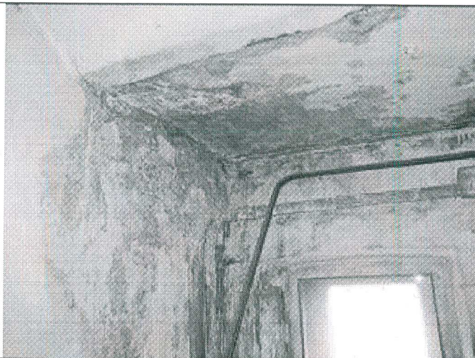
15. Следы протечек на потолке лестничной клетки
