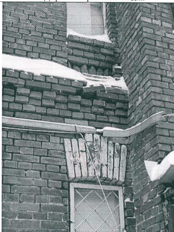
14. Дефекты кирпичной кладки
