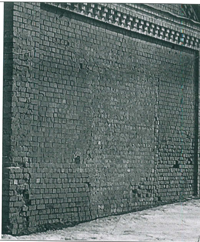
11. Фрагмент юго-западного фасада. Утраченный входной проем (фото 2006 г.)
