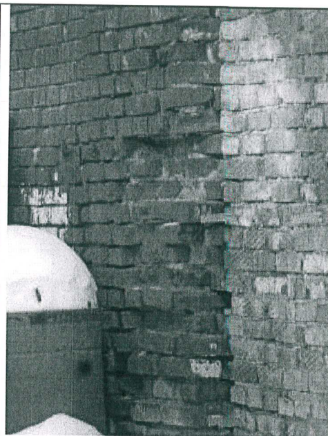
7. Фрагмент юго-западного фасада. Эрозия кладки.
