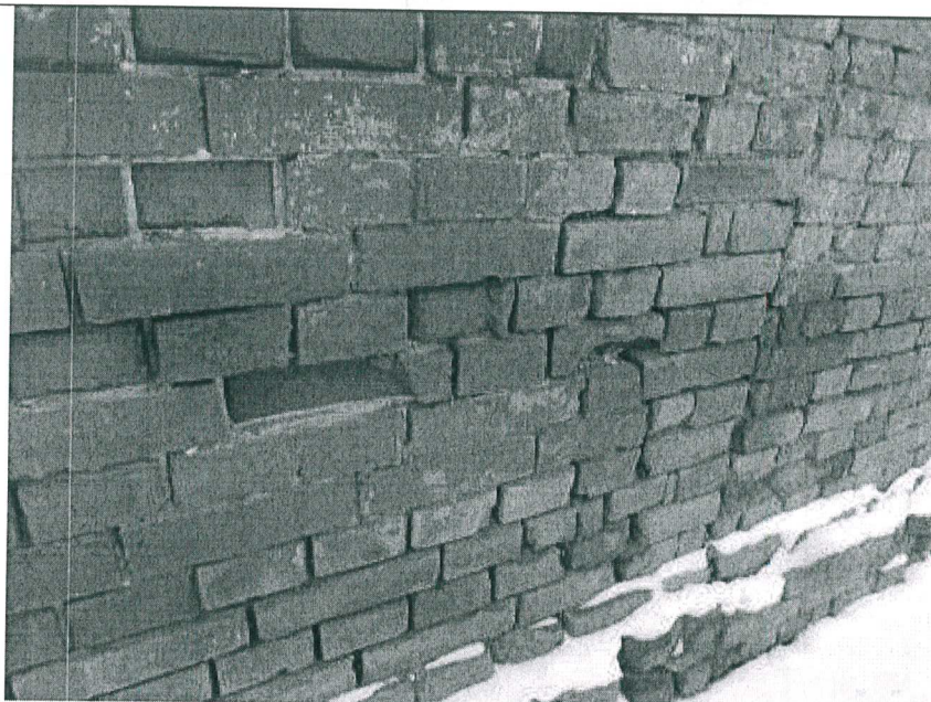
6. Фрагмент северо-восточного фасада. Эрозия кладки.
