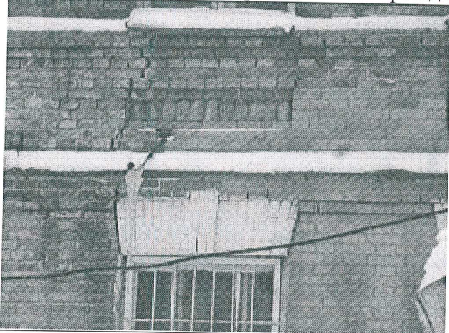
23. Трещина в стене северо-восточного фасада
