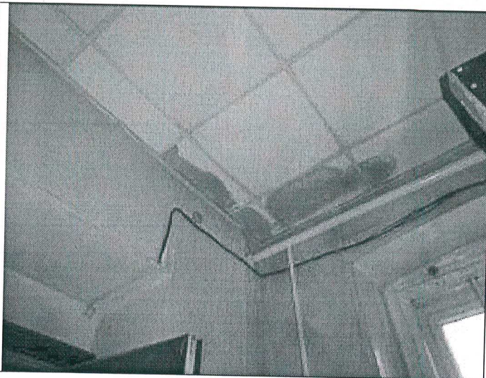
28. Следы протечек на потолках второго этажа
