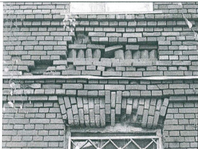
5.18. Дефекты кладки стены
