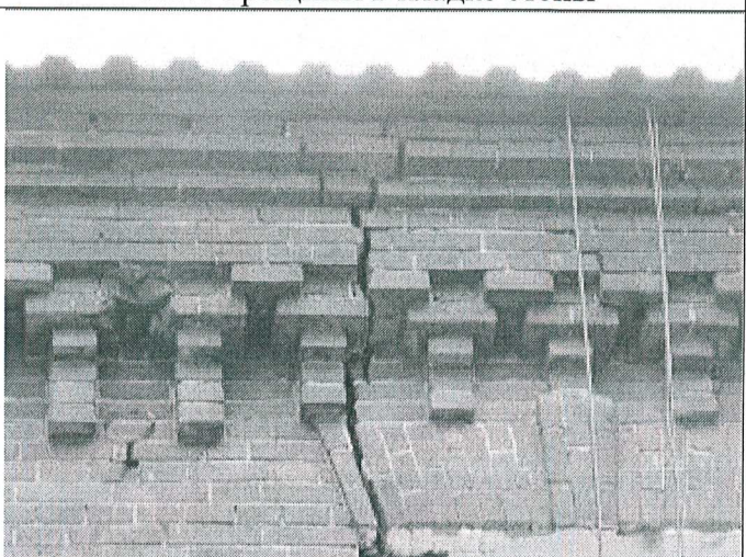
5.17. Трещины в кладке стены
