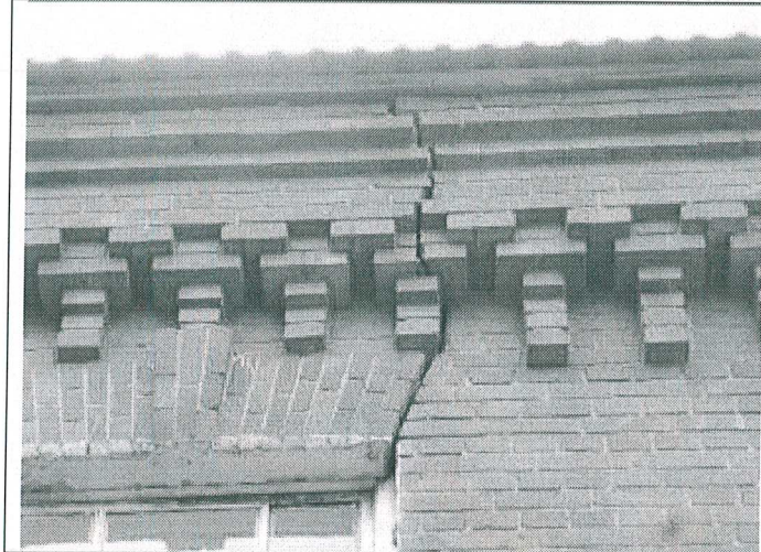
5.12. Фрагмент северо-западного фасада. Трещины в кладке стены
