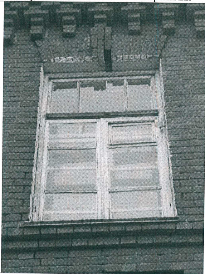
5.15. Первоначальное окно. Выпадение кирпича из замкового камня перемычки
