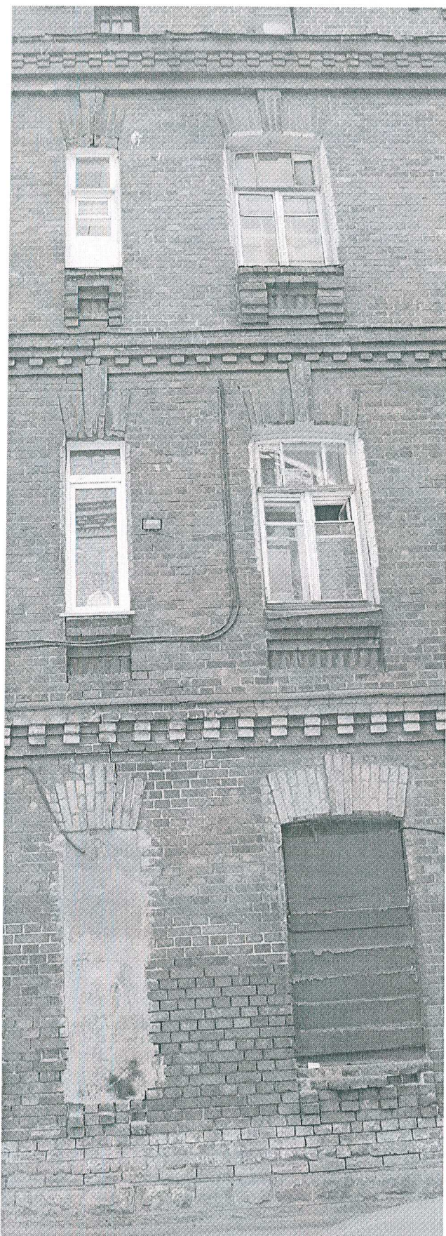
17. Фрагмент торцевого (юго-западного) фасада. Утрата проемов. Дефекты кладки.
