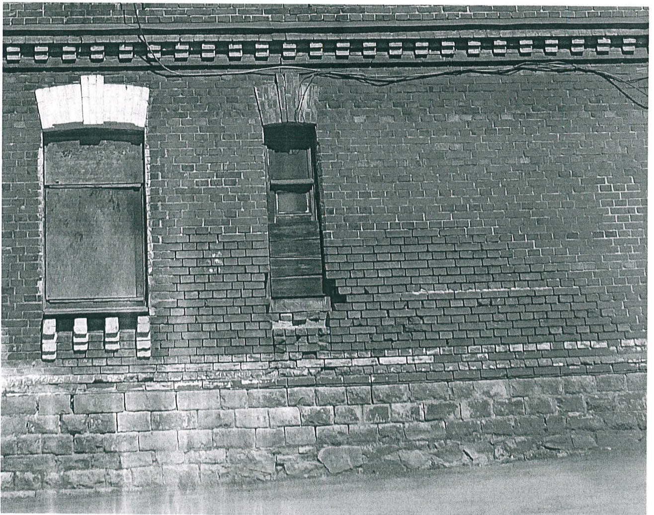
16. Фрагмент торцевого (юго-западного) фасада. Дефекты кладки. Утрата заполнений оконных проемов.
